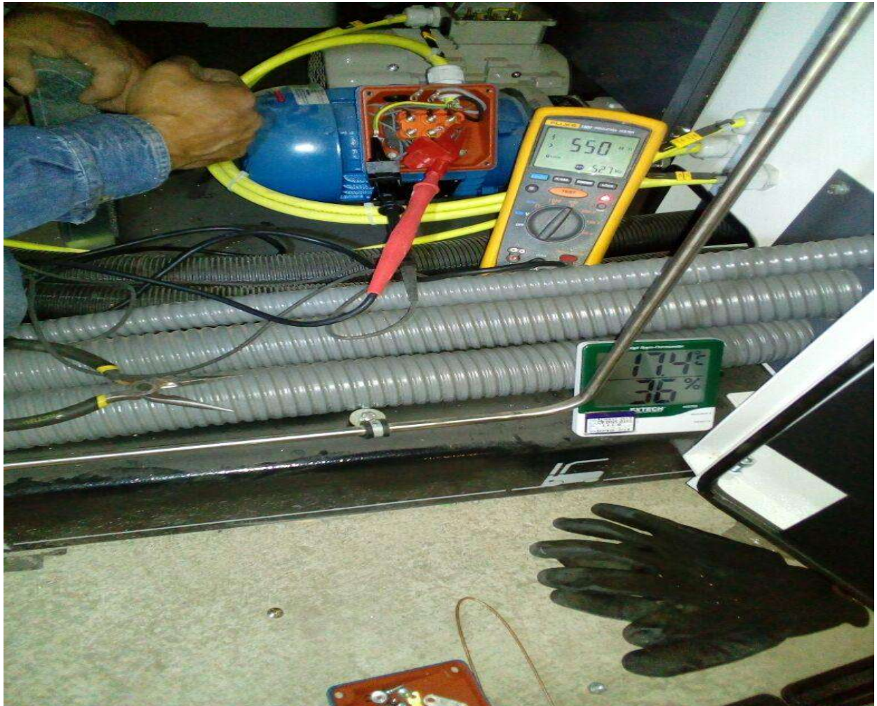
Figura 29.- Pruebas de resistencia de aislamiento a cables y maquinas eléctricas trabajo constructivo.
