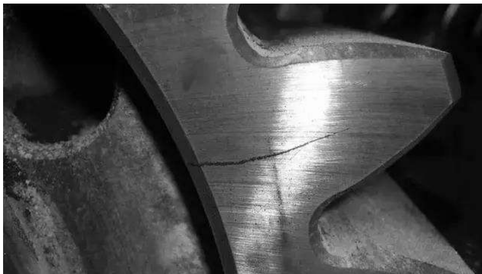
Fig. 6 Grieta identificada en superficie metálica. (tomada de: https://www.graco.com/es/es/contractor/solutions/articles/detecting-defects-in-steel-during-surface-preparation.html .)
