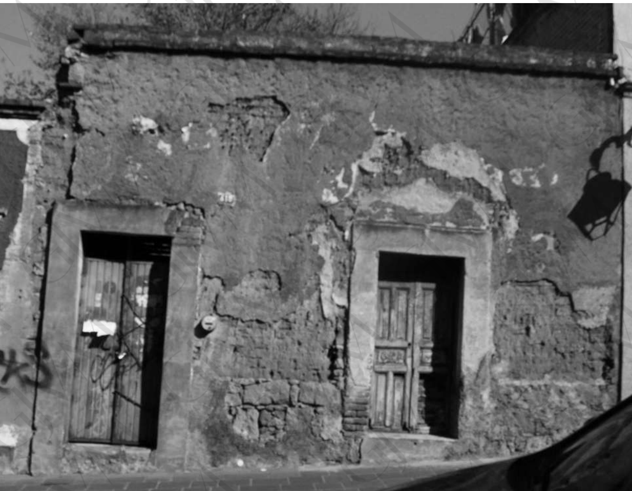
Imagen 30. Vivienda Deteriorada, ubicada en Sector República. Fuente: Grecia Vargas
