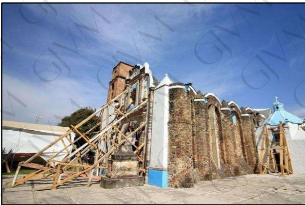
Imagen 14-15. Edificios en colapso sismo 2017 Fuente: https://www.trespm.mx/cultura/restaura-inah-mas-de-mil-monumentos-historicos-danados-por-el-sismo-del-2017
