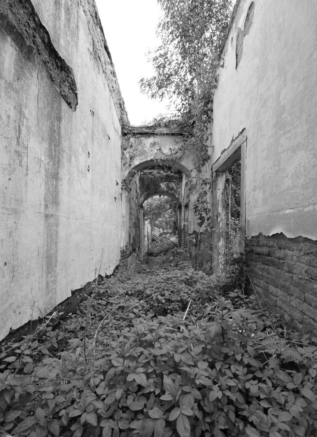
Imagen 1. Interior de vivienda colapsada, ubicada en Sector Revolución. Foto tomada por: Grecia Vargas
