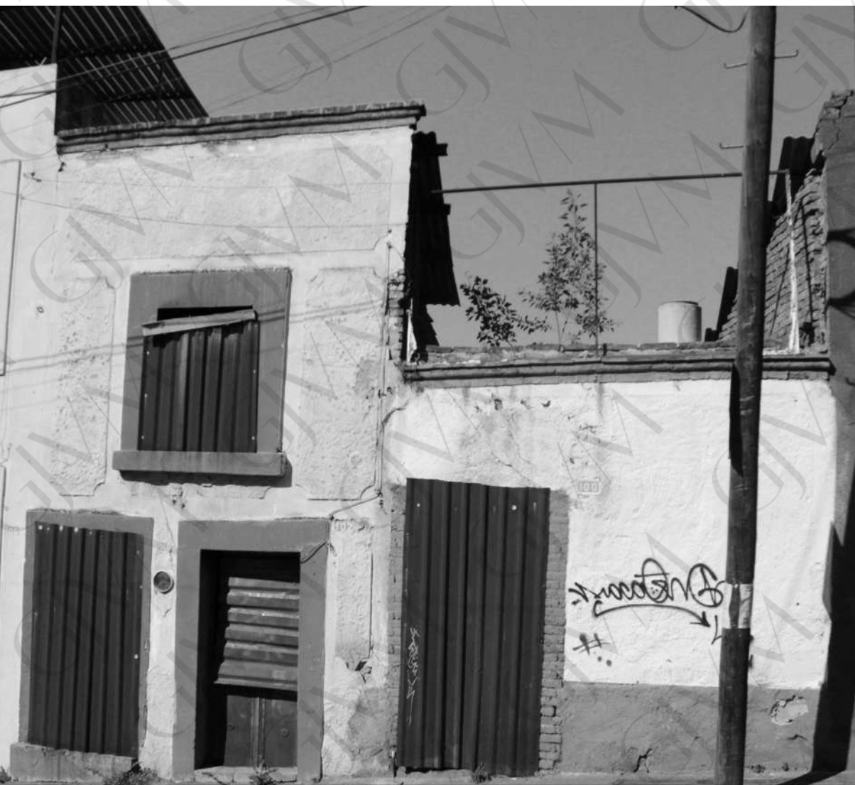
Imagen 32. Vivienda Deteriorada, sector República. Foto tomada por: Grecia Vargas
