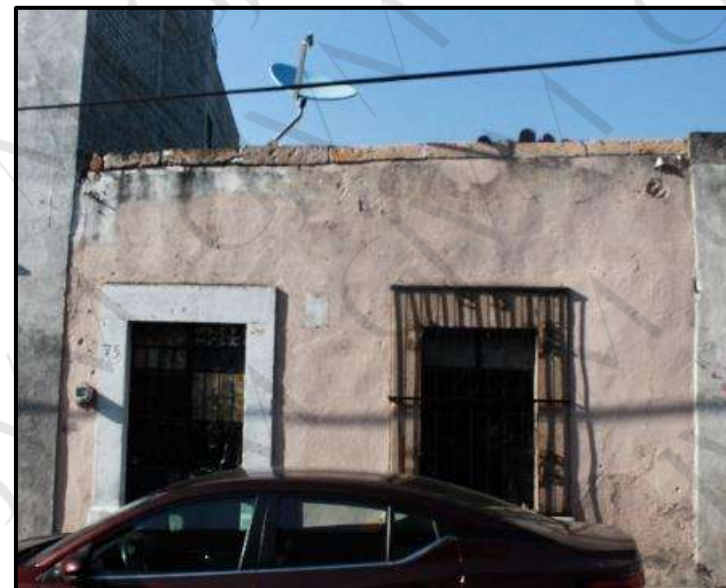
Figura 53. Vivienda patrimonial en estado de riesgo medio. Foto tomada por: Grecia Vargas.
