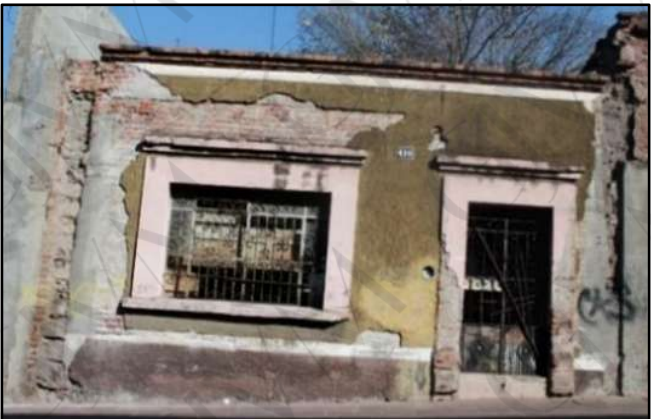
Imagen 58. Vivienda Patrimonial en riesgo, Sector República. Tomada por: Grecia Vargas.
