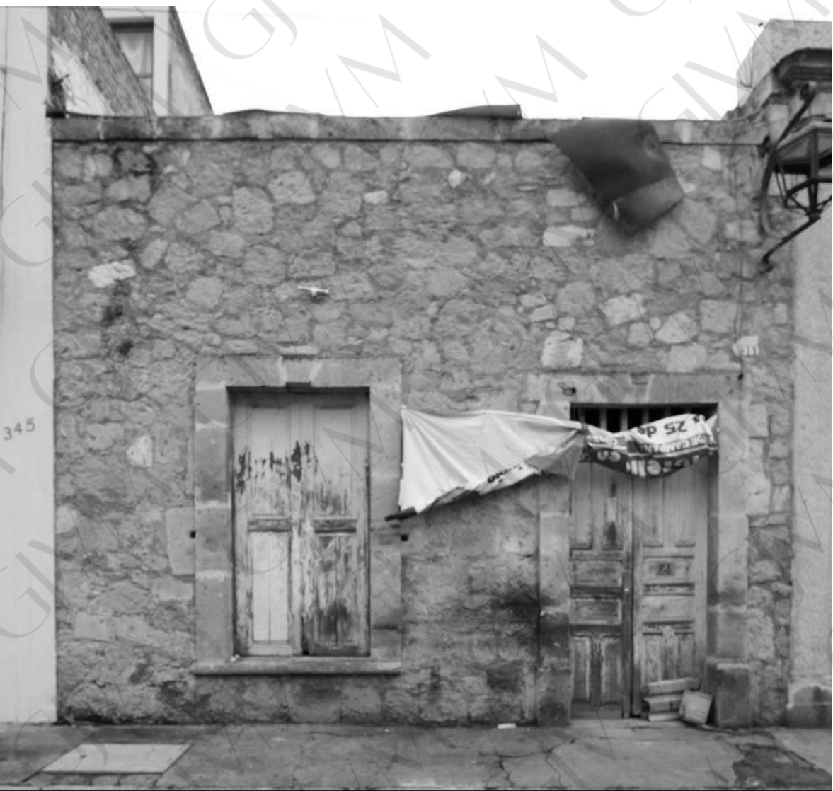
Imagen 6. Vivienda Deteriorada ubicada en Sector Nueva España. Fuente: Grecia Vargas
