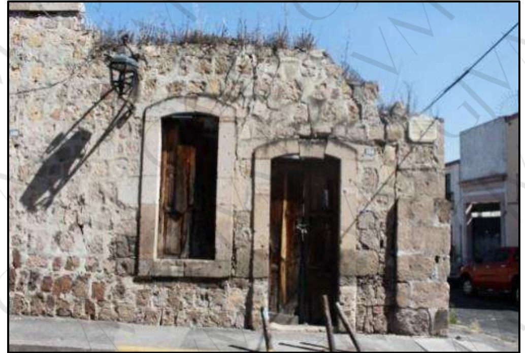
Imagen 55. Vivienda patrimonial en estado de riesgo colapsada, Sector Revolución. Foto tomada por: Grecia Vargas.
