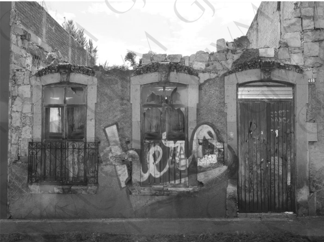
Imagen 4. Vivienda Colapsada, ubicada en Sector Nueva España. Foto tomada por: David Camarena.
