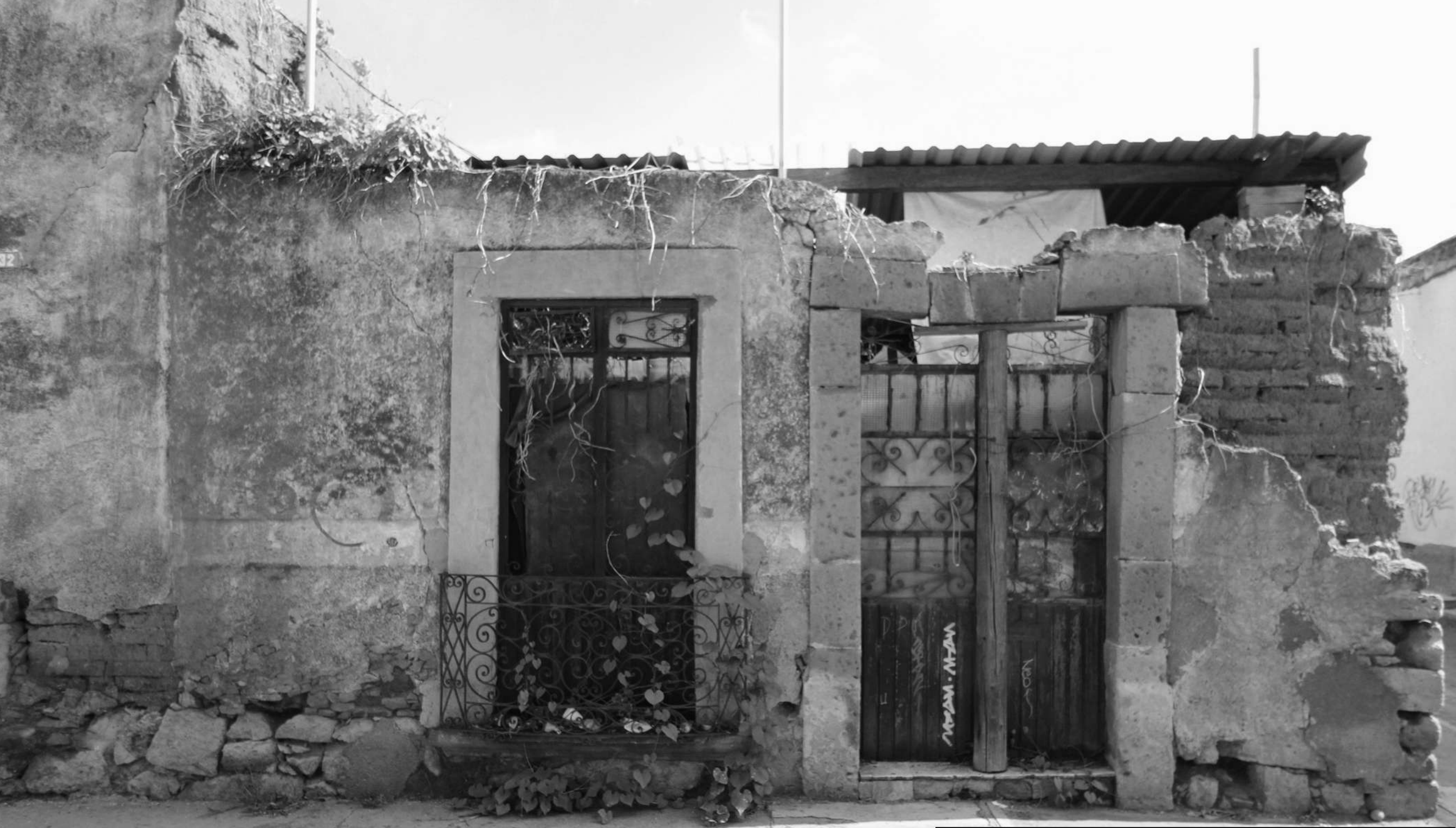
Imagen 2. Vivienda Colapsada, ubicada en Sector Independencia. Foto tomada por: Grecia Vargas
