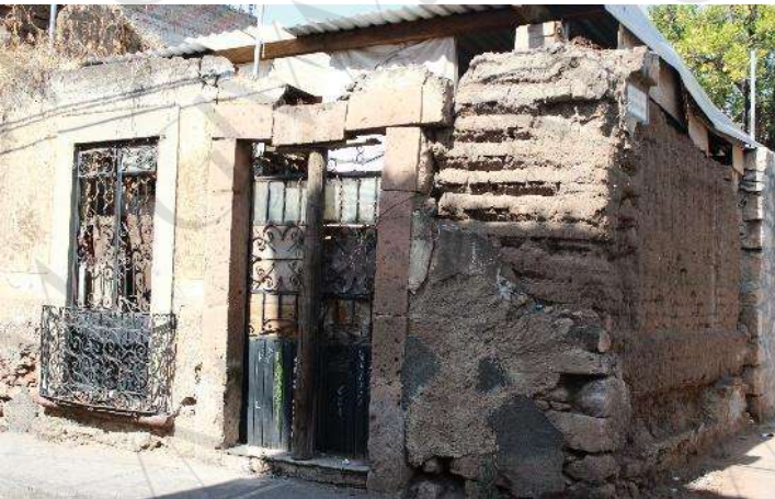
Imagen 46. Vivienda en estado de Riesgo Colapsado, habitada en el sector Independencia. Foto tomada por: Grecia Vargas.
