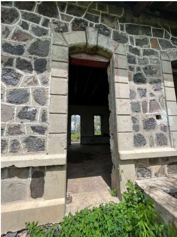
Ilustración 106. Fotografía del asoleamiento de la fachada sur de la estación en la que se observa un mayor desgaste en juntas y calavereado de muros, Enero del 2023, ACM
