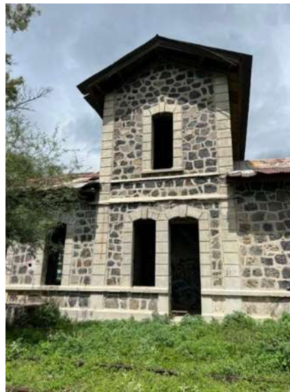
Ilustración 95. Fotografía de la casa del jefe de la estación donde se aprecian vestigios de cornisa y lo que pudo haber tenido una extensión de techo, Fuente: ACM
