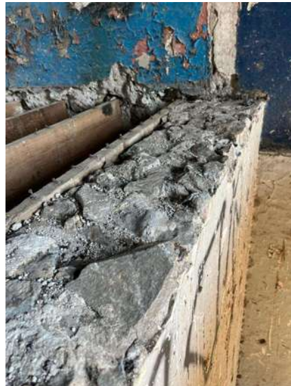
Ilustración 99. Fotografía de la conformación de los muros de carga y entepiso, Marzo 2023, Fuente: ACM
