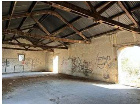
Ilustración 102. Cubierta de la bodega, daños en largueros, y estructura. enero del 2023, ACM
