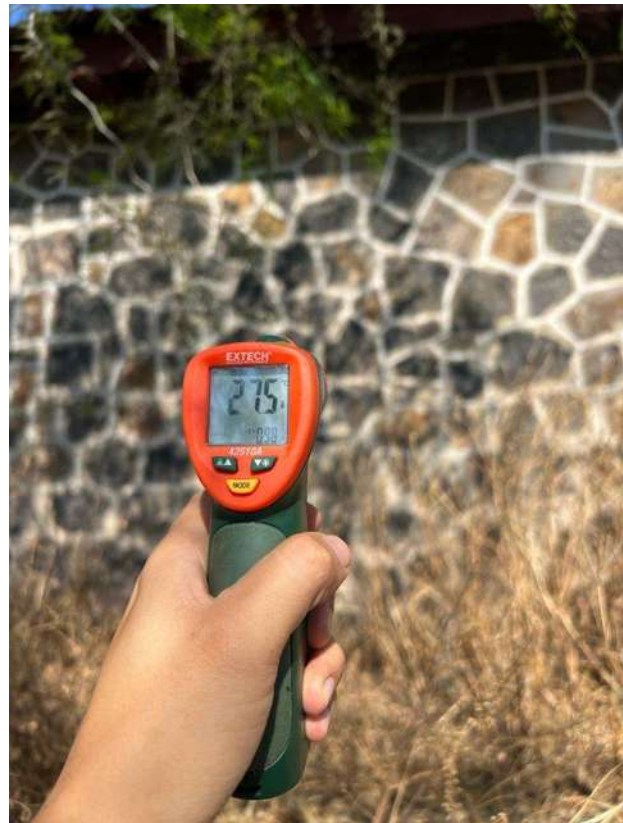
Ilustración 107. Fotografía de levantamiento de datos ambientales en fachada con termómetro de pistola, temperatura mayor que en las otras fachadas, Enero del 2023, ACM
