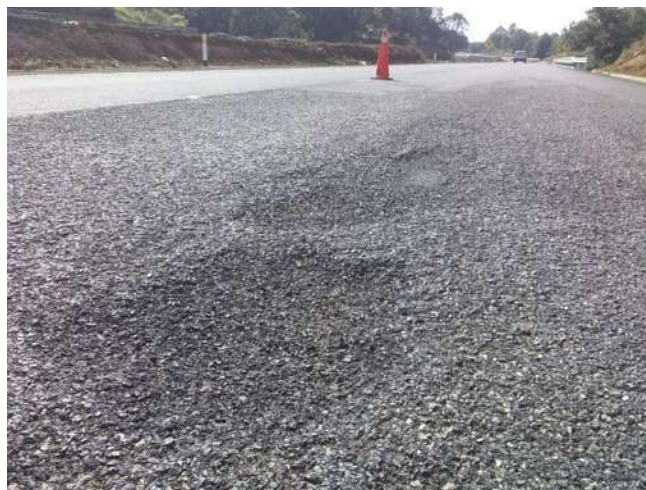
Figura 8. Desprendimiento de agregado en el km 15+900 de la autopista Pátzcuaro-Uruapan. Fuente: Imagen capturada por el autor.
