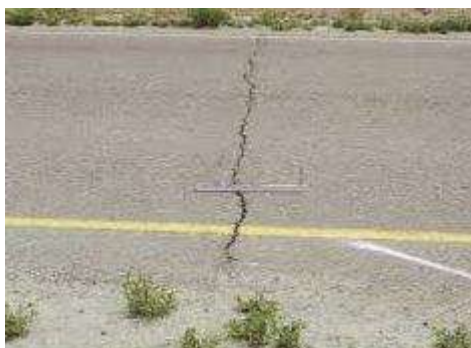
Figura 9. Fisura transversal asociada a bajas temperaturas. Fuente: MANUAL CENTROAMERICANO DE MANTENIMIENTO DE CARRETERAS, 2000.
