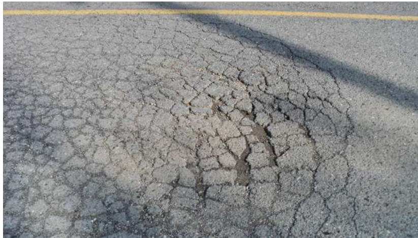
Figura 7. Pavimento asfáltico que presenta agrietamiento por fatiga. Fuente:fallasenpavimentoflexible.blogspot.com
