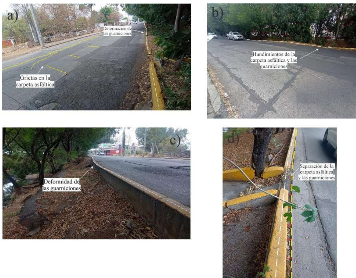
Figura 31. a) Fracturas sobre la carpeta asfáltica, la parte oscura corresponde a los saneamientos realizados en la vialidad, b), c) y d) Deformaciones visibles sobre la vialidad.
