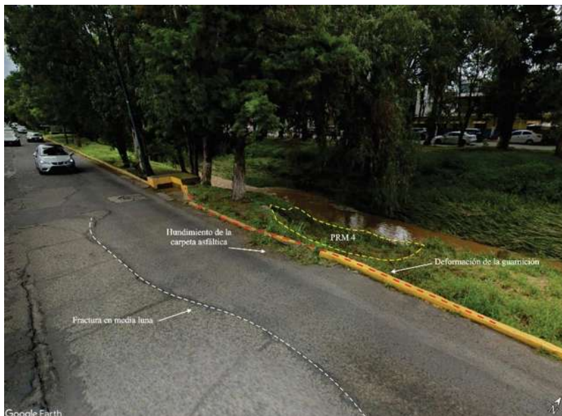
Figura 42. PRM 4 observado en campo a la altura del estacionamiento de Soriana del Río, se observa la deformación de la guardación, así como el hundimiento de la carpeta asfáltica (Google, 2023).
