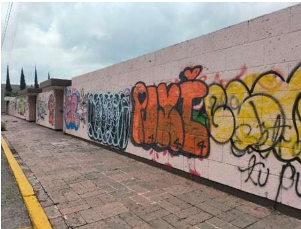
IMAGEN 5 DETERIOROS ANTROPICOS, AUTOR FSP
