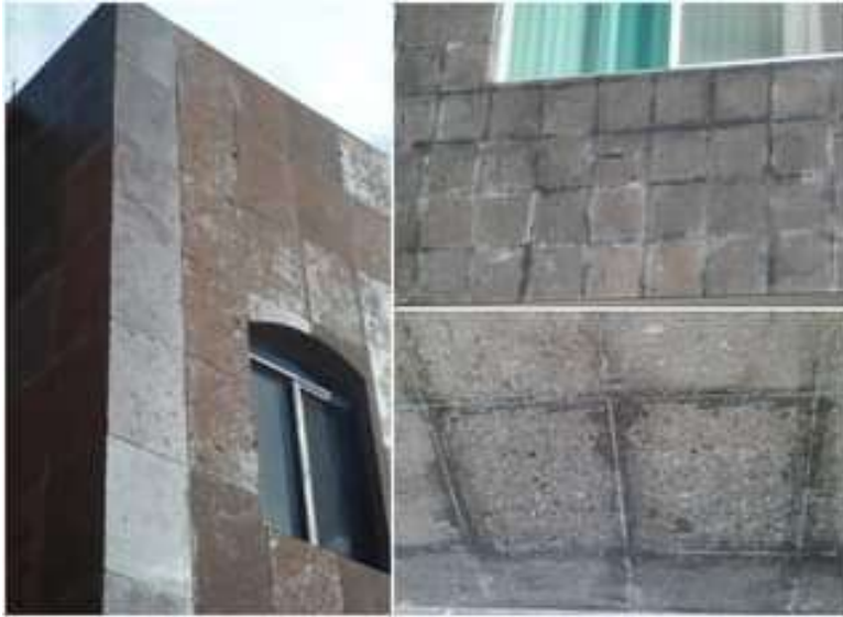
IMAGEN 23, Deterioros en ignimbrita, autor FSP.
