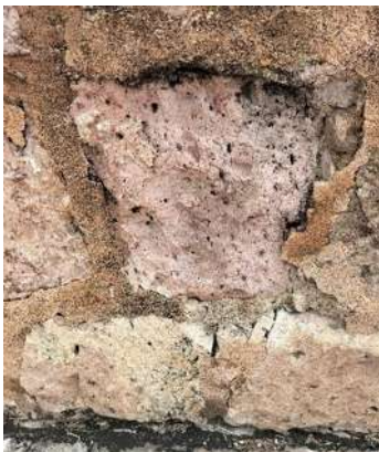
IMAGEN 3 DETERIOROS ABIOTICOS, AUTOR FSP
