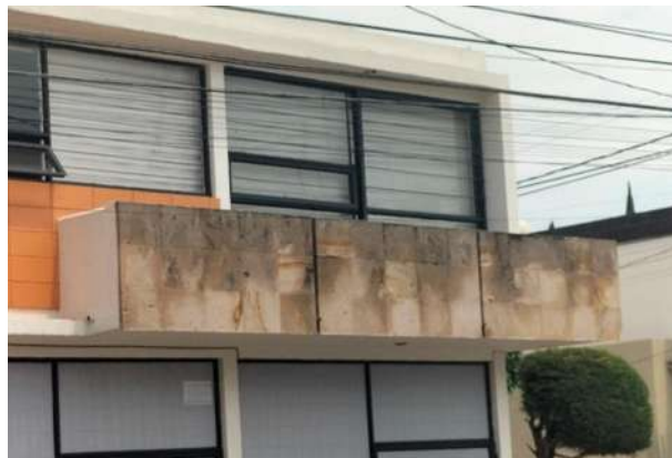
IMAGEN 4 DETERIOROS ABIOTICOS, AUTOR FSP
