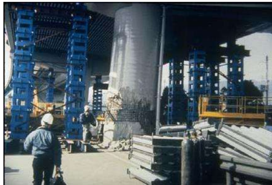
Figura 1.2. Pila del viaducto Hanshin en la ciudad de Kobe con deformación permanente después del sismo de 1995.
