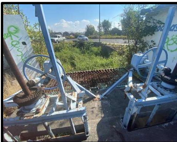
Figura 54.- Estructura de regulación en la confluencia del dren Mora Tovar y Río Grande.
