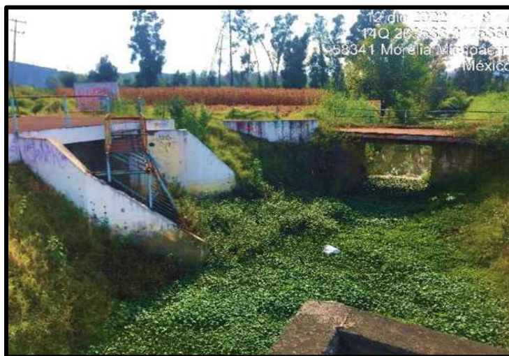
Figura 45.- Cárcamos de bombeo para el control de avenidas
