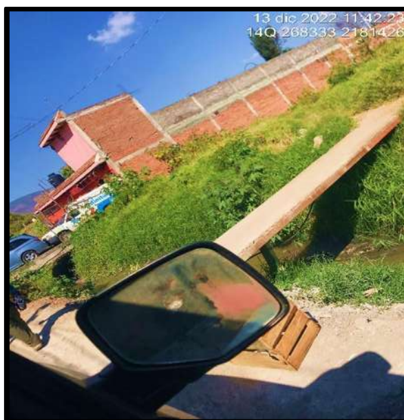
Figura 62.- Estructuras de cruce construidas de manera Inadecuada y población asentada en zonas de riesgo
