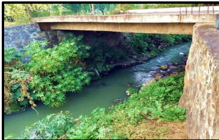
Figura 51.- Estructura de cruce en dren Barajas que aumenta la capacidad hidráulica.
