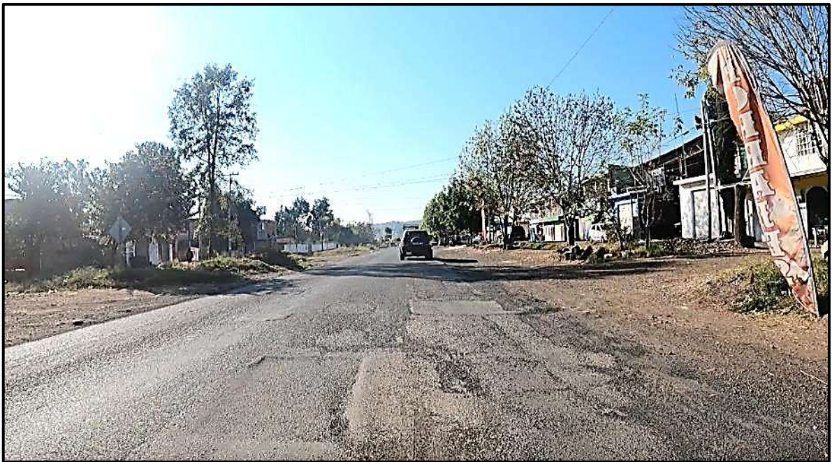
Ilustración 45. Baches reparados, desprendimientos, deformaciones transversales y longitudinales en km 1+100 (PEPSA, 2023).
