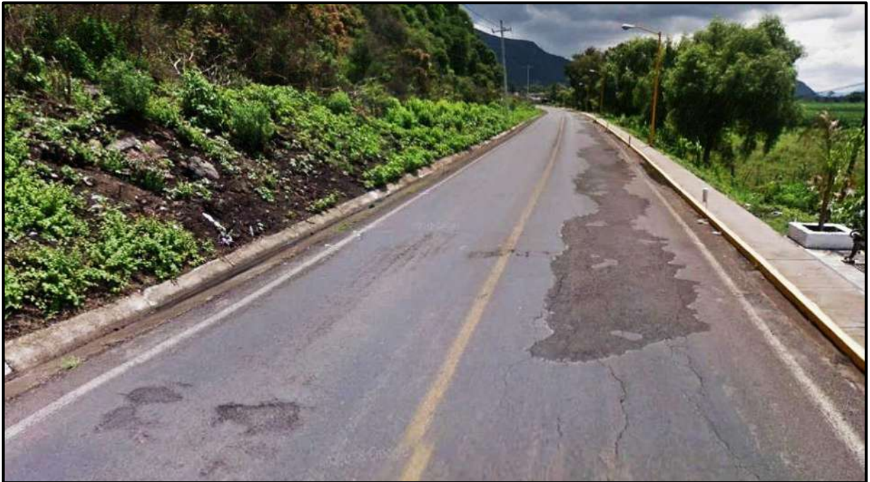
Ilustración 34. Agrietamientos longitudinales, baches, baches reparados, intemperismo y desprendimientos en km 14+020.
