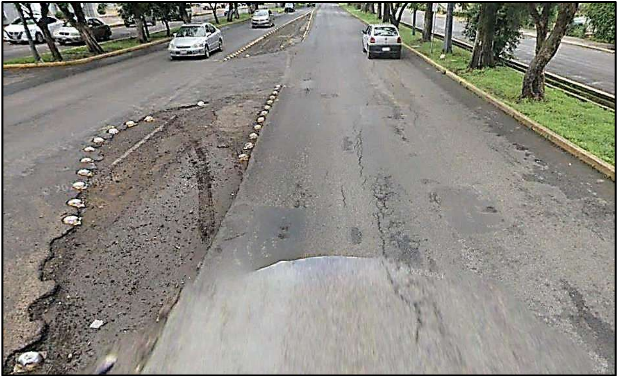
Ilustración 26. Desprendimientos, baches y agrietamientos en km 7+620 (PEPSA, 2023).
