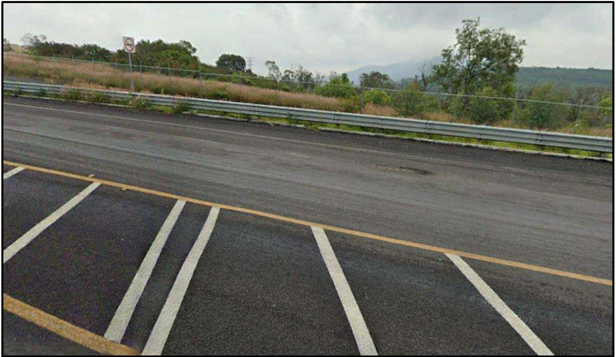
Ilustración 32. Baches y agrietamientos longitudinales en km 104+300.
