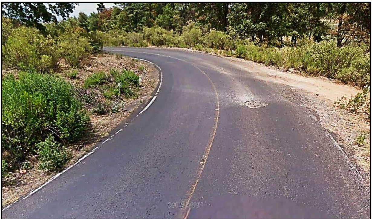
Ilustración 43. Agrietamientos longitudinales y de “piel de cocodrilo”, deformaciones y baches en km 23+040.
