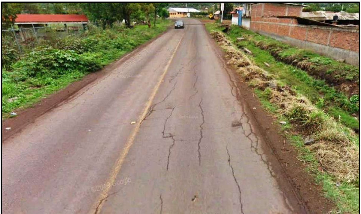
Ilustración 39. Agrietamientos y deformaciones longitudinales, agrietamientos de “piel de cocodrilo” en km 20+030.
