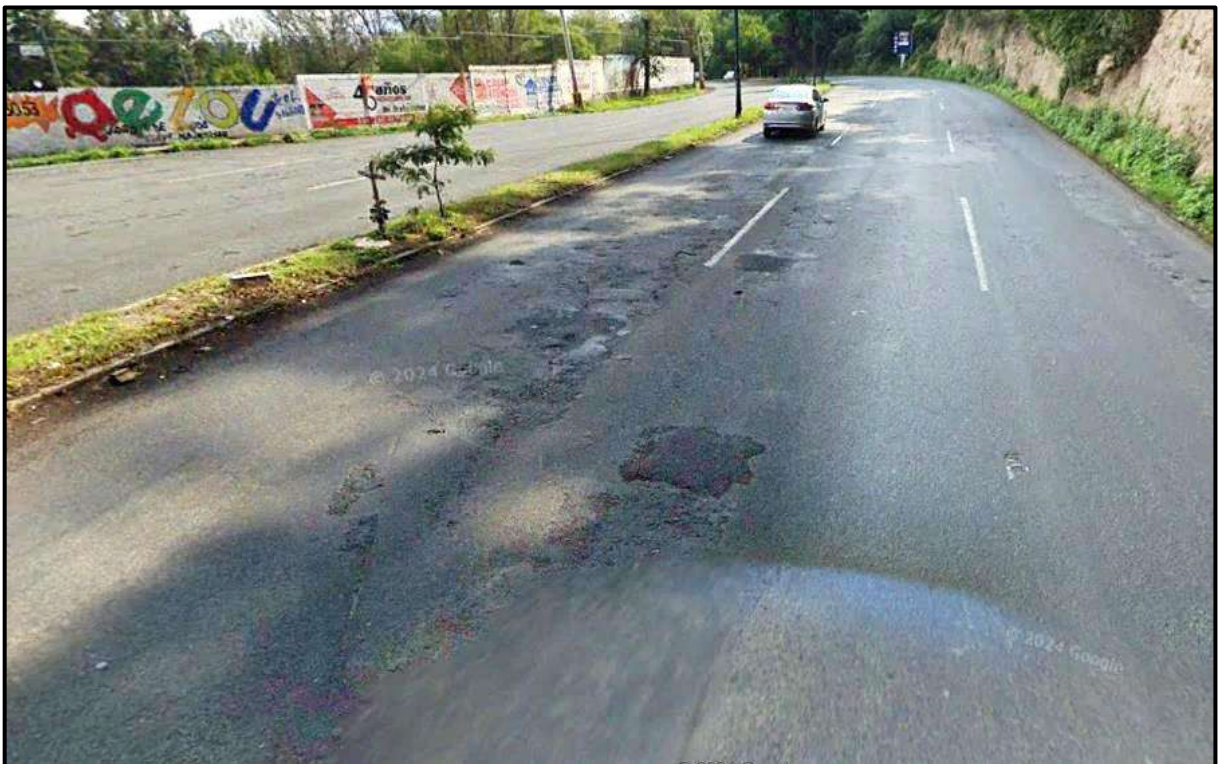
Ilustración 27. Baches, baches reparados, grietas, deformaciones y desprendimientos en km 11+220 (PEPSA, 2023).
