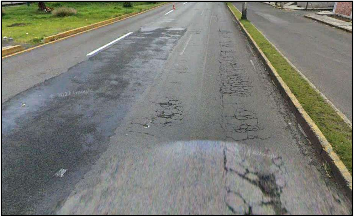
Ilustración 28. Agrietamiento (piel de cocodrilo), baches reparados, desprendimientos y deformaciones en km 22+740 (PEPSA, 2023).
