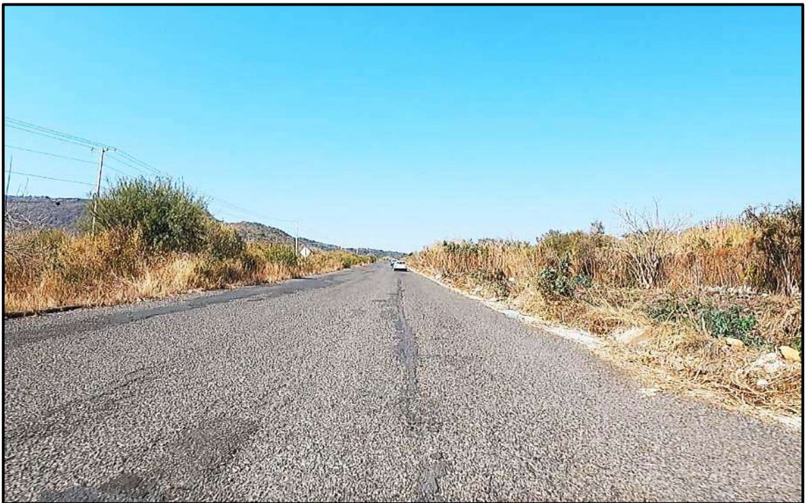
Ilustración 51. Intemperismo, desprendimiento de agregados y deformaciones en km 20+000 (PEPSA, 2023).
