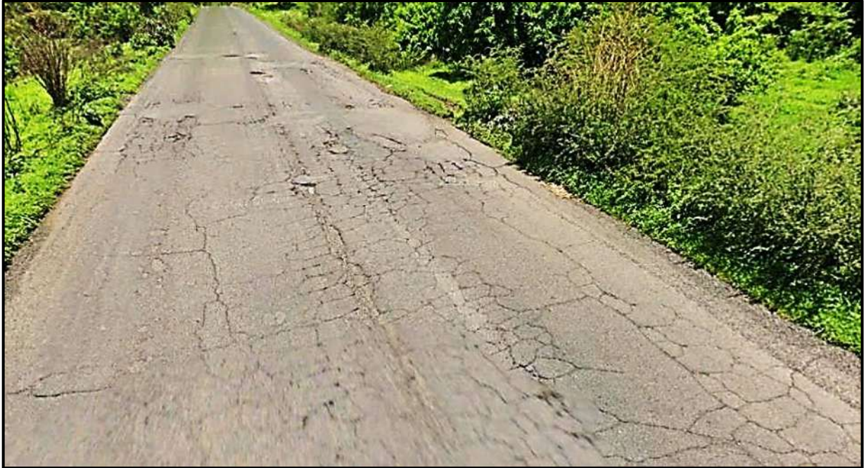
Ilustración 36. Agrietamientos (piel de cocodrilo y en bloque), desprendimientos y baches en km 36+630.
