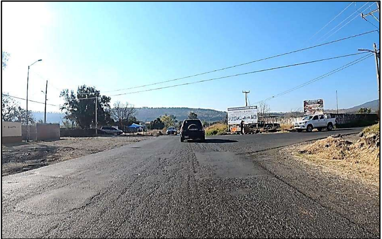
Ilustración 47. Pulimento de agregados, intemperismo, deformaciones y baches reparados en km 4+800 (PEPSA, 2023).
