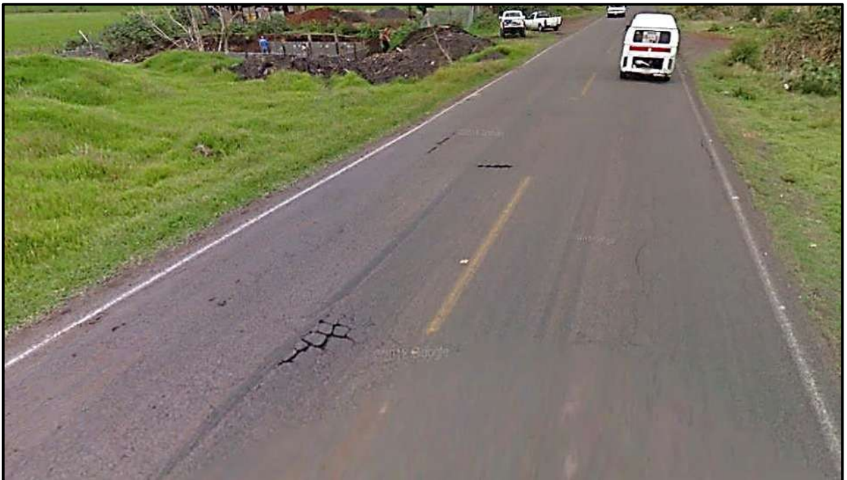
Ilustración 37. Agrietamiento longitudinal, de piel de cocodrilo, deformación longitudinal y desprendimientos en km 1+520.
