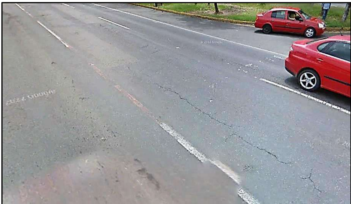
Ilustración 25. Agrietamiento longitudinal km 1+040 (PEPSA, 2023).
