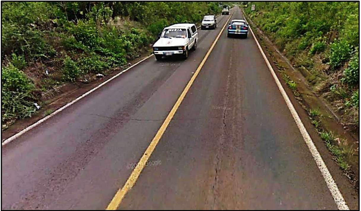
Ilustración 38. Agrietamiento y deformación longitudinal, agrietamiento de “piel de cocodrilo” en km 9+540.
