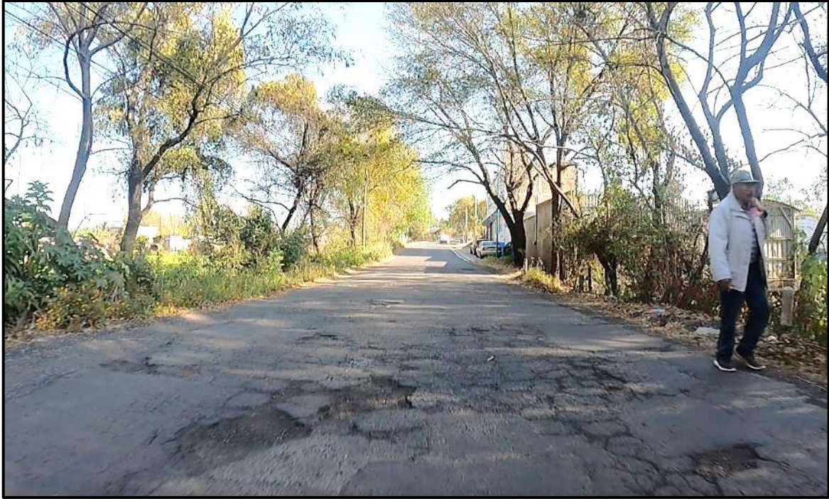
Ilustración 48. Baches, desprendimiento de agregados, grietas en bloque y deformaciones en km 9+400 (PEPSA, 2023).
