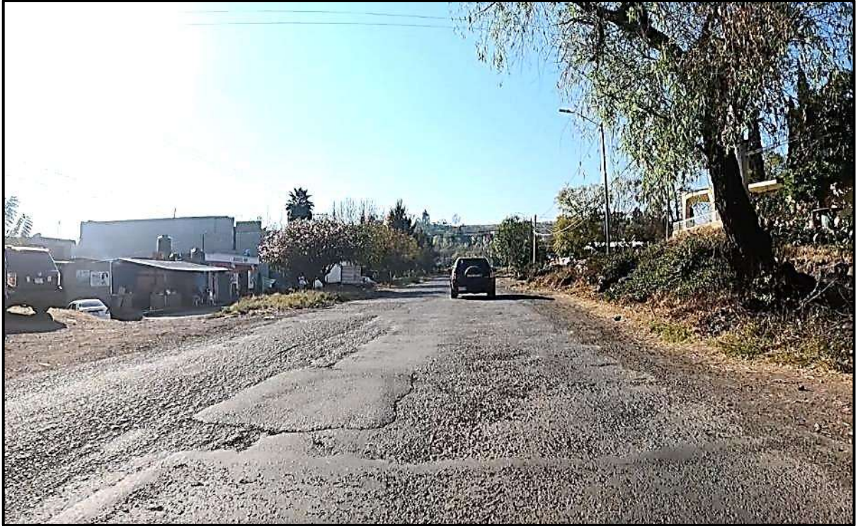
Ilustración 46. Baches reparados, desprendimientos, deformaciones verticales y longitudinales en km 2+200 (PEPSA, 2023).
