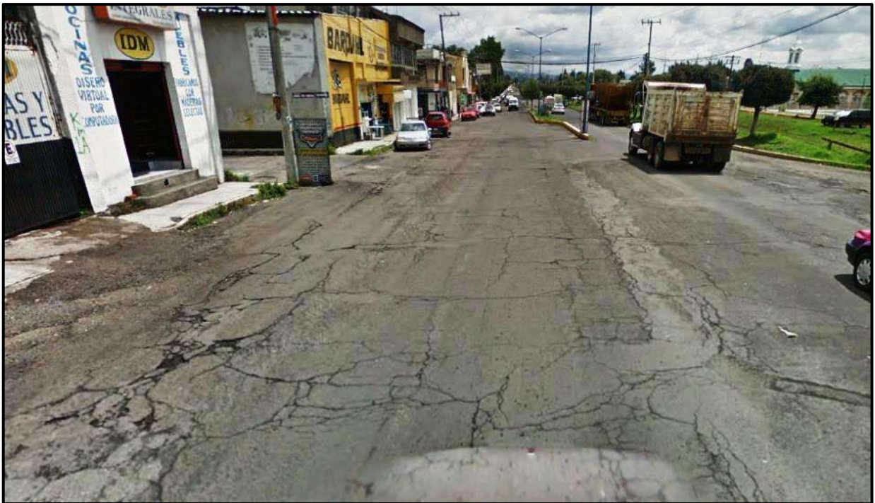
Ilustración 33. Baches, agrietamientos longitudinales, transversales, en forma de mapa, desprendimientos y deformaciones en km 1+700.
