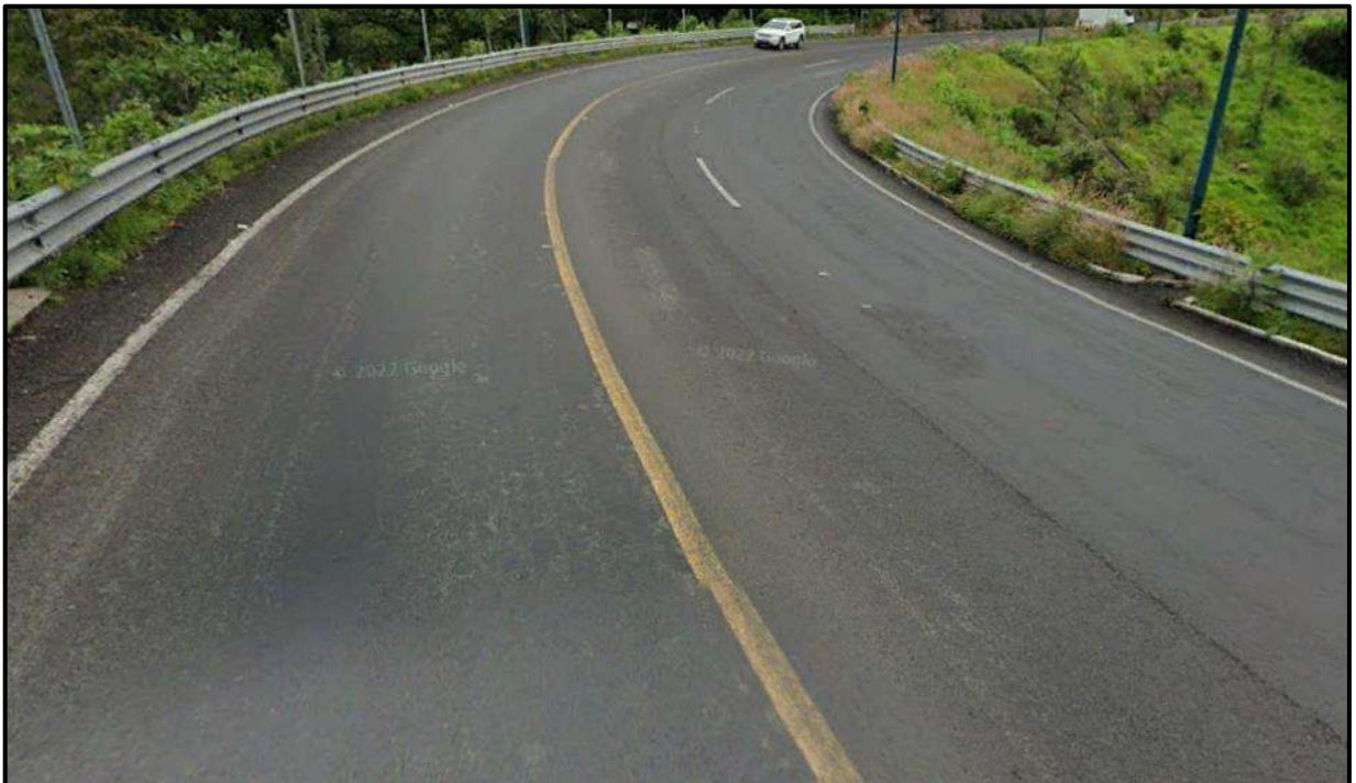
Ilustración 31. Ligeras deformaciones verticales y comienzos de agrietamientos en Km 103+620.
