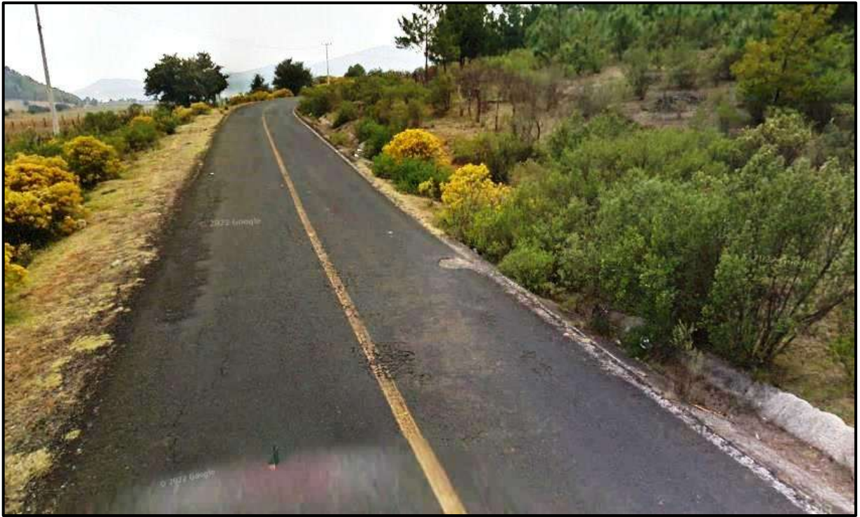
Ilustración 42. Baches reparados, agrietamientos y deformaciones en km 18+060.
