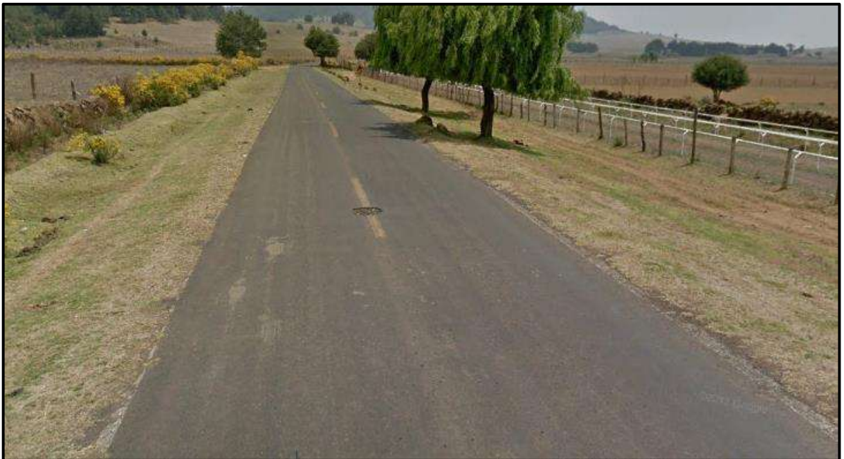
Ilustración 41. Deformaciones longitudinales, baches y agrietamientos en km 14+000.
