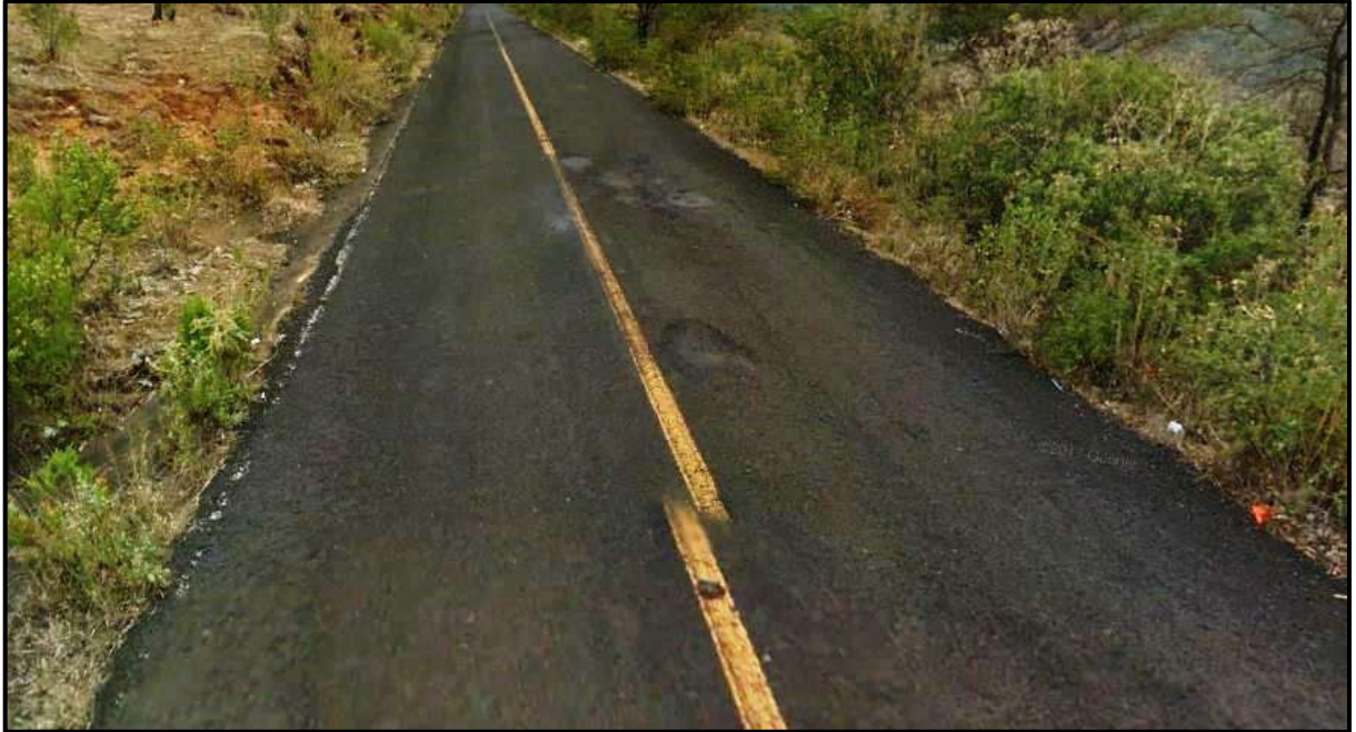
Ilustración 44. Baches, desprendimientos, agrietamientos en bloque en km 26+040.
