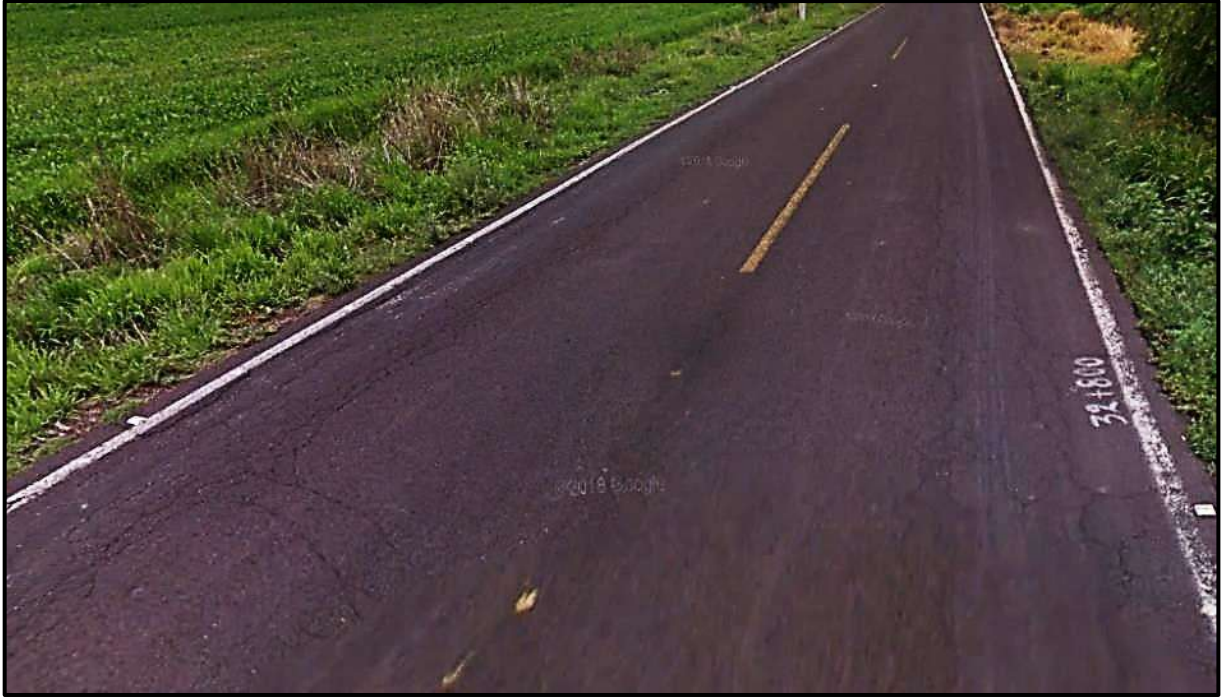
Ilustración 40. Deformaciones longitudinales, agrietamientos en bloque, longitudinales y transversales en km 32+800.
