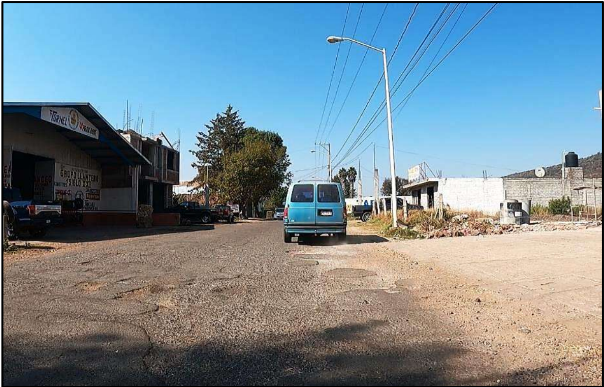
Ilustración 52. Baches, deformaciones y desprendimiento de agregados en km 36+000 (PEPSA, 2023).
