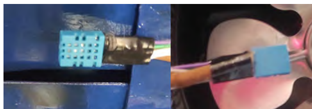
Figura 2.32. Sensores DTH11 colocados en la entrada y salida del aire en la unidad.
