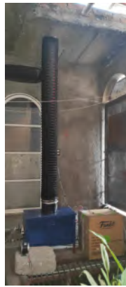
Figura 2.31. Ducto en la unidad de enfriamiento.
