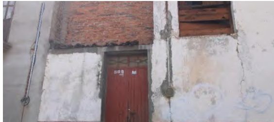
Ilustración 22. Ventana tapiada con madera, cerramientos de cemento.
