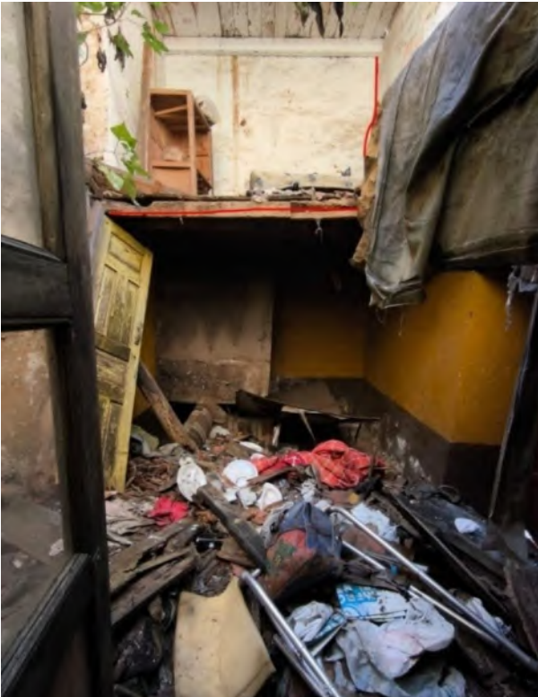
Ilustración 100. Desplomo de entrepiso y cubierta. Fotografía: KXFC. Elaborado por KXFC.
