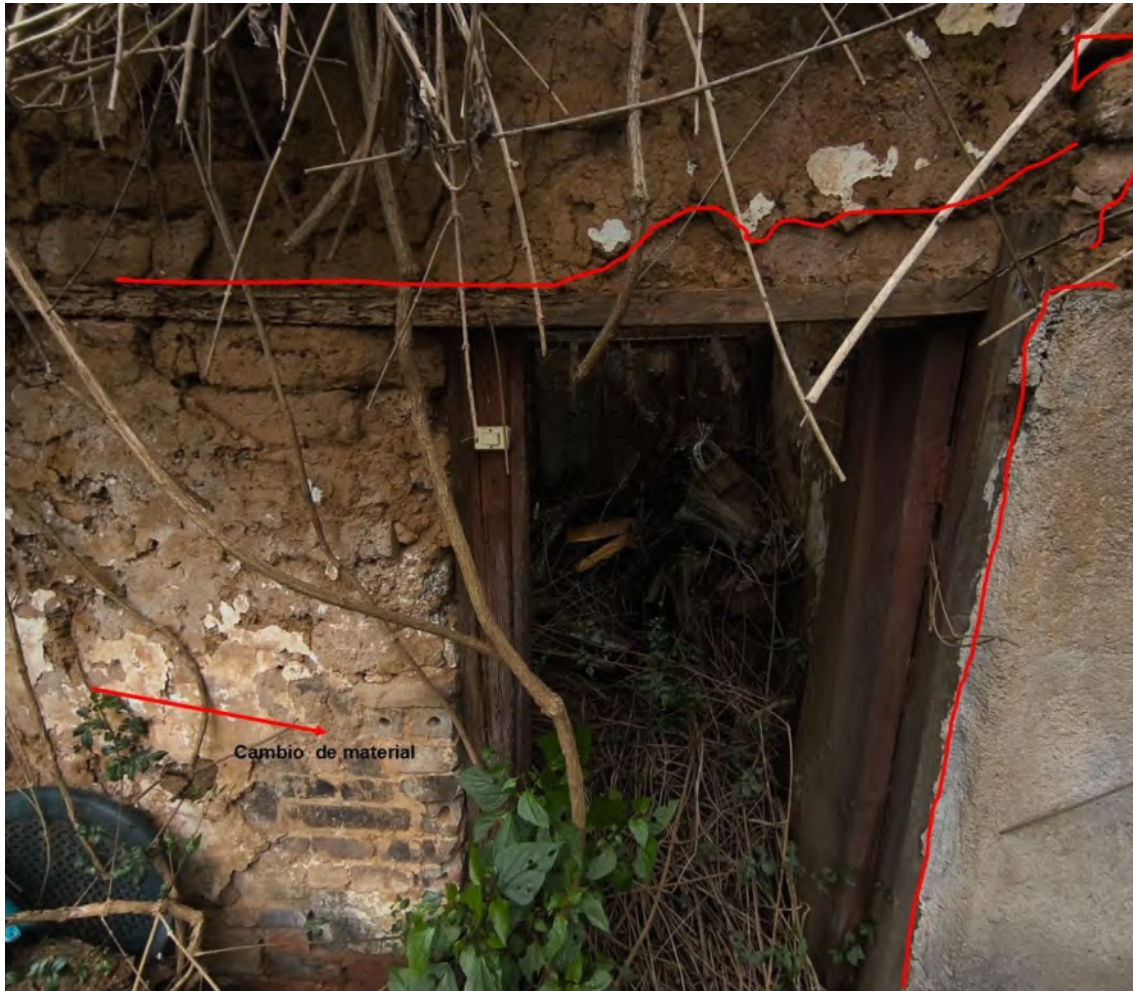
Ilustración 96. Muro de adobe con materiales incompatibles y agrietamiento. Fotografía: KXFC. Elaborado por KXFC.
