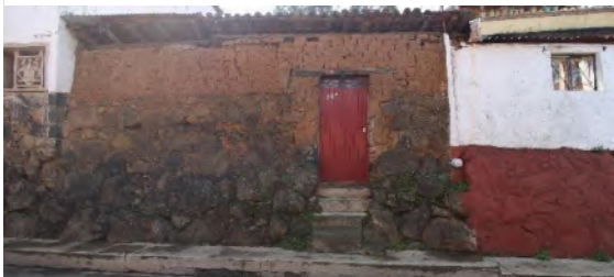
Ilustración 24. Fachada con mampostería de adobe expuesta.
