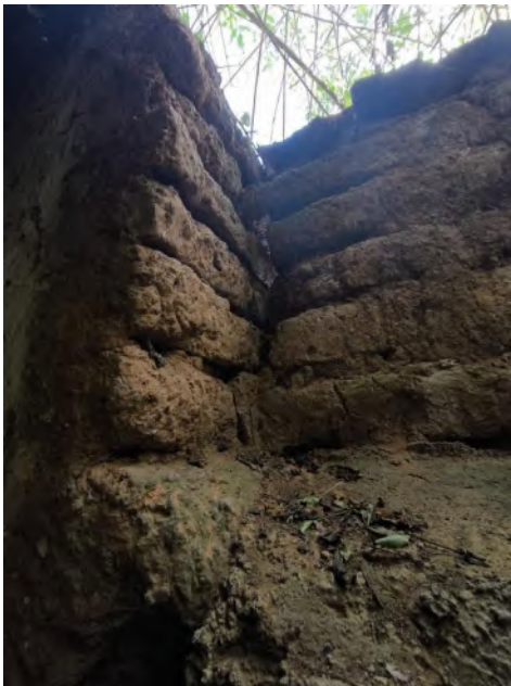
Ilustración 87. Adobes expuestos al Intemperismo en el inmueble. Fotografía: KXFC.
