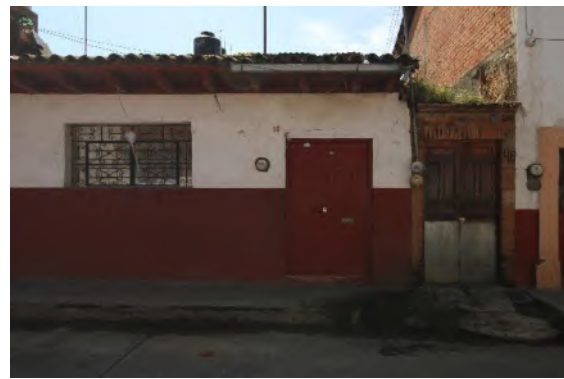
Ilustración 21. Muros de tabique visibles con una mala intervención.
