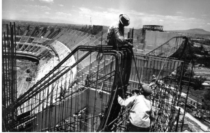
Fig. 111 Edificación de la estructura del Estadio Azteca, Cálculo Ingenieros Colinas – De Buen, 1962-1970.
