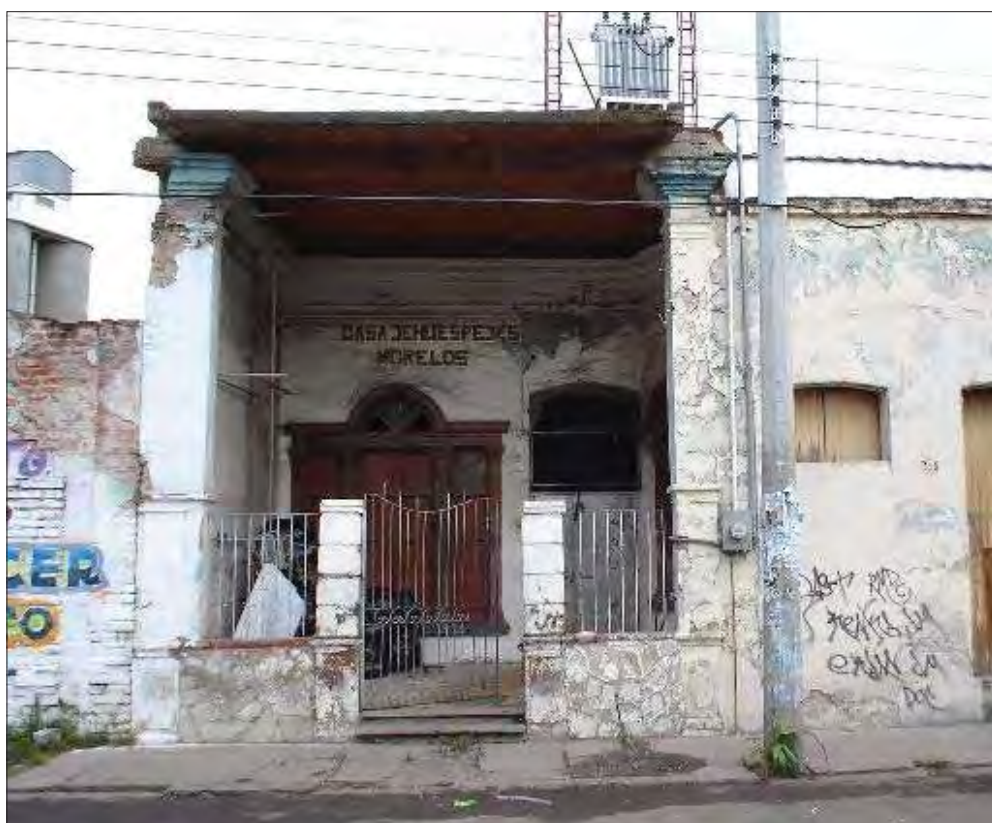
Ilustración 96 Viviendas deterioradas Foto: Jesús Cordero
