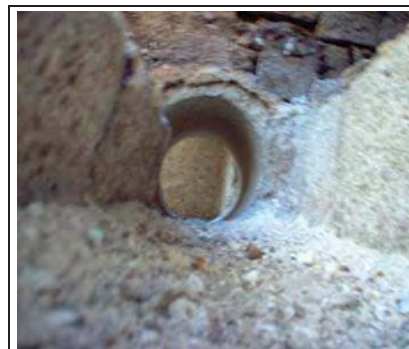
Figura 146. Detalle de unión de tubería al drenaje colectivo en la vivienda de la Colonia Miguel Alemán.
