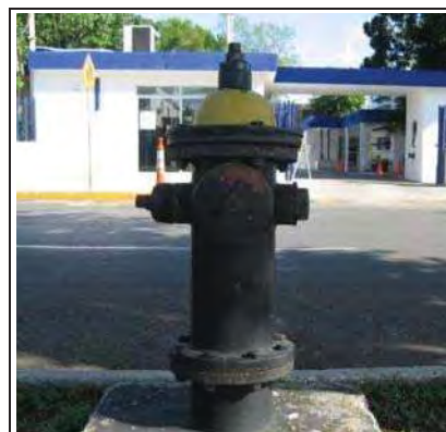
Figura 129. Hidrante junto a las oficinas de la Junta de Agua Potable y Alcantarillado de Yucatán, calle 27 de la Colonia Miguel Alemán. Fuente: Trabajo de campo, 2006.
