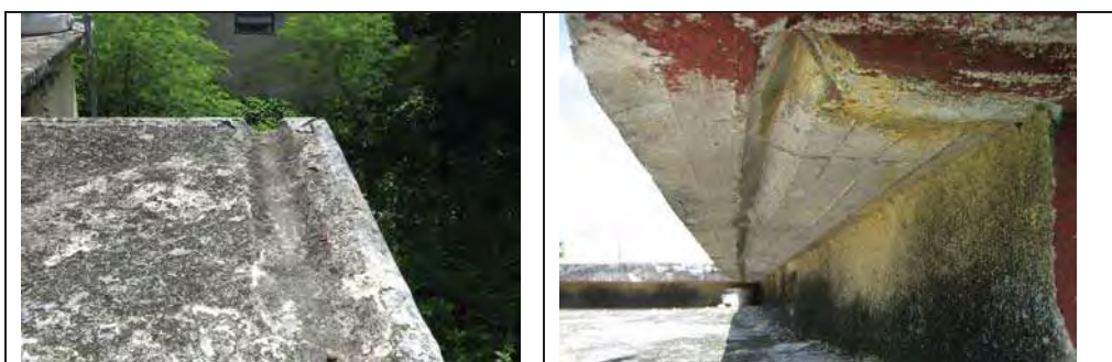
Figura 143. Detalle de sistema de desagüe pluvial en la vivienda de la Colonia Miguel Alemán: canal (izquierda) y gotero (derecha).
