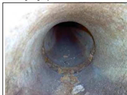
Figura 130. Detalle de la tubería de drenaje colectivo de la Colonia Miguel Alemán. Fuente: Cortesía de Carlos Polanco.
