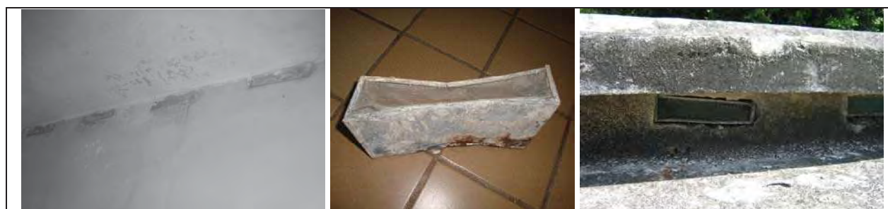
Figura 145. Sistema de ventilación cruzada en la vivienda de la Colonia Miguel Alemán. Vista interior, detalle de caja para ventilación y vista exterior.
