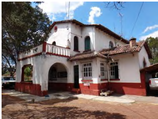
Figura 73. Volumen sureste de la vivienda, donde se observan diversas alteraciones temporales. Fotografía del autor (2016).
