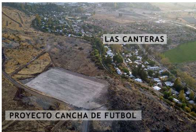
▲ Fotografía 22: La cancha de fútbol con la mejor vista de Santiago de Chile, se construye en el barrio “Las Canteras”. Fuente: https://www.chicureohoy.cl/actualidad/una-cancha-de-futbol-en-el-cerro-las-canteras-proyecto-ya-fue-aprobado-y-esta-proximo-a-ser-construido/
