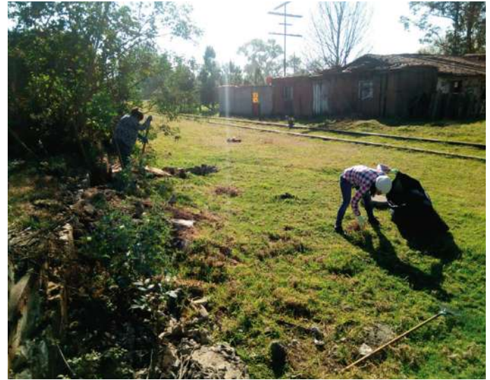
▲ Fotografía 104: Limpieza y desbroce de maleza en el sitio de intervención como actividades previas. Fuente: Tomada por el Autor.
