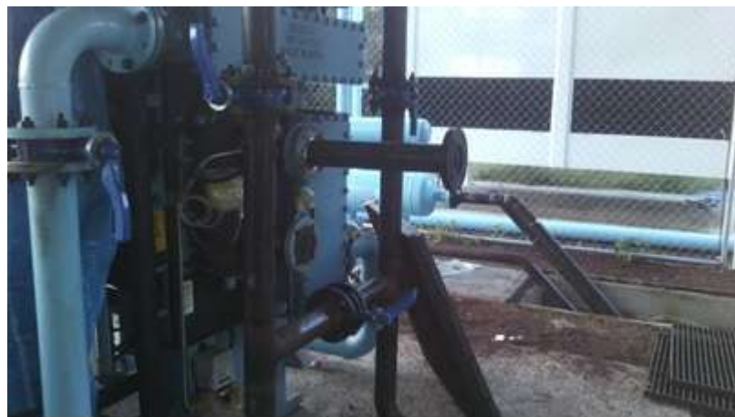
Figura 4.59: Válvulas implementadas en máquina THERMAX (Proyecto Cemie-Geo P16).
