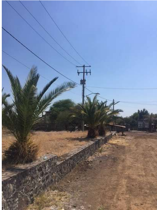
Figura 4.27: Condiciones de la red eléctrica.
