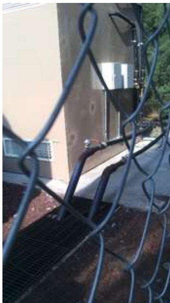
Figura 4.70: Registrador de temperatura en módulo de deshidratación (Proyecto Cemie-Geo P16).
