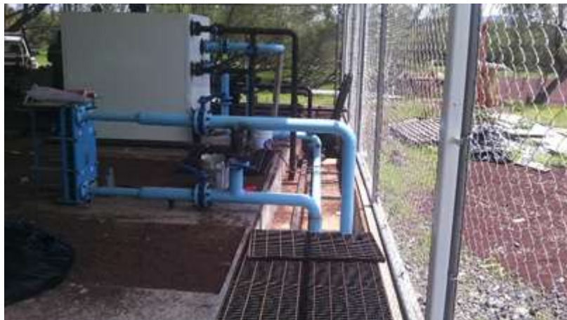
Figura 4.60: Válvulas implementadas en intercambiador de placas Dhimex (Proyecto Cemie-Geo P16).
