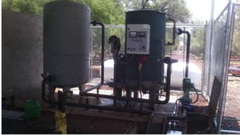
Figura 4.65: Registradores de temperatura y presión de caldera auxiliar I (Proyecto Cemie-Geo P16).
