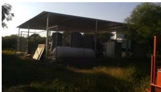
Figura 4.77: Montaje final de la planta de poligeneración II (Proyecto Cemie-Geo P16).
