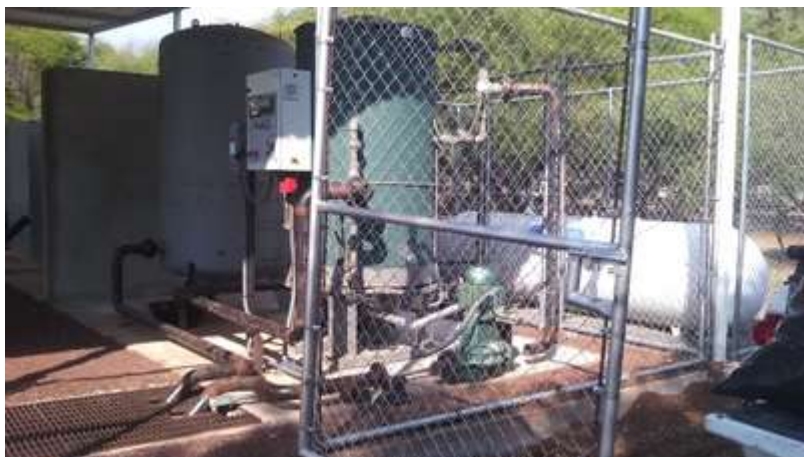
Figura 4.43: Integración de la caldera auxiliar e instrumentación (Proyecto Cemie-Geo P16).
