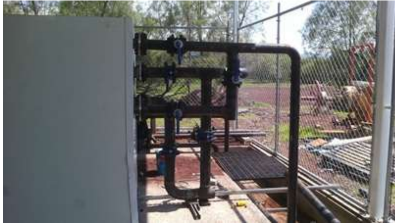
Figura 4.58: Válvulas implementadas en el módulo ORC (Proyecto Cemie-Geo P16).
