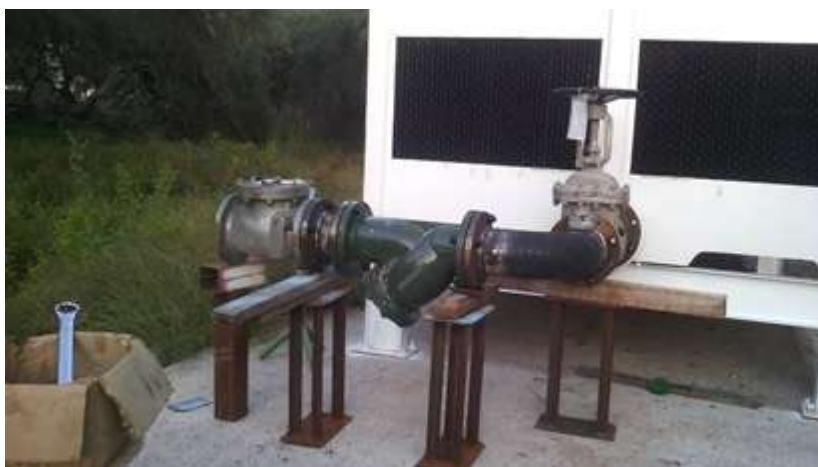
Figura 4.61: Válvula del circuito de agua de enfriamiento (Proyecto Cemie-Geo P16).
