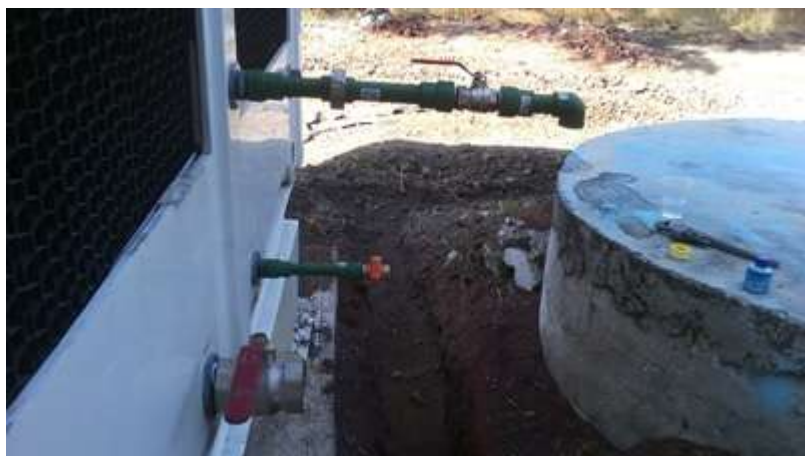
Figura 4.52: Purga de torre de refrigeración (Proyecto Cemie-Geo P16).
