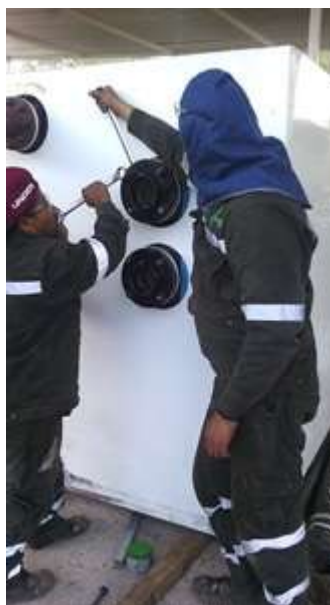
Figura 4.32: Conexiones del agua de enfriamiento y agua caliente del ORC (Proyecto Cemie-Geo P16).
