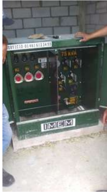
Figura 4.30: Transformador de voltaje de la planta de poligeneración.
