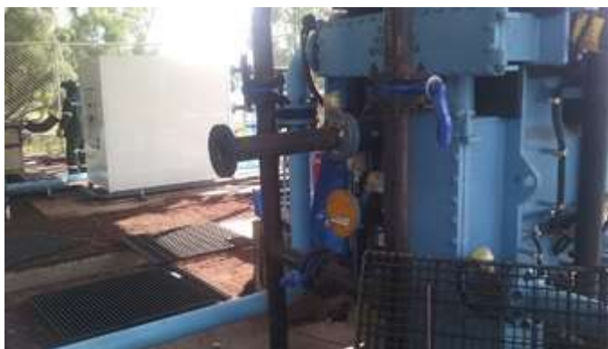
Figura 4.36: Conexiones del circuito de agua fría (Proyecto Cemie-Geo P16).
