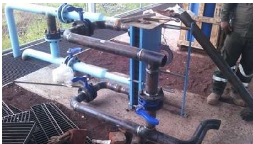
Figura 4.57: Válvulas implementadas en intercambiador de placas Sondex (Proyecto Cemie-Geo P16).
