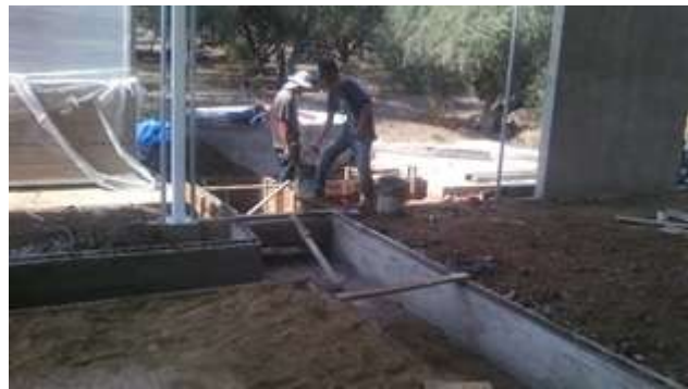
Figura 4.23: Trabajos de adecuación de la planta de poligeneración I (Proyecto Cemie-Geo P16).
