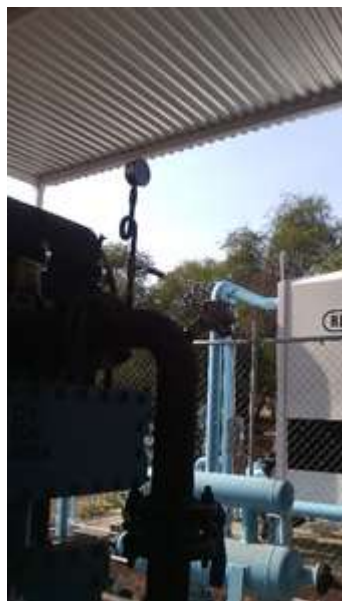
Figura 4.69: Registrador de presión en máquina THERMAX (Proyecto Cemie-Geo P16).
