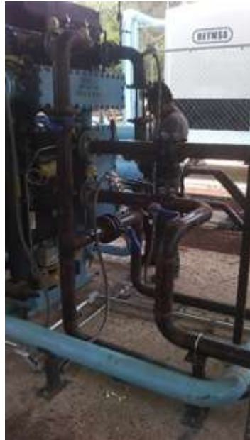
Figura 4.68: Registradores de temperatura y presión de máquina THERMAX (Proyecto Cemie-Geo P16).
