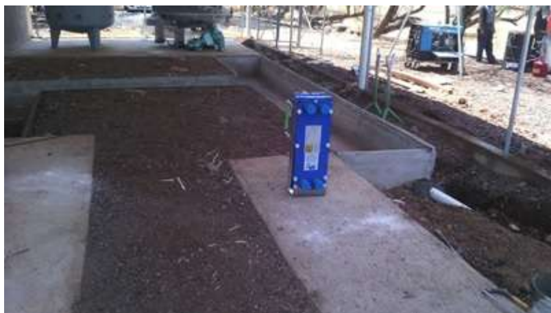
Figura 4.46: Acoplamiento de intercambiador de calor principal (Proyecto Cemie-Geo P16).
