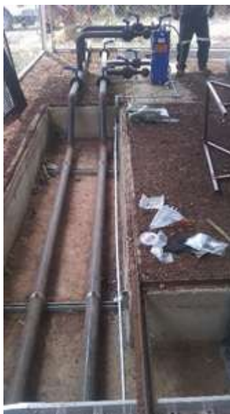
Figura 4.47: Acoplamiento del intercambiador de calor de placas I (Proyecto Cemie-Geo P16).
