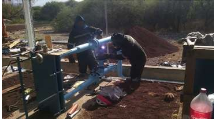
Figura 4.48: Acoplamiento de intercambiador de calor de placas II (Proyecto Cemie-Geo P16).
