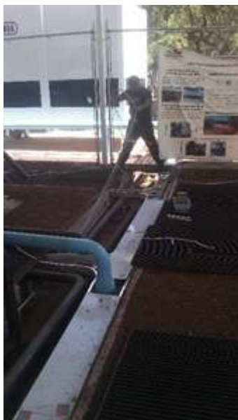
Figura 4.64: Interconexión de los registradores de presión y el módulo de control III (Proyecto Cemie-Geo P 16).
