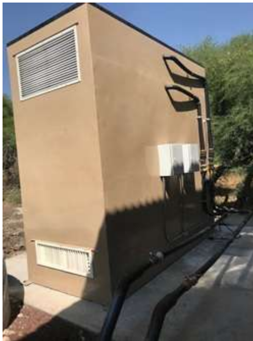
Figura 4.42: Montaje final del deshidratador en planta de poligeneración (Proyecto Cemie-Geo P16).
