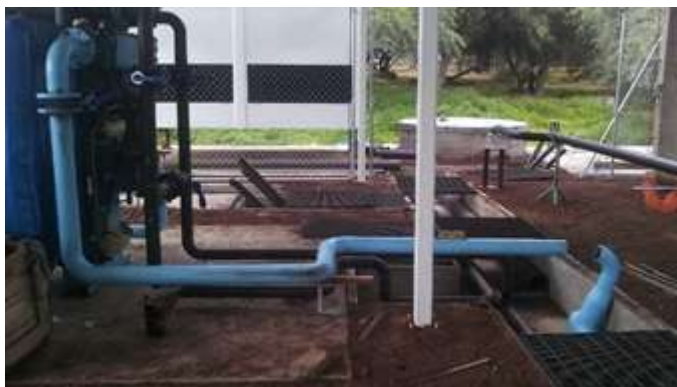
Figura 4.35: Conexión del circuito de agua de enfriamiento (tubería azul).
