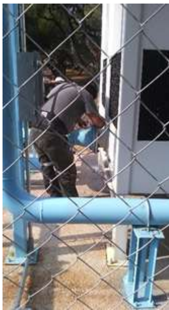
Figura 4.49: Acoplamiento de la torre de enfriamiento en planta de poligeneración I (Proyecto Cemie-Geo P16).
