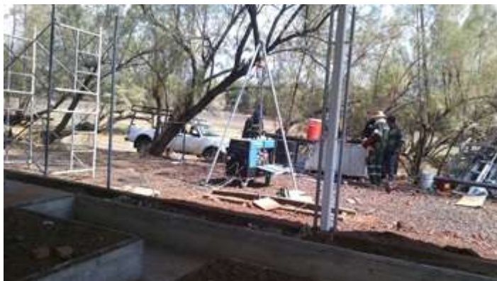
Figura 4.24: Trabajos de adecuación de la planta de poligeneración III (Proyecto Cemie-Geo P16).
