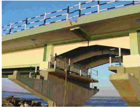
Fig. 2.4 Daño en los tableros ocasionado por el golpeteo longitudinal (Tomada de http://www.iitk.ac.in/nicee/EQ_Reports/Bhuj/bridge1.htm )
