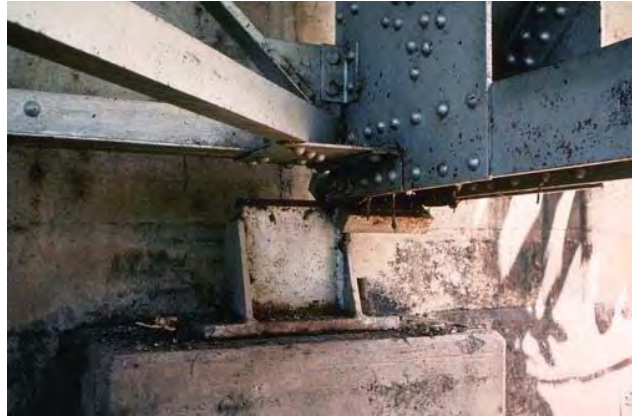
Fig. 2.10 Falla en elementos de concreto
