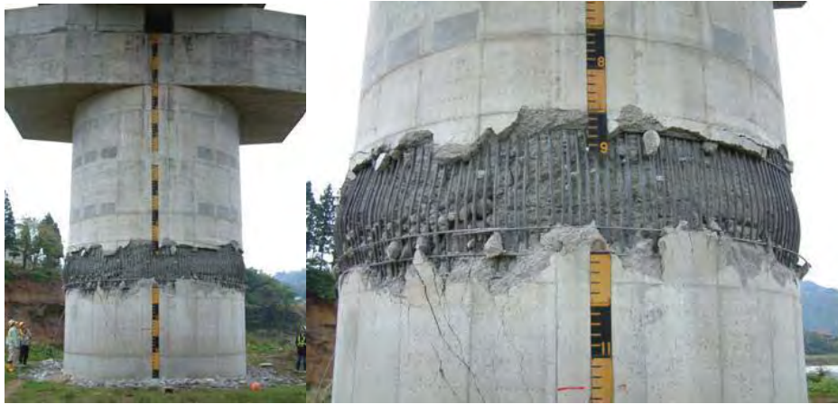
Fig. 2.7 Pérdida de recubrimiento y pando de las varillas longitudinales a la mitad de la altura de la columna. (Tomada de http://www.saitama-u.ac.jp/material/niigata-eq-no-3e-d1wnd-r5-1e_jpg.htm )
