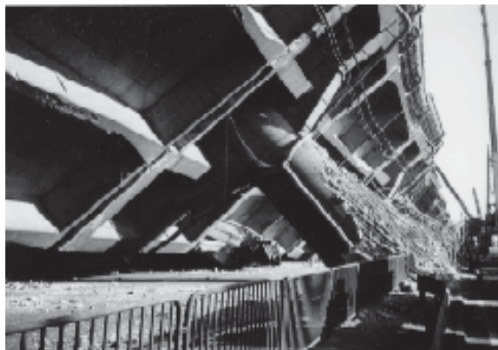
Fig. 2.6 Falla por flexión arriba de la base de la columna debida a una terminación prematura del refuerzo y un inadecuado confinamiento. (Tomada de mceer.buffalo.edu/.../97/11-03/jul97n2.html )
