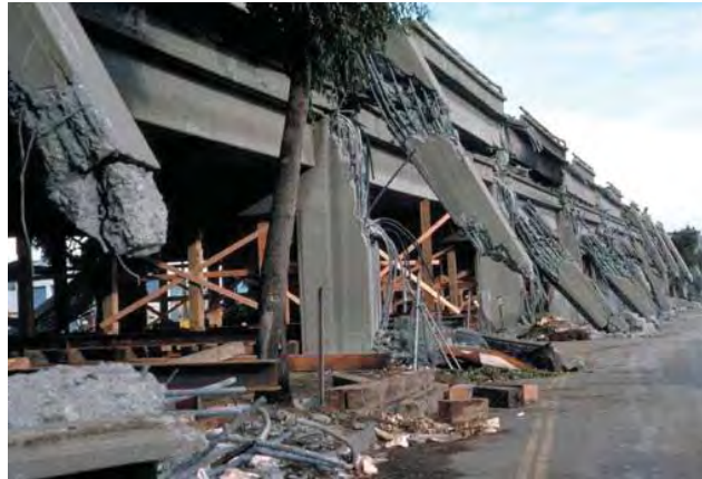
Fig. 2.9 Falla en los nodos
