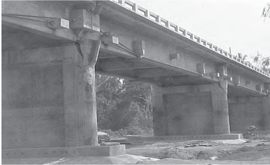
Fig. 1. 2 Daño en las pilas del puente Coahuayana durante el sismo del 21 de enero del 2003 en Colima (Cortesía del Dr. José M. Jara G.)
