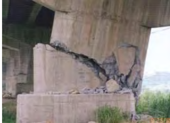
Fig. 2.8 Falla por cortante en columna de un puente ocurrida en Taiwán en el sismo de 1999
