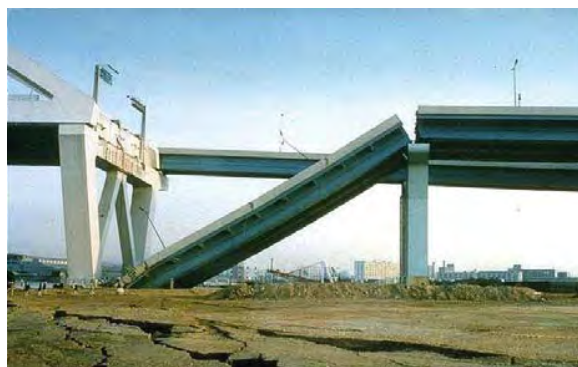
Fig. 2.1 Falla ocasionada por desplazamientos longitudinales excesivos.
