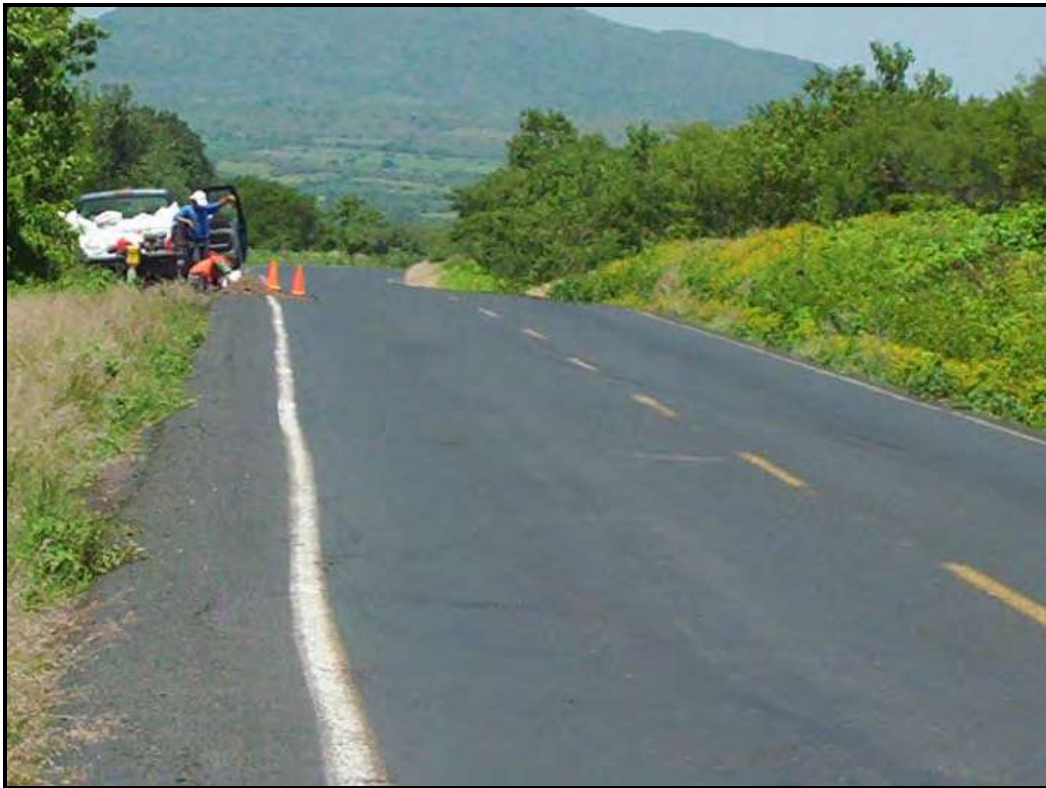
Figura 15. Sondeos tipo PCA realizados en la carretera Jiquilpan-Límites de Michoacán y Jalisco (San José de Gracia) (Fuente: Dirección General de Servicios Técnicos de la SCT, Residencia Morelia, 2005)
