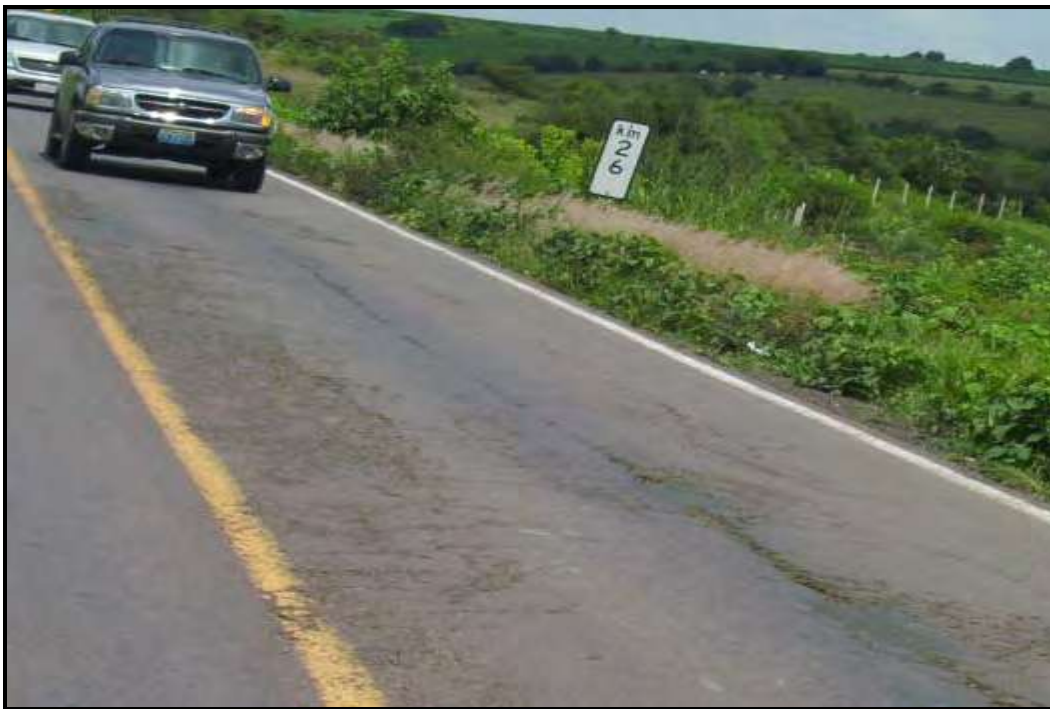
Figura 14. Estado de la carretera en el km 26+000 (Fuente: Dirección General de Servicios Técnicos de la SCT, Residencia Morelia, 2005)
