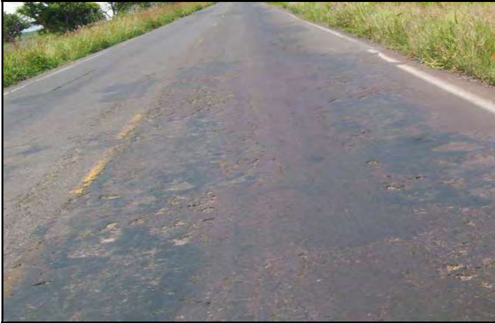
Figura 9. Estado de la superficie de rodamiento en la carretera Jiquilpan-Limites de Michoacán y Jalisco (Fuente: Dirección de Servicios Técnicos, 2005.).
