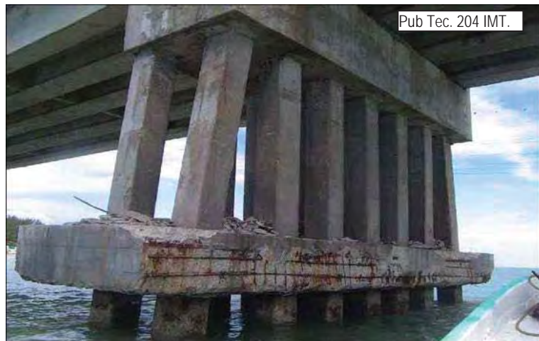
Foto 2. Foto de puente dañado por corrosión.
