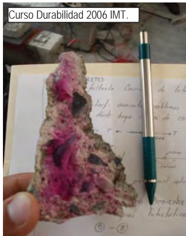
Foto 1. Pieza de concreto carbonatado.
