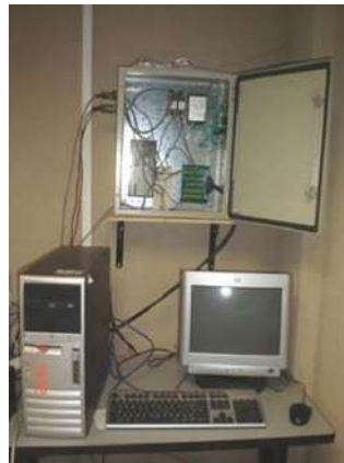
Figura 2.2 Panel de Conexión y acondicionamiento de señal
