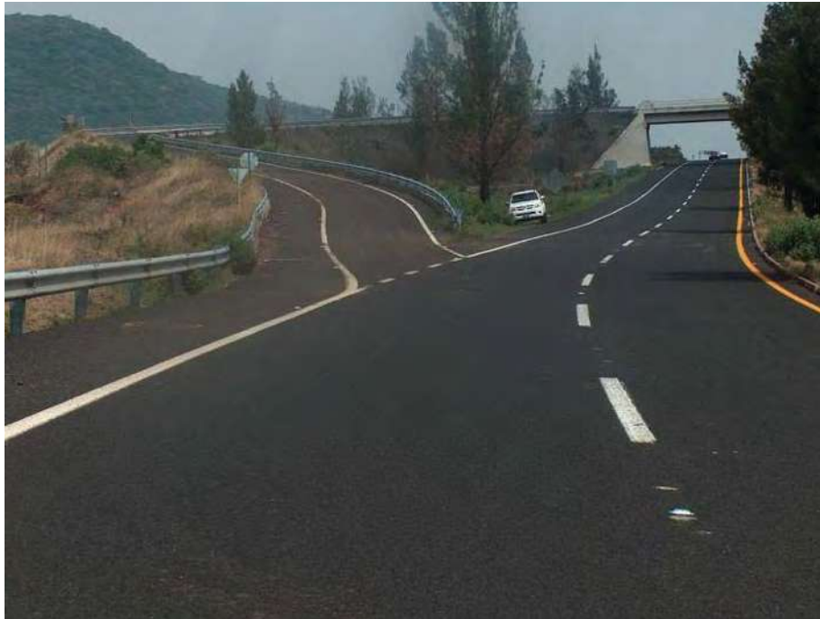
Figura 4.14 Ingreso hacia la autopista en cuerpo izquierdo sin carril de cambio de velocidad.
