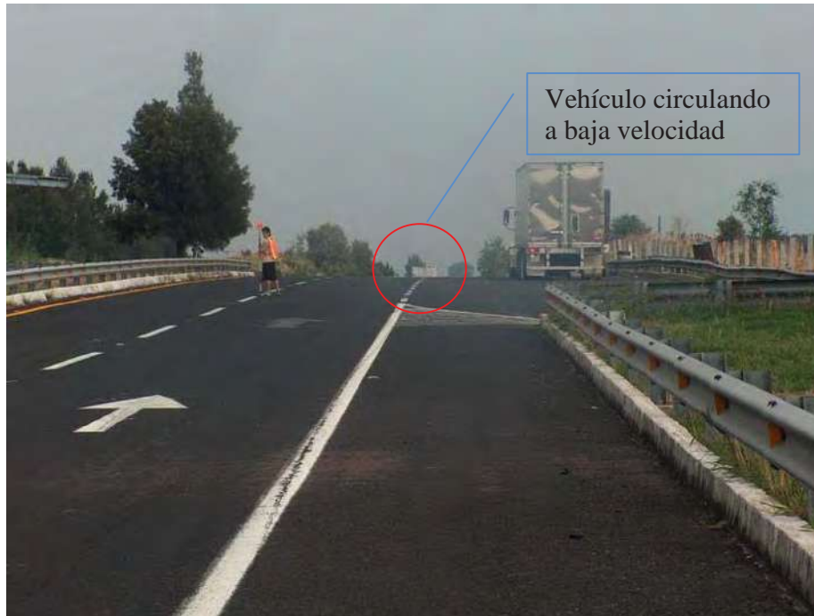
Figura 4.22 Vista del km. 390+100 hacia el km. 391+000, el cambio de pendientes es fuerte.
