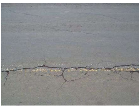
FIGURA 1.3.5 GRIETA LONGITUDINAL EN EL CENTRO
