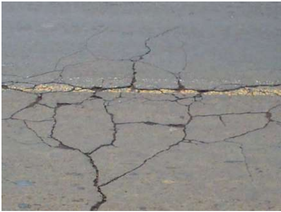
FIGURA 1.3.7 GRIETA EN FORMA DE MAPA
