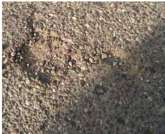
E FIGURA 1.3.3 DESPRENDIMIENTO DEL MATERIAL PÉTREO DE LA CARPETA ASFÁLTICA
