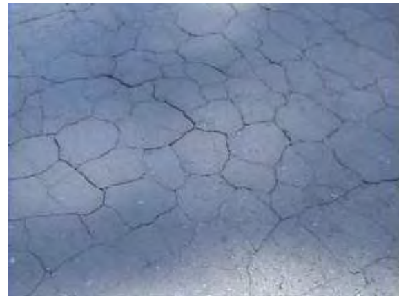
FIGURA 1.3.8 GRIETA EN FORMA PIEL DE COCODRILO
