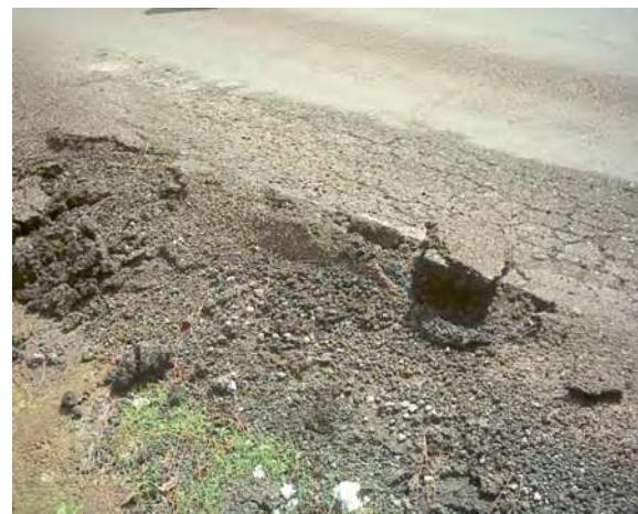
FIGURA 1.3.9 DESPLAZAMIENTO DE LA CARPETA ASFÁLTICA
