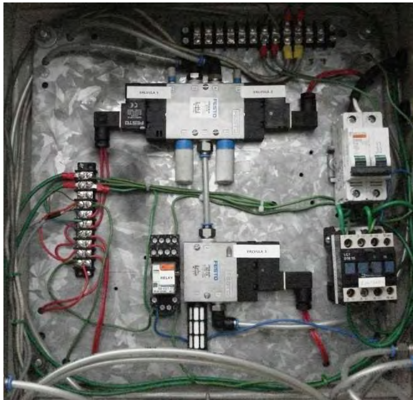
FIGURA 4.3.11 ELECTROVÁLVULAS E INSTALACIÓN ELÉCTRICA
