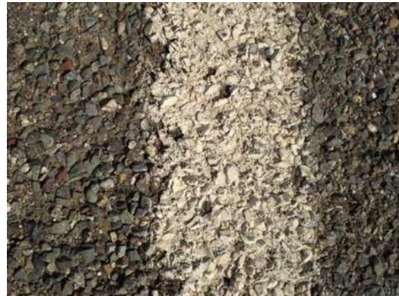
FIGURA 1.3.4 DESPRENDIMIENTO DE LA PELÍCULA DE ASFALTO DEL MATERIAL PÉTREO
