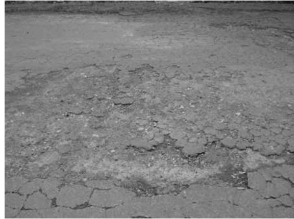
FIGURA 1.3.2 DESPRENDIMIENTO DE LA CARPETA COMO CAPA
