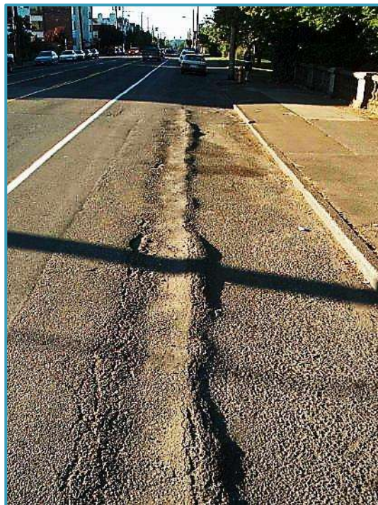
Figura 3 - Ejemplo de ahuellamiento (WAPA, 2010).
