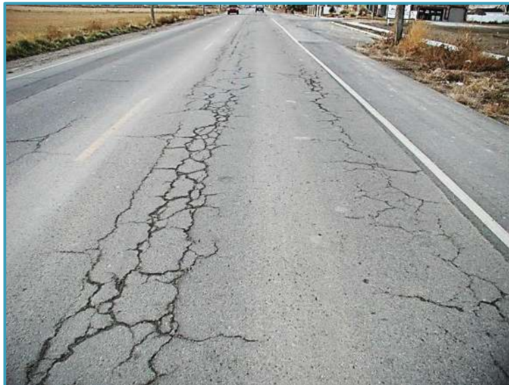
Figura 1 - Ejemplo de agrietamiento por fatiga en carretera (Romero & Myers, 2006).
