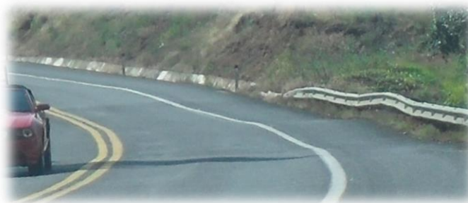
Figura 40 Peralte modificado en curva por asentamientos.
