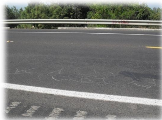
Figura 39 Carpeta asfáltica fatigada en terraplén que presenta asentamiento.
