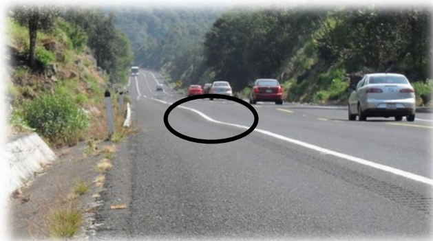
Figura 38 Asentamiento en autopista Pátzcuaro-Uruapan, km. 51+000 (25-11-11).
