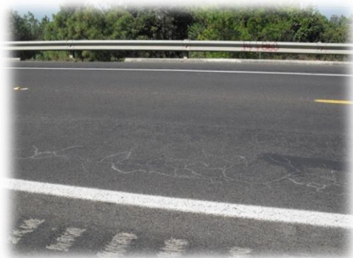
Figura 2 Carpeta asfáltica fatigada en terraplén con asentamiento.
