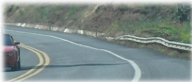
Figura 3 Peralte en curva modificado por asentamientos.
