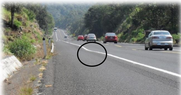
Figura 1 Pátzcuaro - Uruapan, Km 51+000. condiciones no satisfactorias.
