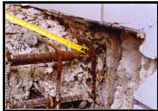
FIGURA 2.2.4 Concreto deteriorado Fuente J. A. Guzmán Torres
