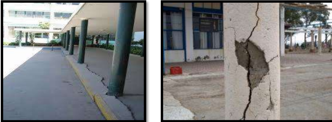
FIGURA 2.2.2 Columnas de concreto deteriorado Fuente J. A. Guzmán Torres
