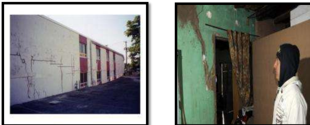
FIGURA 2.2.3 Elementos de concreto deteriorado Fuente J. A. Guzmán Torres
