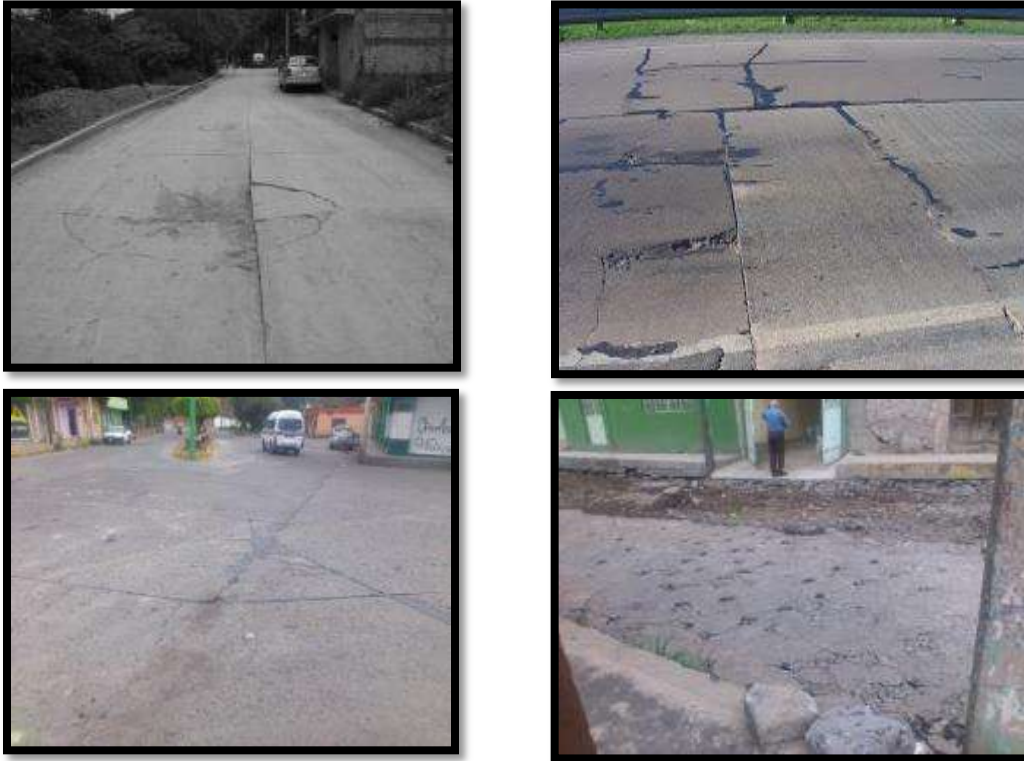
FIGURA 2.2.1 Pavimentos rígidos deteriorados
