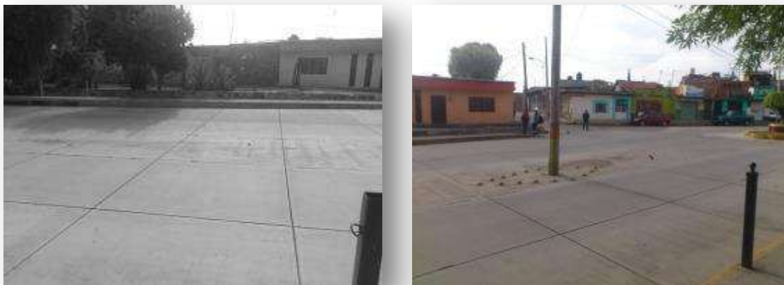
FIGURA 2.3.2 Pavimentos rígidos en buenas condiciones, parque turístico la Zarcita, Zacapu Michoacán. Fuente J. A. Guzmán Torres
