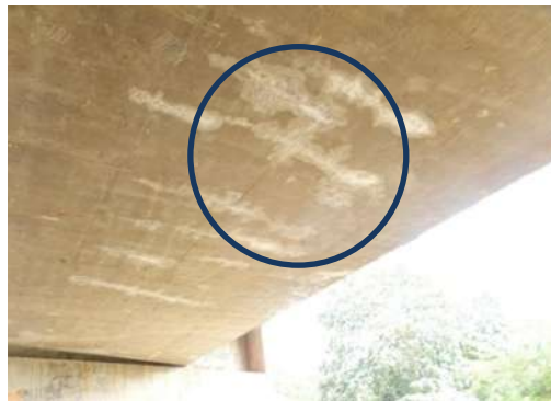
Imagen IV-1.-Daños por sulfatos en el puente La Manzanilla.
