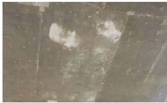
Imagen VI-12.-Manchas de humedad.
