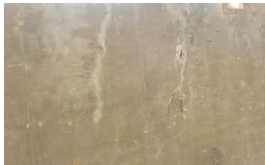
Imagen VI-30.- Delaminacion con acero expuesto.
