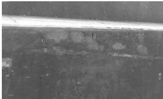
Imagen VI-18.-Manchas y acero expuesto
