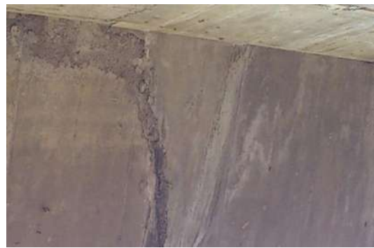
Imagen VI-17Cangrejera con manchas de humedad.
