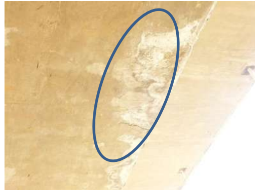
Imagen VI-8.- Manchas de humedad.
