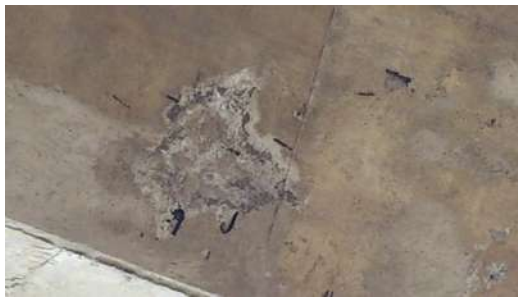
Imagen VI-23.-Manchas y acero expuesto
