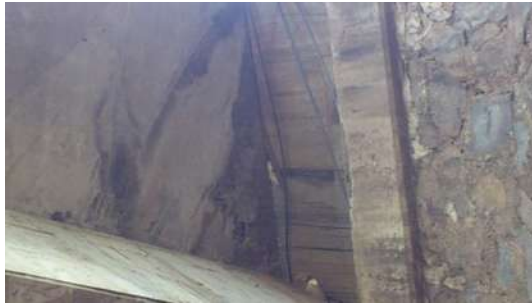
Imagen VI-27.-Delaminacion con humedad
