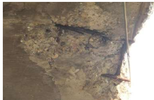
Imagen VI-29. Delaminacion con acero expuesto.
