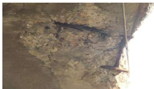
Imagen VI-15.-Desconchamiento con acero expuesto
