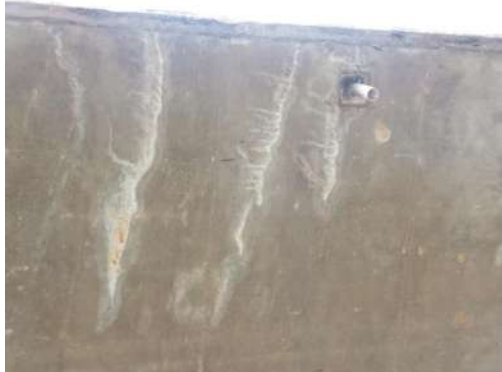
Imagen V-1.-Manchas de lixiviación en el puente La Manzanilla.
