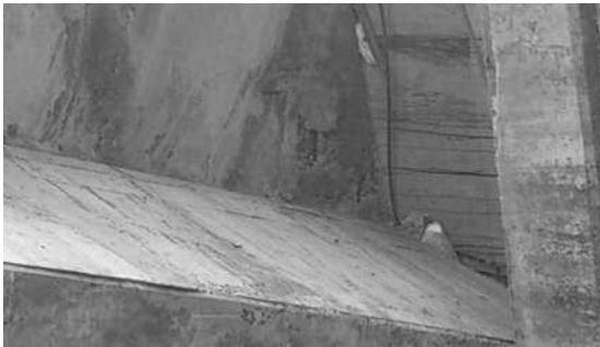
Imagen VI-28.- Delaminacion alero a tierra.
