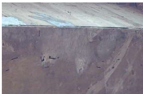
Imagen VI-20.-Reparaciones en mal estado.
