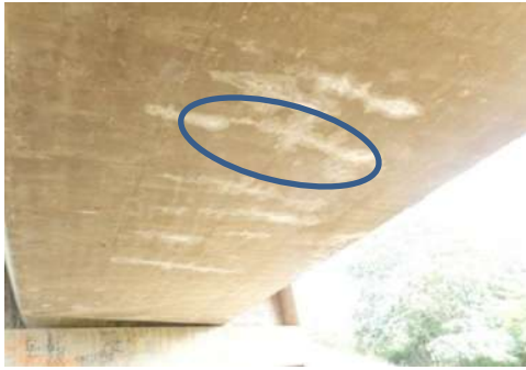
Imagen VI-5.- Grietas y manchas de lixiviación
