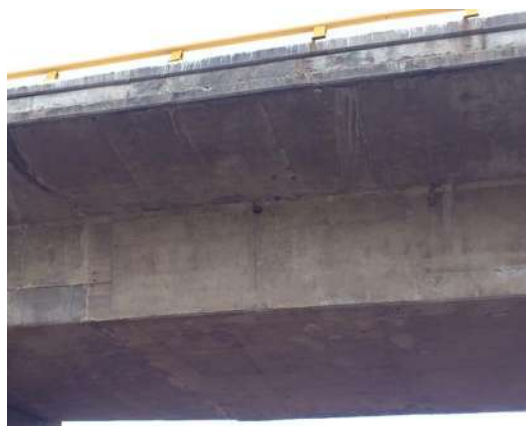
Imagen VI-25.-Desconchamiento con acero expuesto en parapeto
