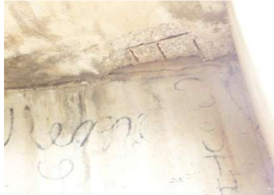
Imagen VI-4.- Delaminacion con acero expuesto.
