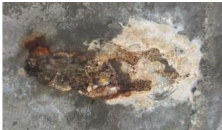
Imagen 10. Manchas de eflorescencia y óxido.
