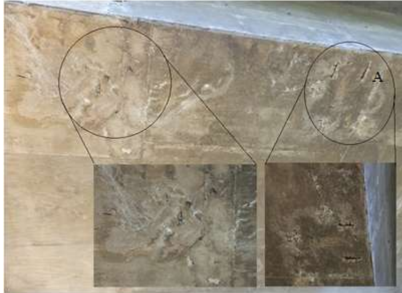
Humedad (30 x 20 cm) y lixiviación (30 x 30 cm) con acero expuesto, grietas y manchas de óxido (20 x 10 cm). Se presentan en el borde izquierdo (mar) casi finalizando el claro entre los 25 y 30 m.
