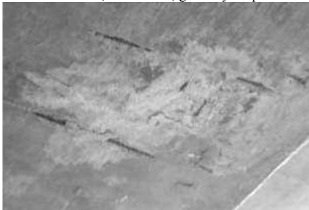
Imagen 16. Presencia de lixiviación, desprendimientos y acero expuesto.
