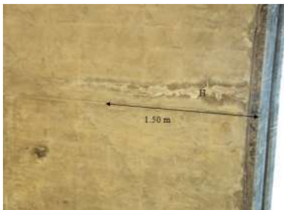
Entre los 20 y 25 m existen manchas de humedad (150 x 20), por escurrimiento.
