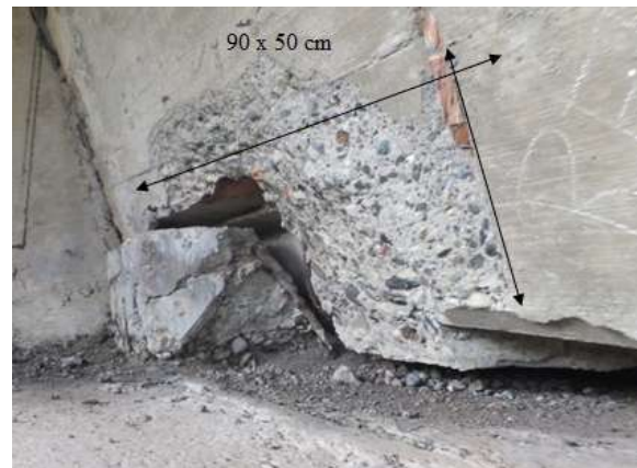
Desprendimiento (fractura 90 \times 50\text{ cm} ) con acero expuesto.
