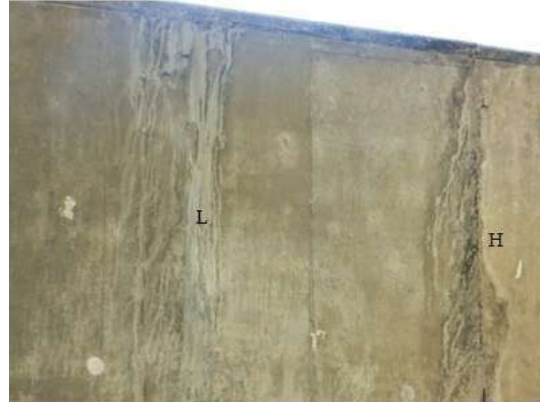
Lixiviación (120 x 30 cm) y mancha de humedad (140 x 30 cm) ubicadas entre los 25 y 30 m.
