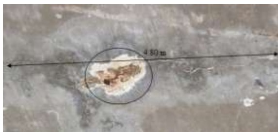
Lixiviación (480 x 150 cm) y mancha de óxido (80 x 80 cm) con acero expuesto, ubicado entre los 10 y 15 m.
