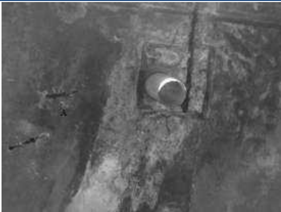
Lixiviación (100 x 20 cm) con acero expuesto, cercano al estribo 1 en los primeros 5 m.
