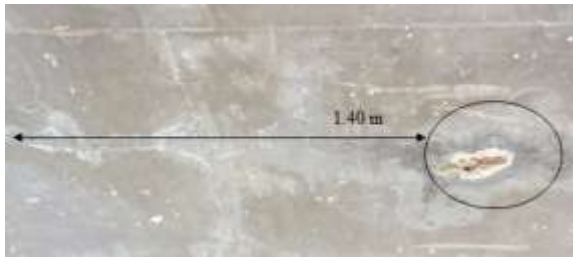
Entre los 10 y 15 m existen manchas de lixiviación (140 x 20 cm) y mancha de óxido (30 x 30 cm) con grietas.
