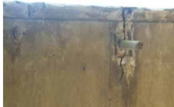
Desprendimiento (80 x 20 cm), grietas (80cm) y acero expuesto ubicado en los primeros 5 m cerca al estribo 1.
