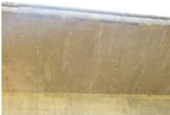
A los 20 m existen manchas de humedad (4 de 180 x 10 cm) por escurrimientos.
