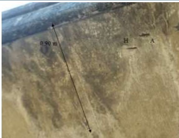
Manchas de humedad y acero expuesto (90 x 90 cm), ubicadas entre los 5 y 10 m.
