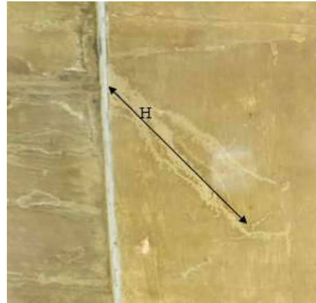
Mancha de humedad 120 x 50 cm con grietas ubicada entre los 30 y 35 m.
