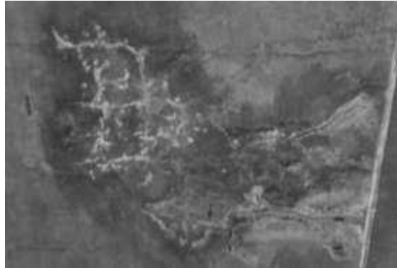
Imagen 14. Presencia de humedad, lixiviación, grietas y manchas de óxidos.
