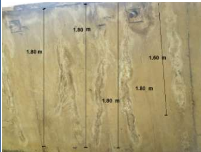
Entre los 20 y 25 m existen manchas de lixiviación (4 de 180 x 20 cm y una de 160 x 20 cm) y grietas presente a lo largo de las manchas.
