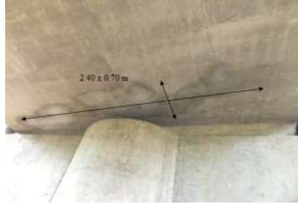
Manchas de lixiviación de 240 x 70 cm con grietas.
