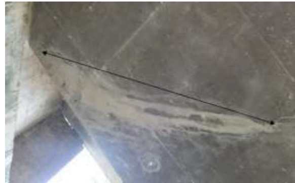
Entre los 30 y 35 m existen manchas de lixiviación (200 x 40 cm) y acero expuesto.
