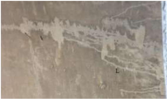
Manchas de lixiviación (120 x 40 cm) sin grietas aparentes, ubicada entre los 5 y 10 m.
