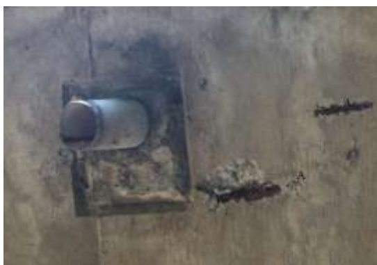
Entre los 10 y 15 m existe desconchamiento (30 x 20 cm) con acero expuesto.
