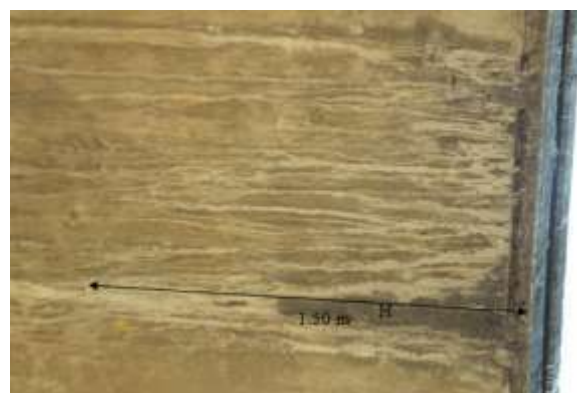
Manchas de humedad (150 x 40 cm). Por escurrimiento, ubicadas entre los 30 y 35 m.
