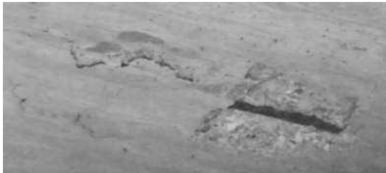
Imagen 9. Desprendimiento del recubrimiento de concreto.
