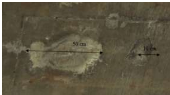
Manchas de humedad (10 x 10 cm) y lixiviación (50 x 50 cm) con grietas, se ubica entre los 5 y 10 m.
