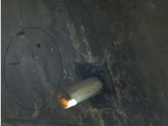
Delaminación (40 x 30 cm) a un costado del desagüe a unos 10 m.
