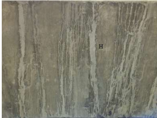
Manchas de humedad (200 x 140 cm), presentes a lo ancho del alero derecho en una zona cercana al centro del claro.
