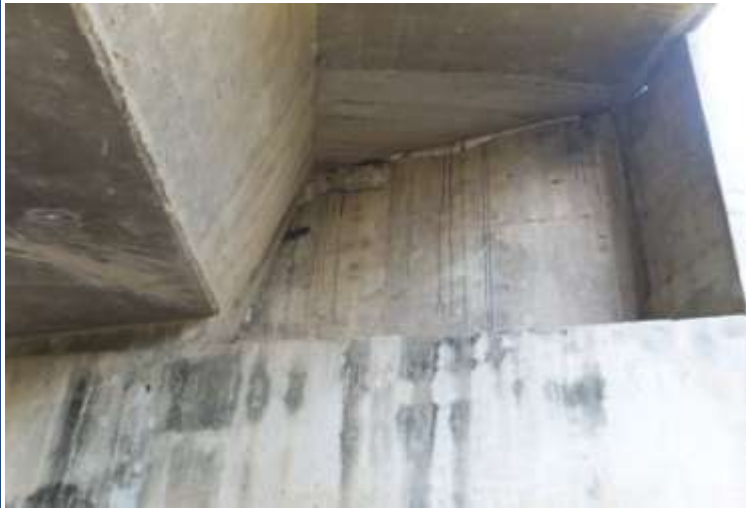
Aspecto de trabe cajón, ubicada frente al lado tierra. Mancha de humedad (300 x 120 cm.
