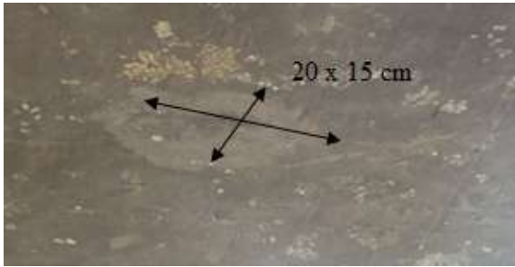
Mancha de humedad (20 x 15 cm) ubicada entre los 10 y 15 m.
