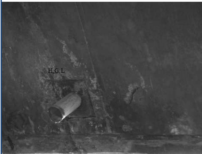
Entre los 5 y 10 m se encuentra una lixiviación (50 x 20 cm) con grietas y desprendimientos (50 x 30 cm).
