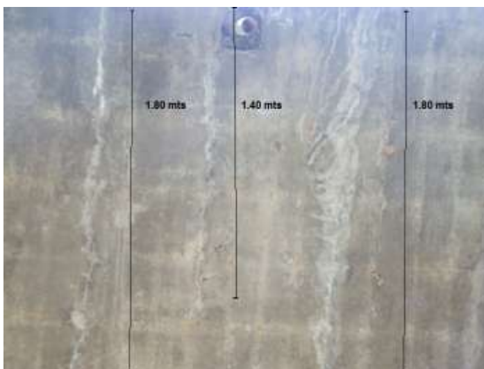
Lixiviación (180 x 20, 140 x 20, 180 x 20 cm) ubicada al final del alero izquierdo. Cerca de la pila III, entre los 30 y 35 m.
