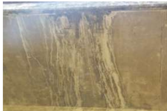
Existe una mancha de humedad (200 x 200 cm) con lixiviación, por escurrimientos ubicada entre los 20 y 25 m.
