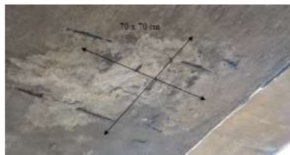
Dentro de los 5 y 10 m se ubica un desconchamiento (70 x 70 cm) con acero expuesto.
