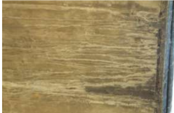
Imagen 15. Presencia de humedad, lixiviación, grietas y desprendimientos de concreto.
