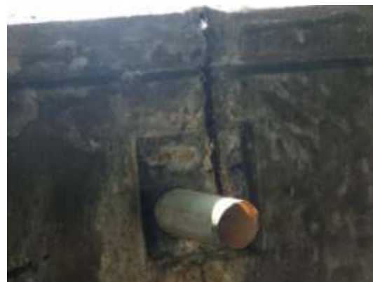
Lixiviación (100 x 20 cm) con acero expuesto y grieta (80 cm) encontrada entre los 5 y 10 m.
