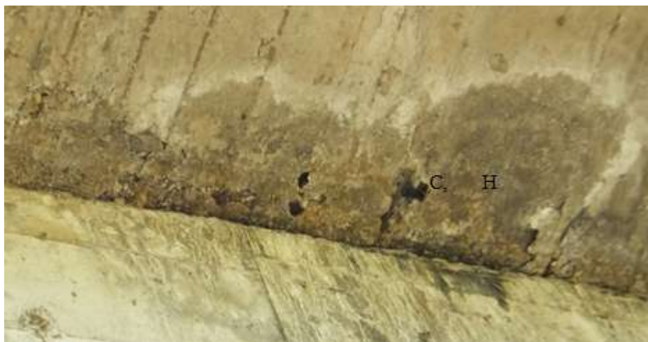
Entre los 25 y 30 m se encuentra humedad (150 x 50 cm) con presencia de cangrejas y lixiviación (120 x 60 cm).
