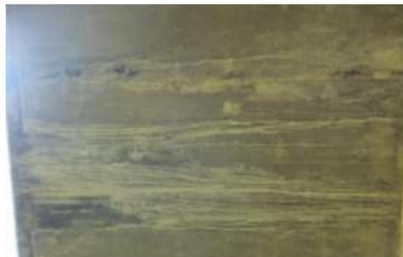
Entre los 30 y 35 m existe una mancha de humedad (200 x 100 cm) con lixiviación presente, por escurrimiento.
