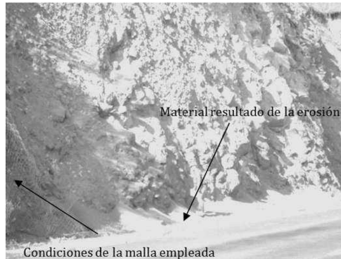
Figura 5.4.- Condiciones de erosión del talud izquierdo ubicado en el km 237+000 de la autopista México-Guadalajara.
