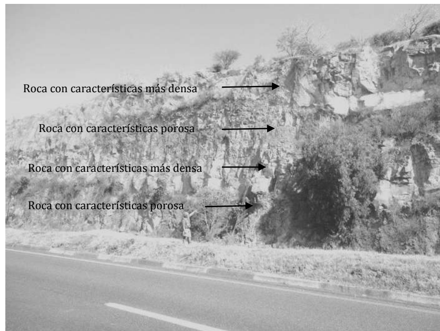
Figura 5.2.- Composición estratigráfica del talud derecho ubicado en el km 232+000 de la autopista México-Guadalajara.
