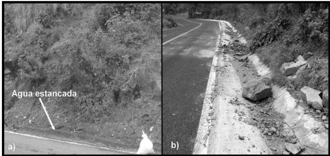
Figura 6.23.- Cuneta en la zona del talud “Los Cantiles 2”: a) acumulación de agua. B) Rellena por fragmentos de roca y material fino.
