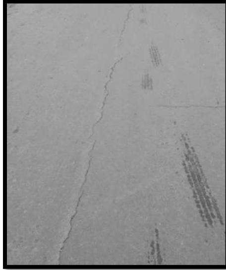
Figura 1.3. Falla por agrietamiento.
