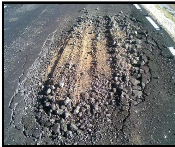
Figura 1.7. Falla por disgregación.
