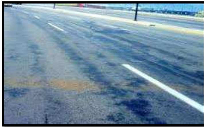
Figura 1.8. Falla por alisamiento.
