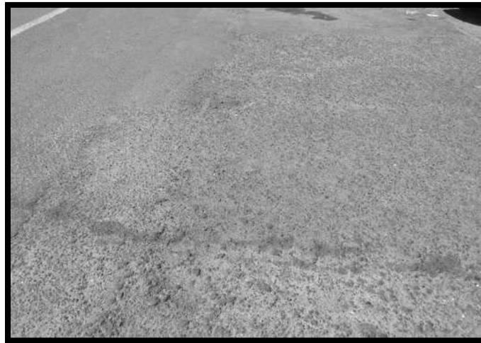
Figura 1.6. Falla por desprendimiento.
