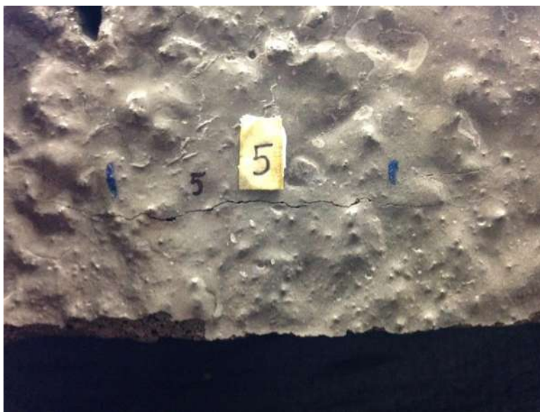
Figura 3.7. Grieta en el concreto en el mismo sentido que el refuerzo.
