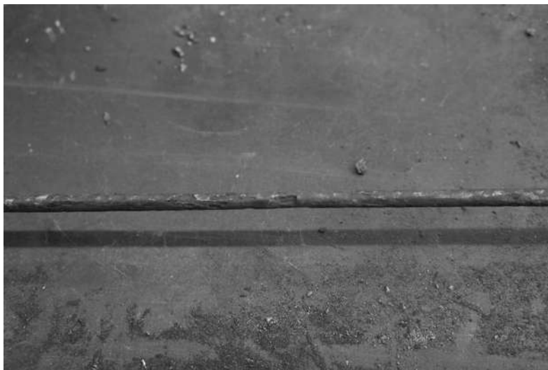
Figura 6.7. Zonas activas por corrosión con óxidos rojizos en el acero de presfuerzo.
