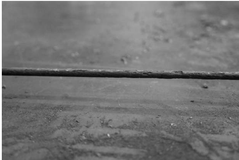
Figura 44. Zona Activa por corrosión en acero de pre-esfuerzo
