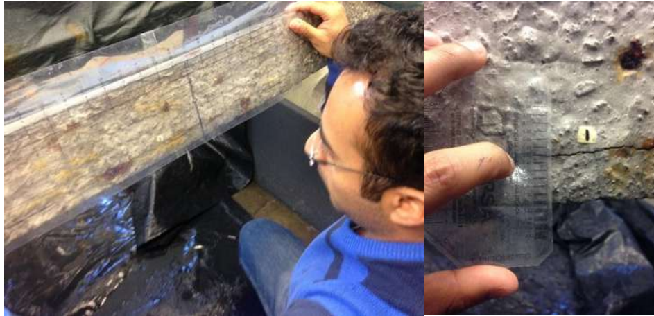
Figura 22. Medición de grieta (largo- ancho)
