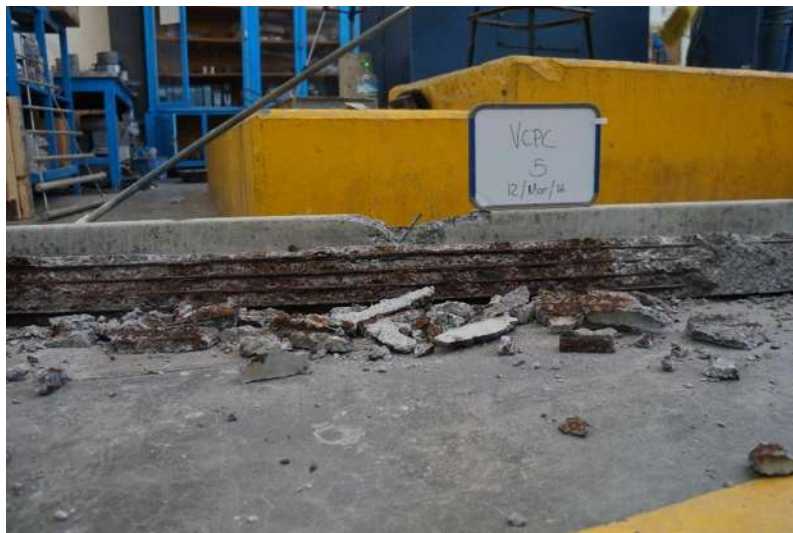
Figura 43. Zona afectada por corrosión en el acero de pre-esfuerzo.
