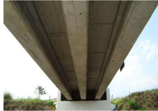
Fotografía 3.11 Superestructura formada por losa de concreto reforzado en colaboración con vigas de concreto presforzado.
