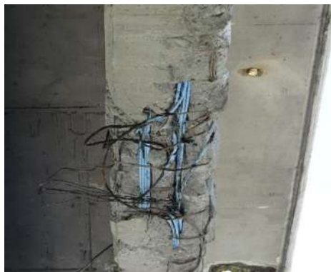
Fotografía 5.4 Trabe extrema derecha del tramo 2-3 con daño severo por impacto vehicular, con acero de refuerzo y presfuerzo roto.
