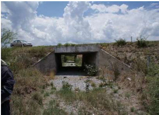
Fotografía 4.12 Alcantarilla formada por losa maciza de concreto y Estribos con aleros a 30°.
