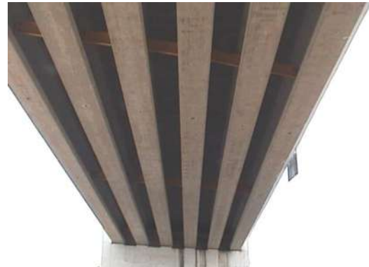
Fotografía 4.5 Superestructura formada por losa de concreto reforzado en colaboración con vigas de concreto presforzado.
