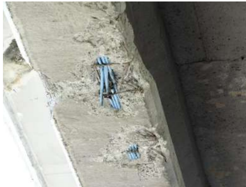
Fotografía 5.3 Trabe extrema izquierda del tramo 1-2 con acero de presfuerzo expuesto y roto.
