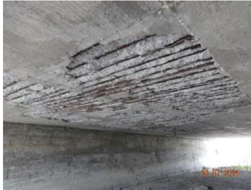
Fotografía 5.10 Desconche generalizado en la parte inferior de la losa por la corrosión del acero de refuerzo, el recubrimiento se ha perdido en más del 50%.
