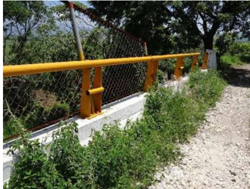
Fotografía 5.5 Tubos del parapeto del lado derecho cortados en el tramo 1-2.
