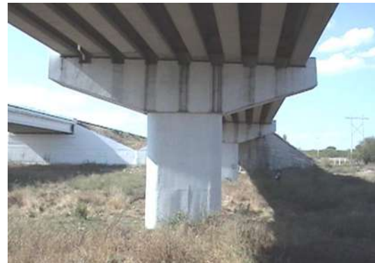
Fotografía 4. 25 Pila intermedia formada por una columna de sección constante y cabezal en doble volado de concreto reforzado.
