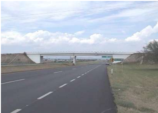
Fotografía 4.8 P.I.V. Formado con Estribos de concreto reforzado con aleros en "U" en los extremos y Caballetes intermedios.
