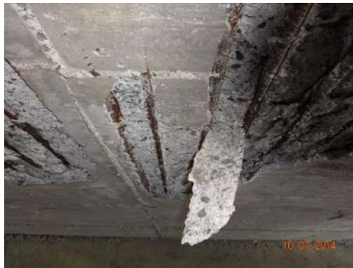
Fotografía 5.11 Acero corroído y pérdida de recubrimiento en la parte inferior de la losa.
