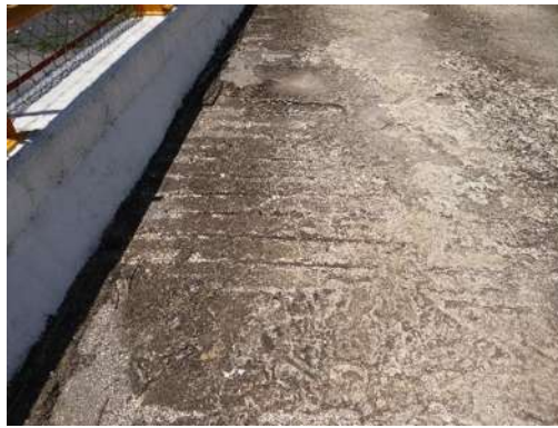
Fotografía 5.6 Acero de refuerzo expuesto en la superficie de rodamiento en diversas zonas.
