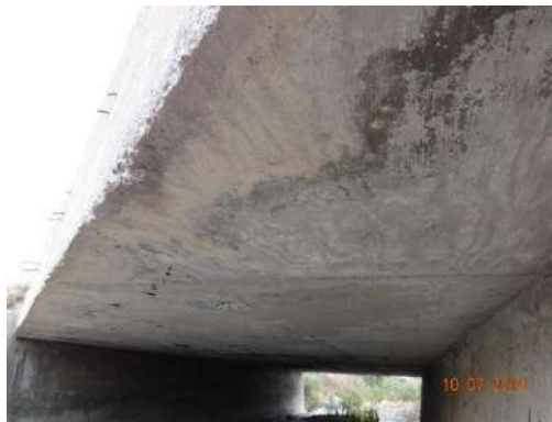
Fotografía 5.8 Parte inferior de la losa, en donde se observan manchas de humedad.
