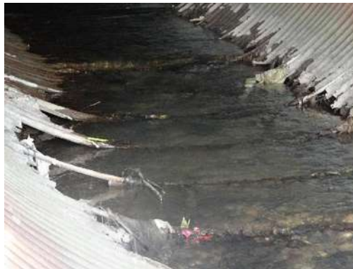
Fotografía 5.1 Tubo metálico corroído y roto en la parte baja.
