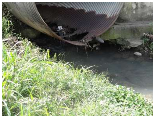
Fotografía 5.2 Erosión debajo del tubo.
