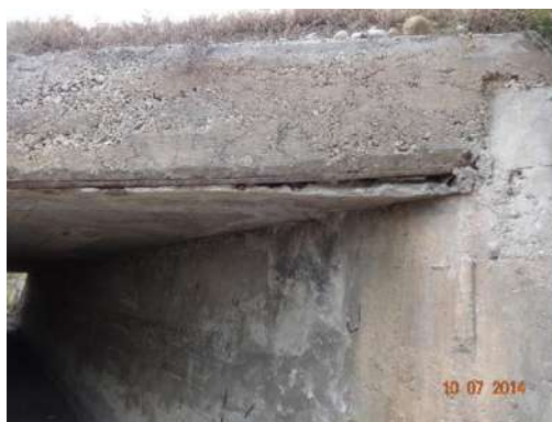
Fotografía 5.9 Se observa acero de refuerzo expuesto en uno de los extremos de la parte inferior de la losa.
