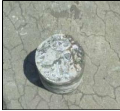
Figura 10. Fallas por reacción álcali agregado. Fuente: ARGOS
