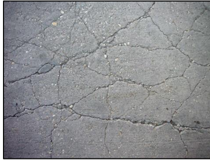
Figura 12. Fisuración en forma de "D". Fuente: propia.
