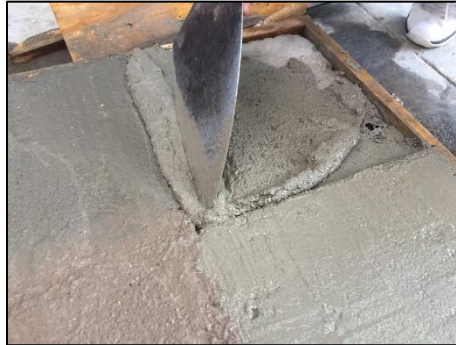
Figura 66. Colocación y acabo de las pastas de mortero en cada cuadrante. Fuente: propia.
