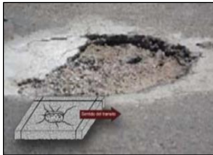
Figura 9. Bache generado en la losa de concreto. Fuente: ARGOS
