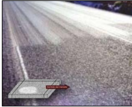
Figura 8. Peladuras en la losa de concreto. Fuente: ARGOS
