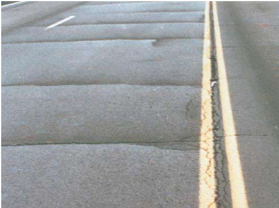
Fig. 2-2 Agrietamiento por reflexión (Miller & Bellinger, 2014)
