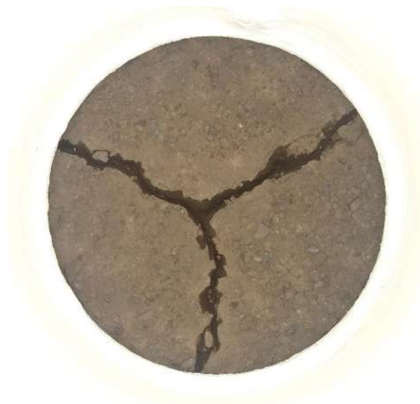
Fig. 4-3 Fotografía de grieta en las pruebas del Estacionamiento de Rectoría de la UMNSH
