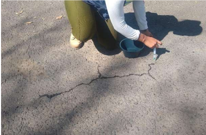
Fig. 3-26 Humedecimiento de grietas
