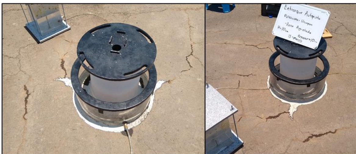
Fig. 4-12 Flujo en grietas aledañas durante prueba “Entronque Autopista 5”
