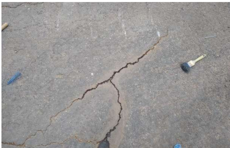
Fig. 4-9 Agrietamientos observados en el Entronque de la Carretera Federal 14D
