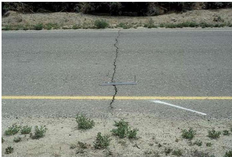
Fig. 2-4 Agrietamiento transversal (Miller & Bellinger, 2014)
