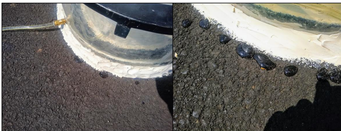
Fig. 4-15 Brote del agua a la superficie en los pavimentos de la autopista
