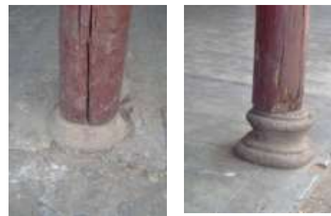
Imagen 72: Estado de deterioro de las columnas de los portales. Fuente: Foto de Citlali Carrillo.
