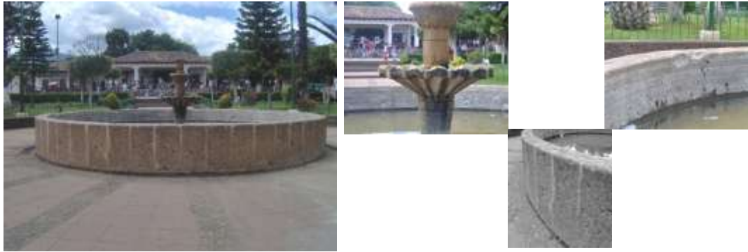
Imagen 66: Estado de deterioro de la fuente. Fuente: Foto de Citlali Carrillo.
