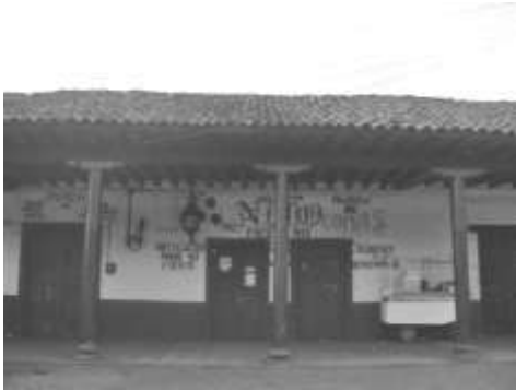
Imagen 69: Muros que presentan alteraciones debido a la inserción de instalaciones y anuncios publicitarios. Fuente: Foto de Citlali Carrillo.
