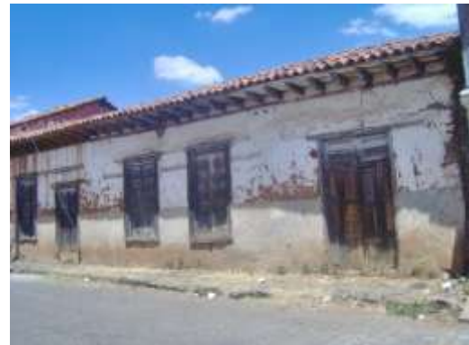
Imagen 45: Vista de una fachada de una vivienda tradicional, que actualmente se encuentra abandonada y destruida en su interior.
