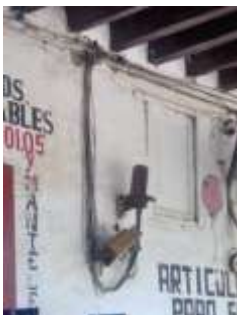
Imagen 71: Instalaciones sobre los muros, provocando la acumulación de mugre y polvo. Fuente: Foto de Citlali Carrillo.
