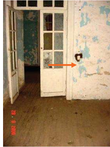
Imagen 15. Detalle de instalación eléctrica. Foto: Rafael López Morales
