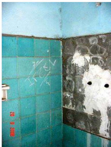
Imagen 13. Detalle de instalación hidráulica. Foto: Rafael López Morales
