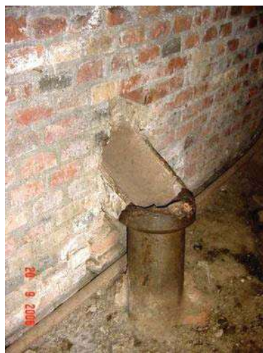
Imagen 14. Detalle de instalación sanitaria. Foto: Rafael López Morales
