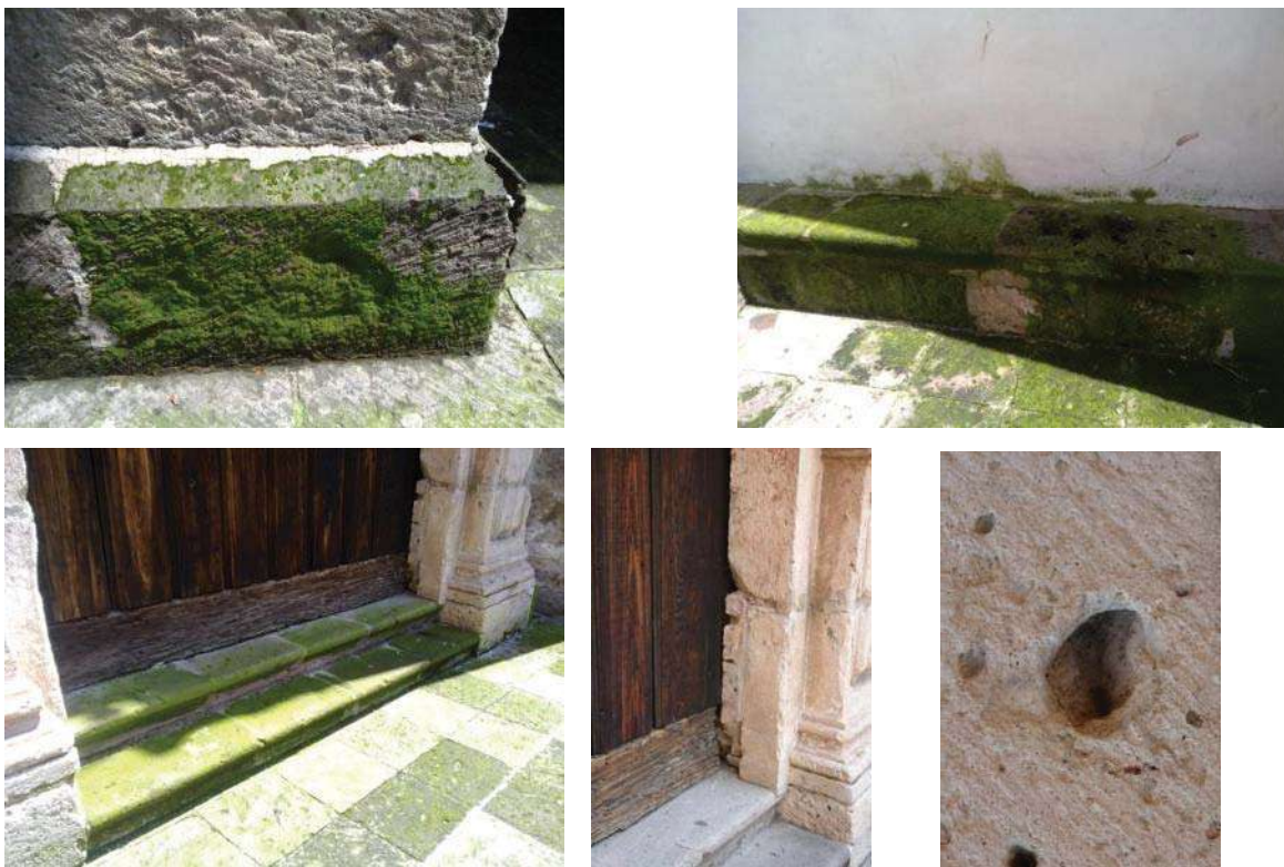
Fig. 73-77 Muestran deterioros generados sobre los muros de las fachadas del templo. Foto Yadira C. Avila
