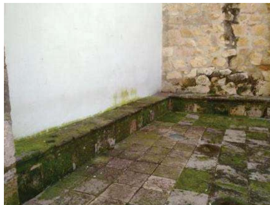
Fig. 66. Presencia de moho producto de la humedad existente en el área del atrio. Tomada por Yadira C. Avila.
