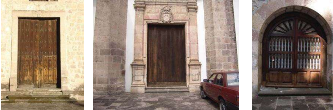
Fig. 87, 88, 89. Deterioros en puertas, foto Yadira C. Avila Naranjo
