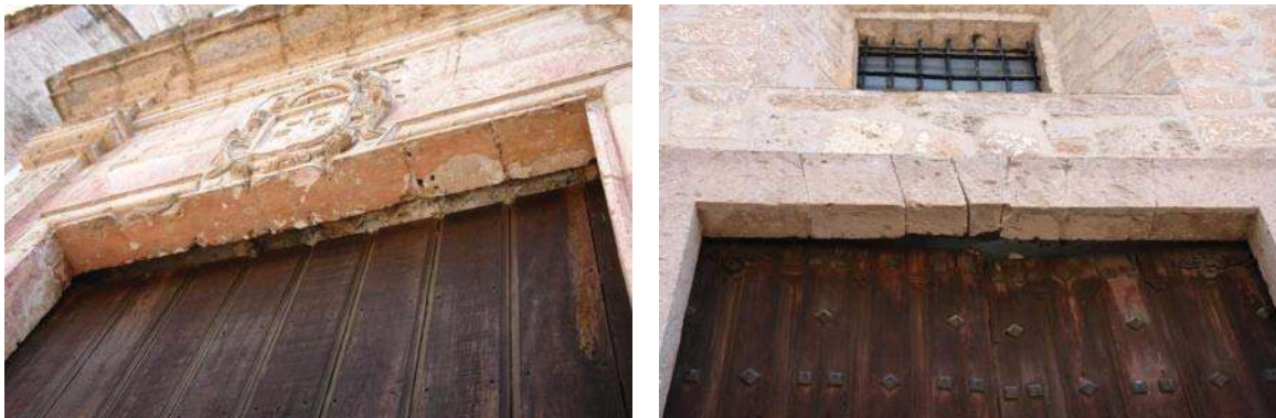
Fig. 83, 84. Deterioros sobre dinteles, foto Yadira C. Avila Naranjo
