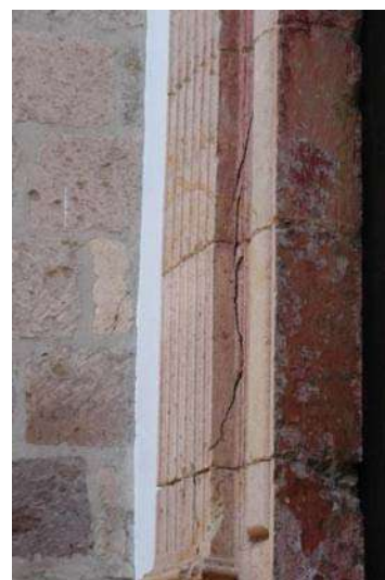
Fig. 67 muestra grieta sobre fuste de pilastra adosada, en la portada lateral del templo. Foto Yadira C. Avila
