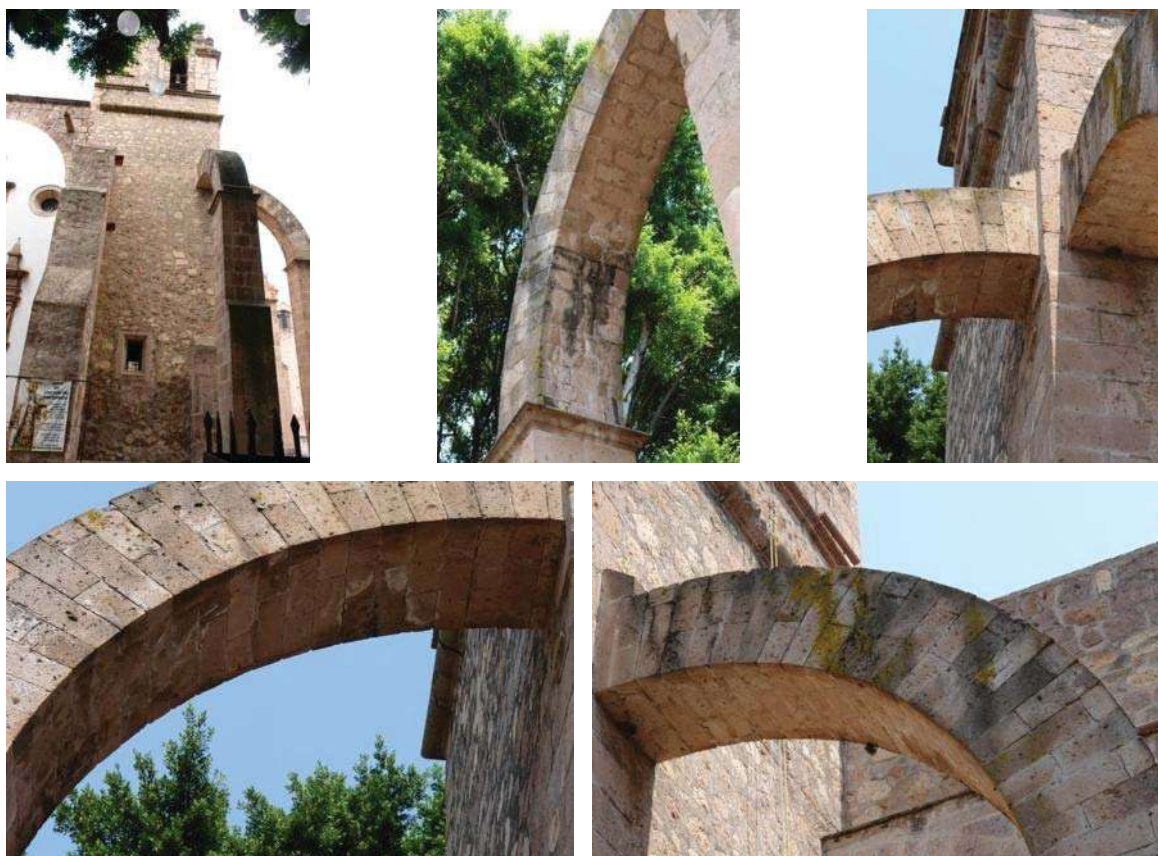
Fig. 78-82 Deterioros presentados sobre arcos botareles, foto Yadira C. Avila.
