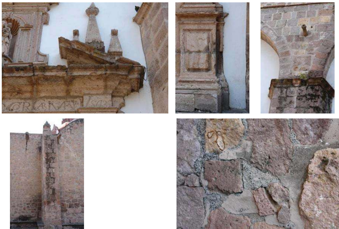
Fig. 68-72 Muestran deterioros generados sobre los muros de las fachadas del templo. Foto Yadira C. Avila
