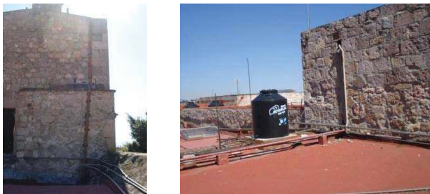
Fig. 90, 91. Instalaciones existentes, foto Yadira C. Avila Naranjo
