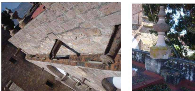
Fig. 85, 86. Deterioros en gárgolas y pináculos, foto Yadira C. Avila Naranjo
