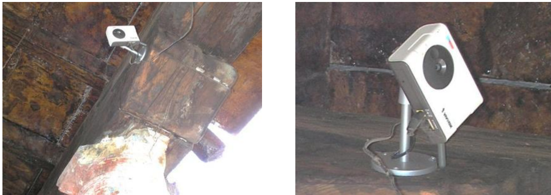
Imagen 70. Una de las cámaras de vigilancia colocada en el corredor poniente como parte de la instalación especial. Fotos: Eder García.
