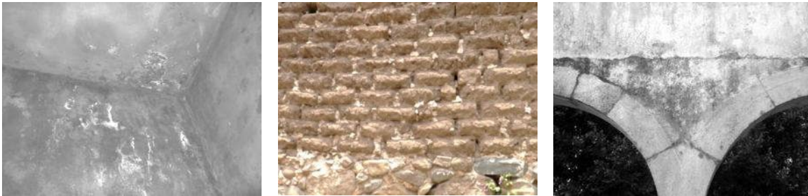
Imagen 81. Ejemplos de deterioro por agentes abióticos: sales solubles en agua (izquierda) con la aparición de eflorescencias; viento (centro) y la erosión de juntas; y luz (derecha) con la pérdida de color en pintura.
