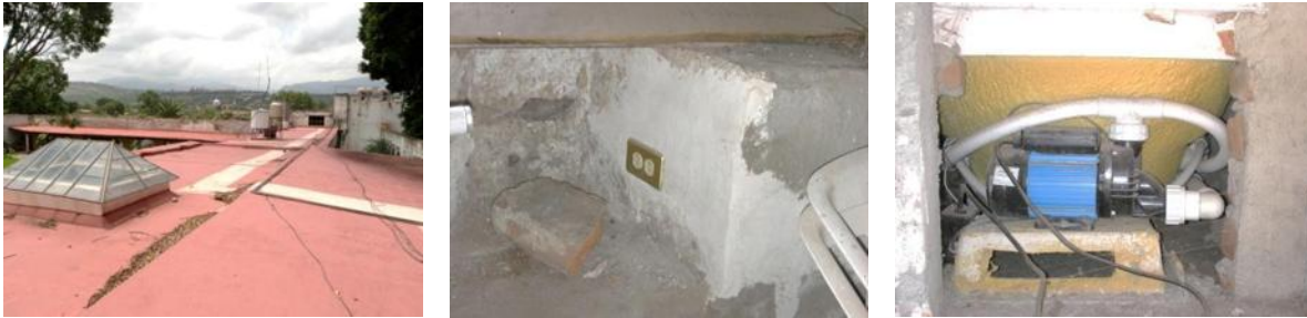
Imagen 69. Algunos elementos de la instalación eléctrica, la distribución del cableado en azotea (izquierda), el acomodo de los elementos en las habitaciones (centro), hasta la implementación para situaciones de nuevo uso (derecha). Fotos: Eder García.
