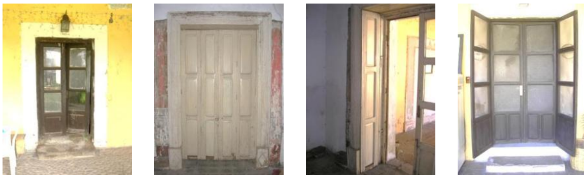
Imagen 75. Detalles de las puertas y ventana en corredores; la puerta exterior de vidrio (izquierda), la puerta interior de madera (centro izquierda), el pliegue de las hojas para ocultarse en los marcos (centro derecha), y la tercera puerta agregada en los sanitarios (derecha). Fotos: Eder García.
