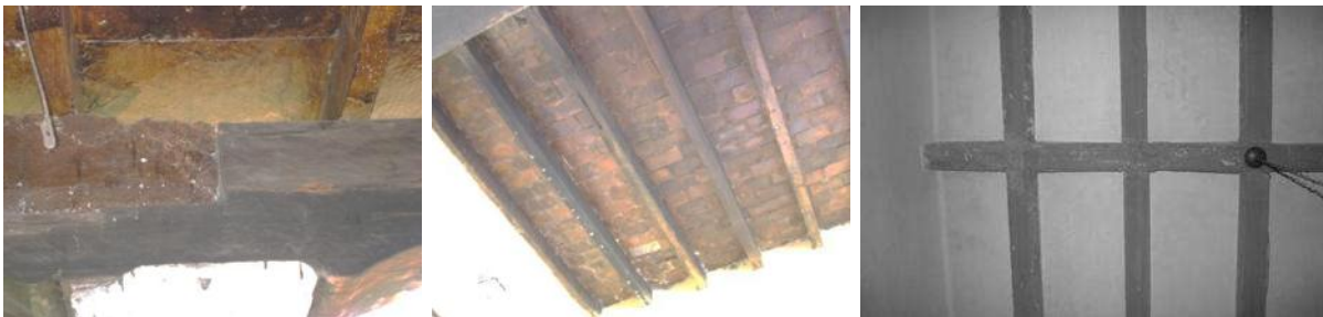
Imagen 86. Las alteraciones al sistema de cubiertas es una de las alteraciones más significativas del espacio, teniendo como principales sustitutos los sistemas de concreto armado, ya sea construidos en obra o prefabricados.
