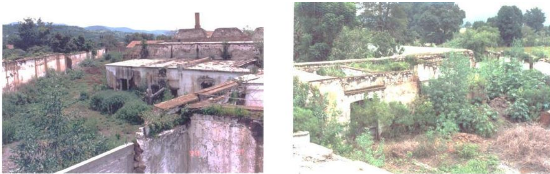
Imagen 39. Fotografías del estado en que se encontraba la Casa del Hacendado alrededor de 1990, en donde observan las habitaciones anexas del costado suroeste (izquierda) y el deterioro de las habitaciones del costado sureste donde se prepararon las instalaciones para la construcción de núcleos sanitarios (derecha).
