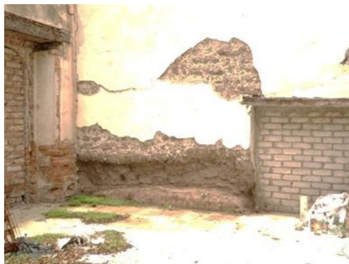
Imagen 94. Fotografía de la debilitación estructural en la parte inferior del muro oriente de la habitación noreste y el potencial peligro que representa. Foto: Eder García
