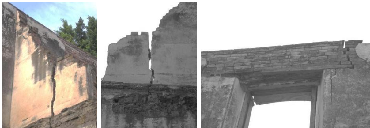
Imagen 89. La zona noreste es la que presenta el daño más considerable, grietas que derivan de un desplome en el muro provocado por la falta de soportes y refuerzos. Fotos: Eder García.
