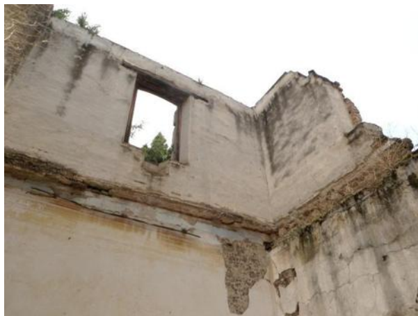
Imagen 96. La habitación noreste es el espacio estructuralmente más afectado, la falta de cubiertas (tanto de entrespiso como de azotea), la pérdida de secciones de muros, el agrietamiento y desplome de otros, son algunos de los problemas que se presentan en esta zona. Foto: Eder García.
