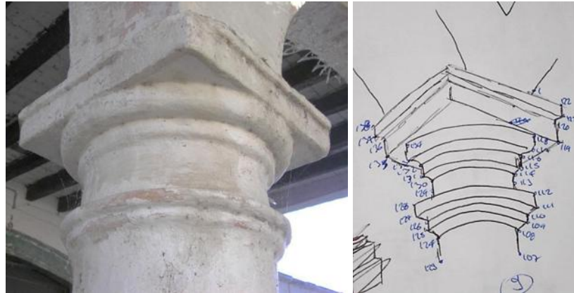
Imagen 25. Fotografía del capitel de una de las columnas del pórtico de acceso y croquis al que sirvió como complemento para el levantamiento con la estación total; algunas veces se dejan de lado detalles en el levantamiento o éstos no son muy claros y pueden ser confirmados mediante las fotografías comparativas. Foto y dibujo: Eder García.
