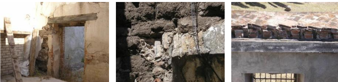
Imagen 83. Algunos ejemplos de efectos de deterioro localizados en la Casa del Hacendado, como son puerta faltante, juntas erosionadas y pérdida de la cubierta. Fotos: Eder García.
