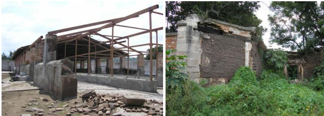
Imagen 4. El grado de deterioro en el que se encuentran algunos espacios de la hacienda como los nacheros (izquierda) o las calpanerías (derecha), solo por mencionar algunos ejemplos, requieren de un proyecto de restauración que contemple una fuerte inversión económica lo que dificulta la realización del mismo. Fotos: Eder García.
