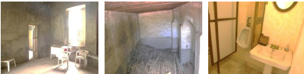
Imagen 85. La falta de uso, la falta de mantenimiento y la alteración del espacio, constituyen los tres principales factores de deterioro antrópico, como principal agente. Fotos: Eder García.
