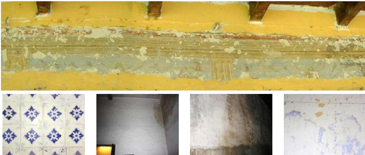
Imagen 64. Algunos terminados en muro. Arriba: pintura a la cal y debajo de ella restos de pintura mural. Abajo y de izquierda a derecha: mosaico de pasta, yeso, aplanado de cemento aparente, aplanado de cal. Fotos: Eder García.
