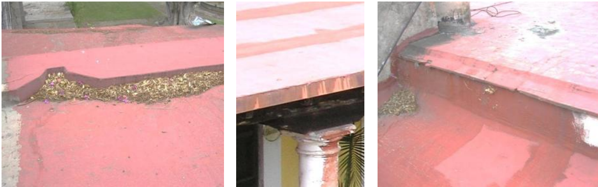
Imagen 71. Algunos de los elementos de instalación pluvial de la casa, como los desagües (izquierda), goteros (centro) y chaflanes (izquierda). Fotos: Eder García.
