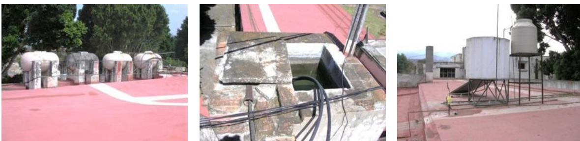
Imagen 66. Abastecedores de la red hidráulica de la casa, en primer lugar los que alimentan al edificio ubicados en la azotea de la troje anexa (izquierda y centro), y los tinacos que distribuyen el agua en la casa (derecha). Fotos: Eder García.
