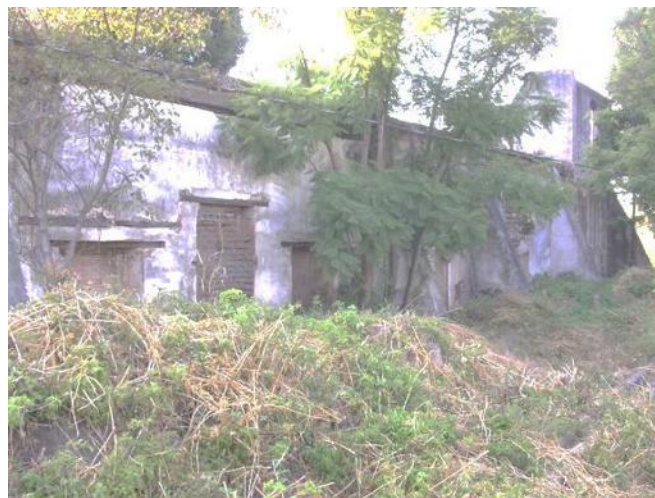
Imagen 19. Restos de las habitaciones correspondientes al desaparecido corredor oriente de la casa, una de las observaciones realizadas durante las visitas posteriores a la hacienda; esta zona no fue contemplada en el croquis inicial debido al desconocimiento de su existencia en ese momento. Foto: Eder García.
