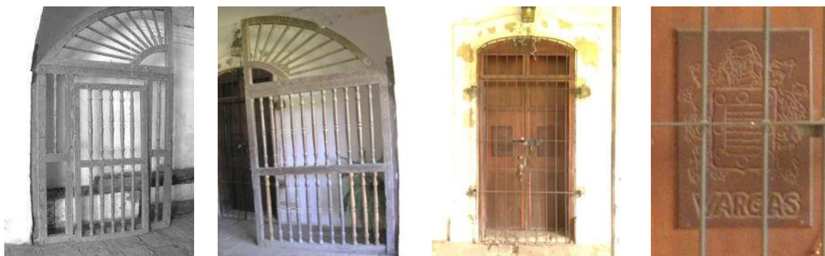
Imagen 77. Fotos de la reja del zaguán (izquierda) y la puerta de acceso a la oficina donde están grabados los escudos de la familia Vargas, últimos propietarios de la hacienda (derecha). Fotos: Eder García.
