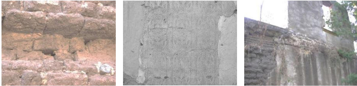
Imagen 88. Algunos de los daños derivados por la falta de cubierta son la erosión, pérdida de color en pinturas y proliferación de macro y microflora. Fotos: Eder García.
