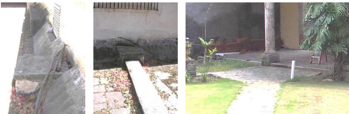
Imagen 68. Instalación sanitaria de la Casa del Hacendado, fosa séptica ubicada en el patio de la casa (derecha), y registro y tubería de desagüe a la fosa del patio central de la hacienda. Fotos: Eder García.
