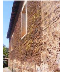
Imagen 105 Falta de aplanados
