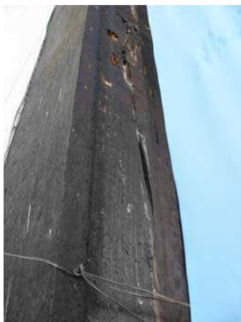
Imagen 112 Agrietamiento en la pilastra
