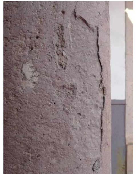
Figura 97.- Deterioros en columnas de cantería. Foto: Alelí Cortés.
