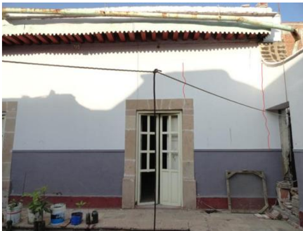
Figura 103.- Grieta en muro poniente del patio posterior. Foto: Alelí Cortés.
