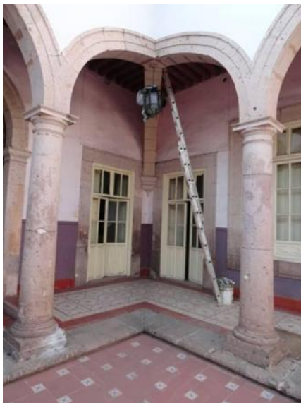
Figura 4.- Arco cruzado en “pata de gallo” elemento constructivo característico de la vivienda local que surge en el siglo XVIII.
