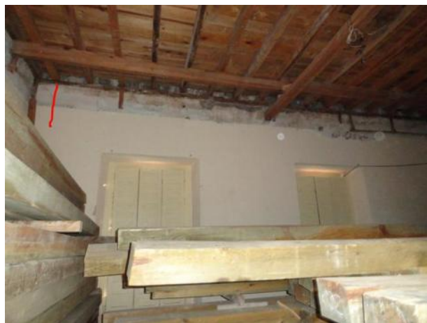
Figura 100.- Grieta en el muro sur del Local 3. Foto: Alelí Cortés.
