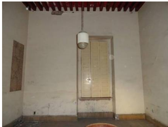
Figura 42.- Luminaria de instalación eléctrica. Foto: Alelí Cortes
