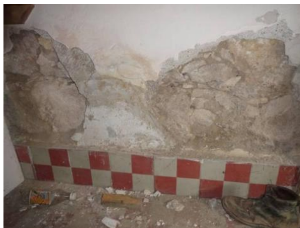
Figura 95.- Humedades en el área de sanitarios. Foto: Alelí Cortés.
