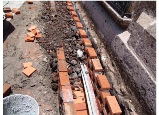
Figura 67. Muestra una cimentación más amplia al espesor del muro de una vivienda ubicada en la calle Corregidora del Centro Histórico de Morelia, Mich. Autor: Alelí Cortés Vargas
