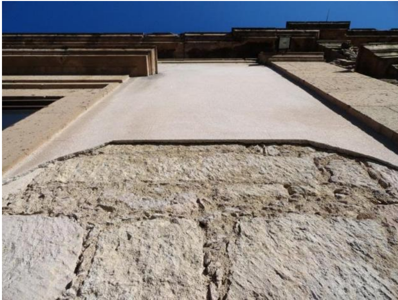
Figura 90.- Desprendimiento de aplanados en fachada. Foto: Alelí Cortés.
