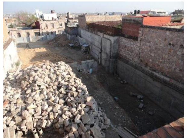
Figura 104.- Área demolida en la parte posterior de la vivienda. Foto: Alelí Cortés.
