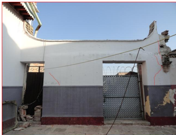
Figura 105.- Grieta en muro norte del patio posterior. Foto: Alelí Cortés.
