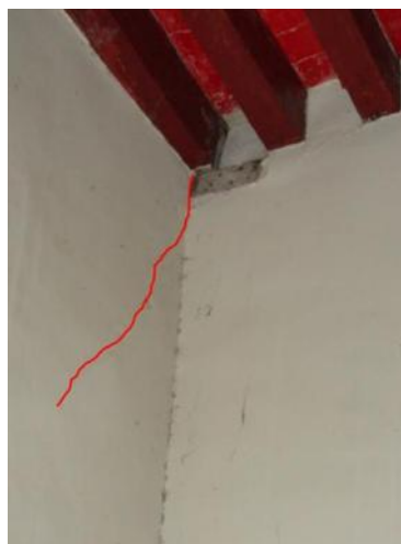
Figura 102.- Grieta en muro norte del Local 14 Foto: Alelí Cortés.
