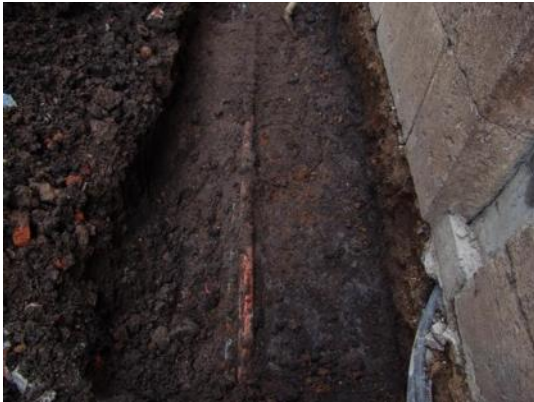
Figura 66. Muestra una cimentación que corresponde a la continuación del muro de una vivienda ubicada en la calle Corregidora del Centro Histórico de Morelia, Mich Autor: Alelí Cortés Vargas
