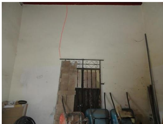
Figura 101.- Grieta en muro poniente del Local 14 Foto: Alelí Cortés.
