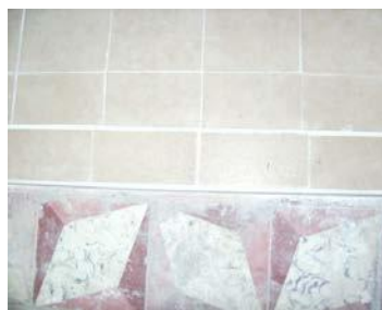
Fig. 47. Detalle de pisos de mosaico de pasta existente en la mayoría de los espacios con diferentes diseños y colores y loseta cerámica colocada recientemente en dos de los baños. Foto: Elvia Gutiérrez.
