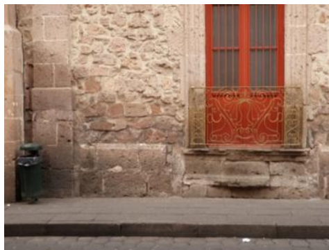
Fig. 46. Detalle de la fachada principal donde se observan los problemas de humedad presentes en gran parte del inmueble. Foto: Eder García.
