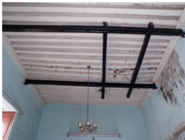
Fig. 52. Imagen del estado actual de la cubierta en la habitación suroeste, el caso más crítico de problemas en este tipo de elementos donde la colocación de refuerzos metálicos fue necesaria para evitar el colapso. Foto: Eder García.
