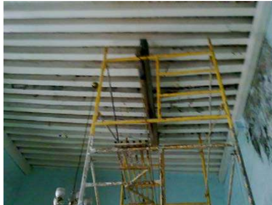
Fig. 29 Parte de los trabajos que se estaban realizando durante las primeras visitas a la casa, el andamio sostenía unas vigas que se había podrido y amenazaban con un posible colapso de la cubierta. Foto: Elvia Gutiérrez.
