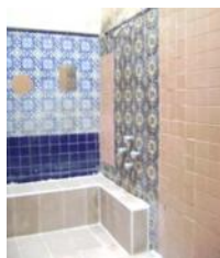
Fig. 53. Imagen de alteraciones en cuanto al sistema constructivo en uno de los baños, colocación de azulejo en muros y vitropiso. Foto: Eder García.
