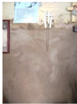
Fig. 50. Detalle del interior de una recamara donde se integró aplanado de cemento en muro con problemas de humedad presentes en gran parte del inmueble. Foto: Elvia Gutiérrez.
