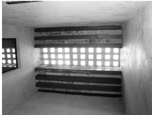
Fig. 45 El sistema principal de cubiertas de la vivienda es mediante viguería de madera, tapa de ladrillo y terrado, sin embargo en algunos casos el sistema ha sido alterado para la inclusión de domos o vitrobloc para iluminar los espacios creados en una etapa más contemporánea. Foto: Eder García.
