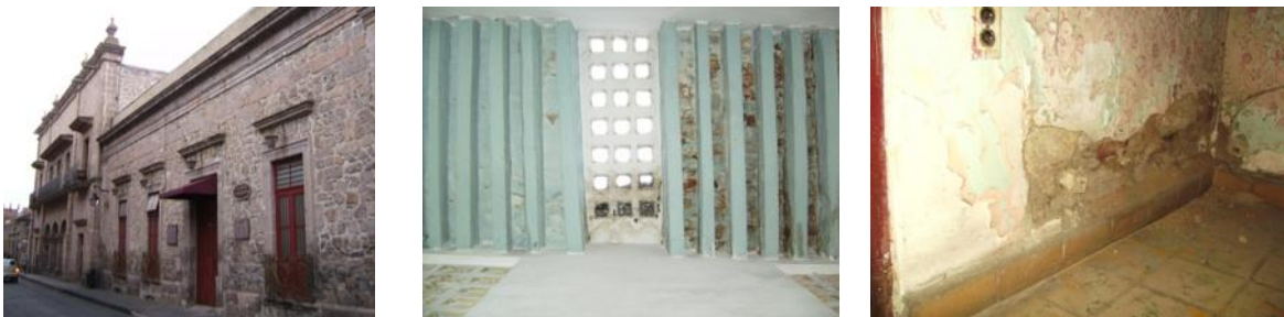
Fig. 34 Fotografías muestran algunas de las aplicaciones del levantamiento fotográfico, contexto inmediato (izquierda), sistema constructivo cubierta (centro) y deterioro (derecha). Fotos: Elvia Gutiérrez.
