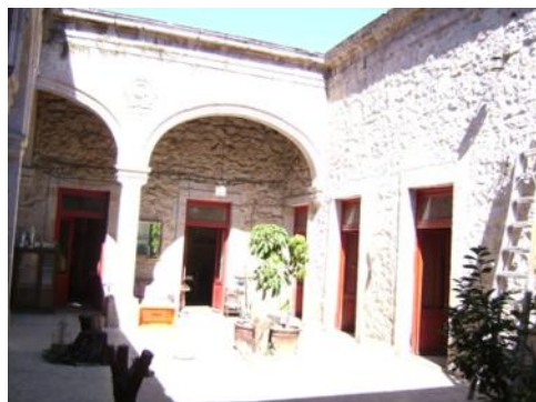
Fig. 49. Detalle del interior en el patio central donde los muros sin aplanado están expuestos a la intemperie. Foto: Elvia Gutiérrez.
