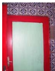
Fig. 48. Detalle de uno de los vanos para puerta de herrería en un baño como adecuación posterior. Foto: Elvia Gutiérrez.
