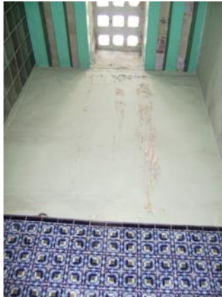
Fig. 51. Detalle del interior de un baño donde se alteró el sistema constructivo con materiales contemporáneos como el vitrobloc para iluminación del espacio. Foto: Elvia Gutiérrez.
