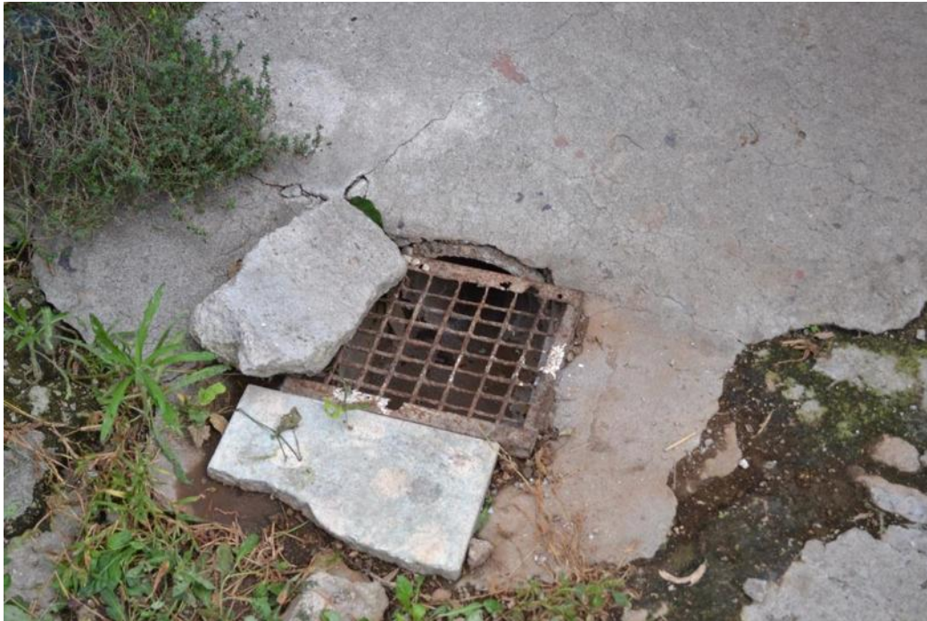
Fotografía 24: Vista parcial de las instalaciones sanitarias en el patio. Autor: Andoni Quezada M.
