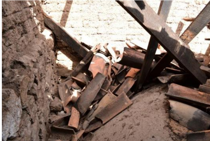
Fotografía 52: Vista desde el interior del colapso de la techumbre. Autor: Andoni Quezada M.
