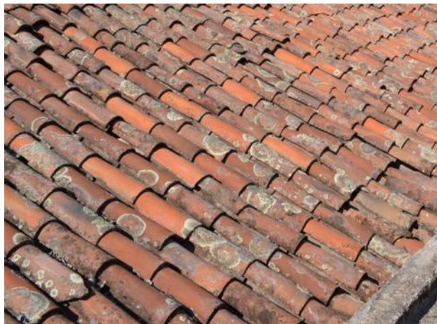
Fotografía 54: Vista del crecimiento de flora nociva en la teja. Autor: Andoni Quezada M.
