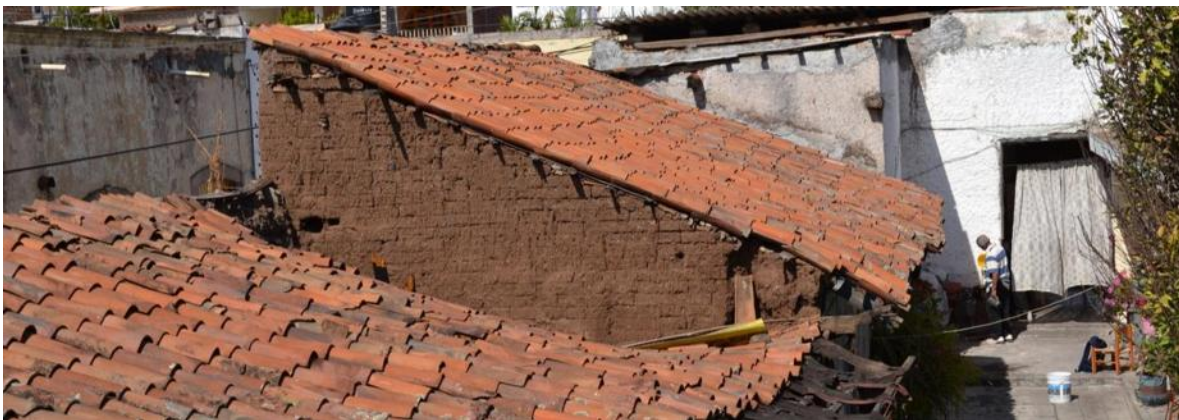
Fotografía 51: El hueco que se observa en el límite con el muro de mayor tamaño corresponde al colapso sufrido en la cubierta.
