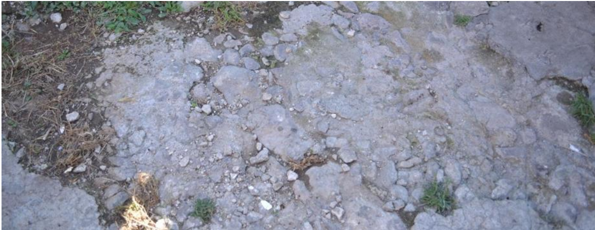
Fotografía 57: Detalle del deterioro en los pisos sufrido en algunas secciones del patio.
