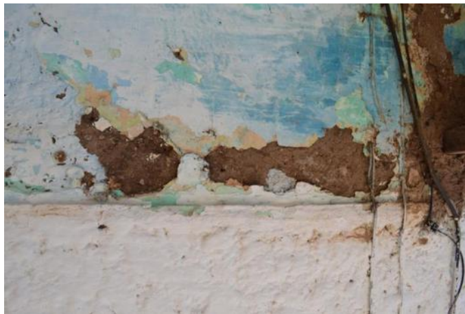
Fotografía 50: Desprendimiento de enlucido.
