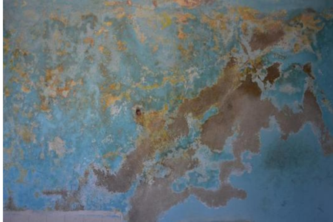
Fotografía 55: Vista del muro sur del baño que presenta problemas serios de humedad. Autor: Andoni Quezada M.
