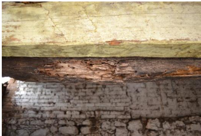
Fotografía 53: Apolillamiento en viga madrina en la nave del antiguo horno de pan. Autor: Andoni Quezada M.
