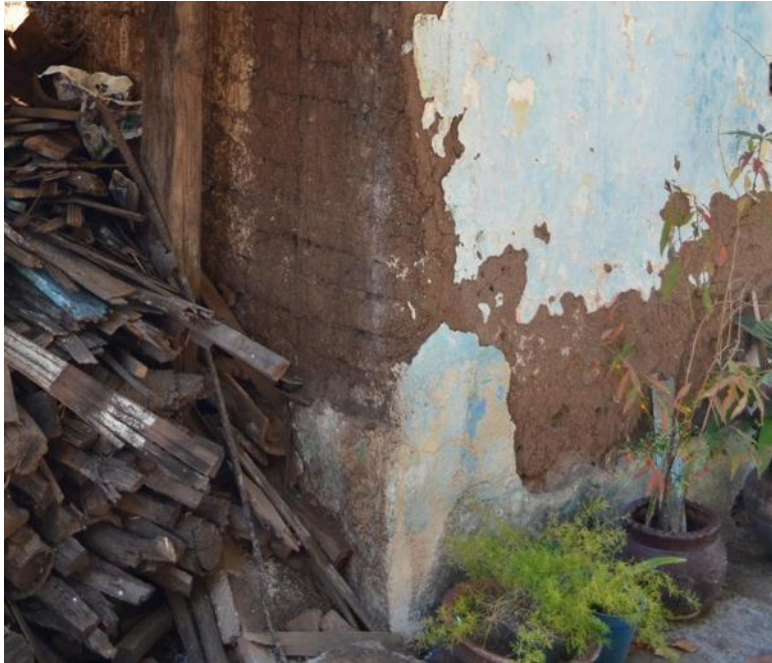
Fotografía 63: Vista del desprendimiento del enlucido en el muro correspondiente a la actual panadería. Autor: Andoni Quezada M.
