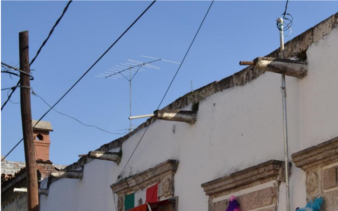
Fotografía 59: Vista de los desplomes en el paramento de la fachada principal. Autor: Andoni Quezada M.
