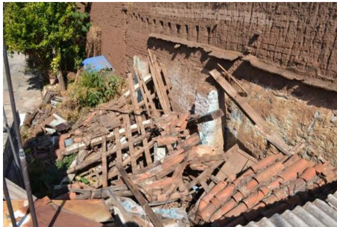
Fotografía 56: Vista aérea de la cubierta colapsada de los antiguos baños. Autor: Andoni Quezada M.
