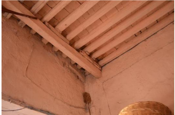
Fotografía 33: Vista parcial de la cubierta y muros en la tienda. Autor: Andoni Quezada M.
