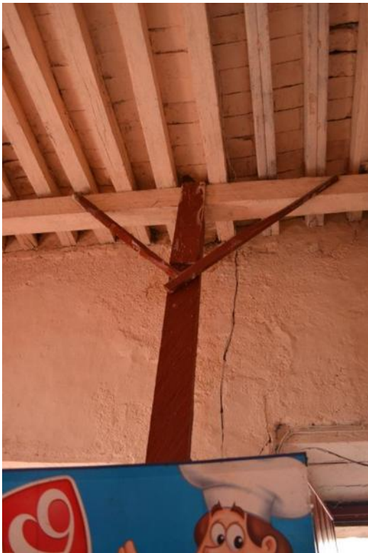
Fotografía 32: Vista del puntal que refuerza la madrina en el área de la tienda. Autor: Andoni Quezada M.
