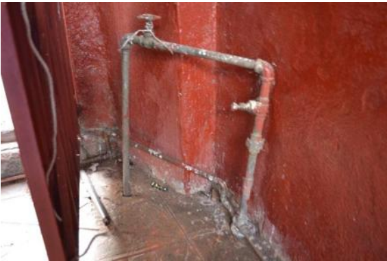
Fotografía 109: Vista de la llave que conecta con la toma domiciliaria.
