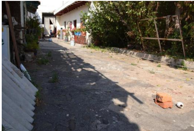
Fotografía 20: Tendido de hilo de albañilería para la definición de los puntos necesarios para el trazado de los ejes. Autor; Andoni Quezada M.
