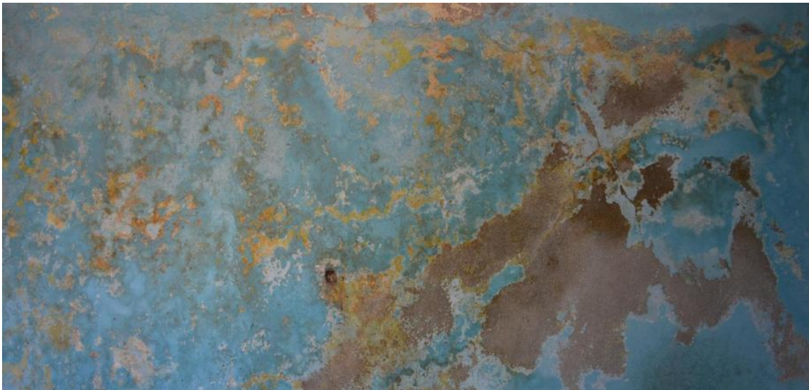
Fotografía 62: Vista de los deterioros sufridos en el muro sur de la vivienda. Autor: Andoni Quezada M.
