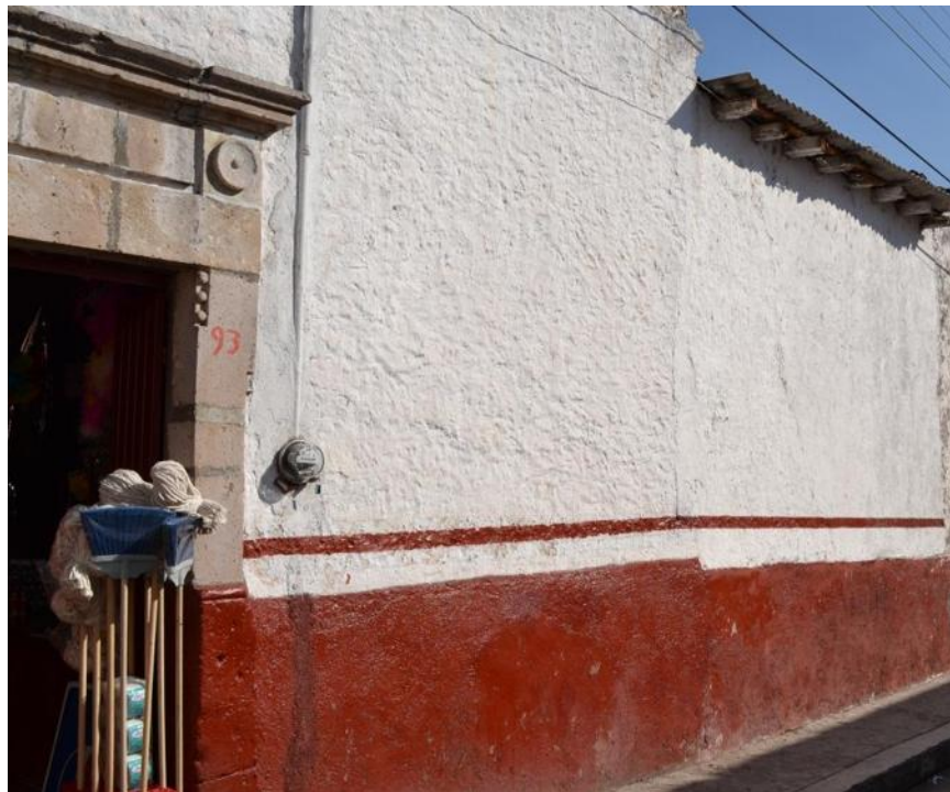
Fotografía 60: Vista del paramento de la fachada lateral y el estado de conservación que prevalece. Autor: Andoni Quezada M.
