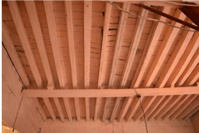
Fotografía 49: Desplazamiento de los largueros que provocó un desajuste en la tapa que contiene el terrado.
