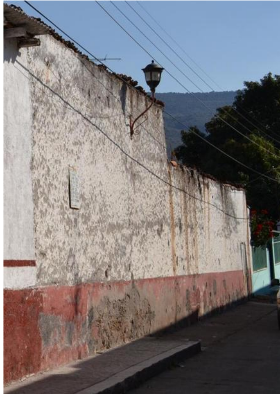
Fotografía 61: Vista del estado de conservación que presenta el paramento en su siguiente sección. Obsérvese el desprendimiento mayoritariamente sucedido en la parte inferior del mismo. Autor: Andoni Quezada M.
