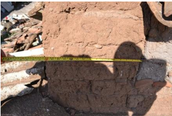
Fotografía 93: Vista de un muro cuyo aparejo está conformado por sillares de adobe al máximo discontinuo.
