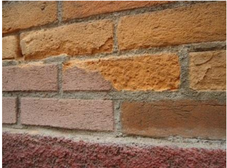
Imagen 104.- Detalle de disgregación de material en fachada principal . Fuente: Arq. E. Gabriela Rodríguez Romero
