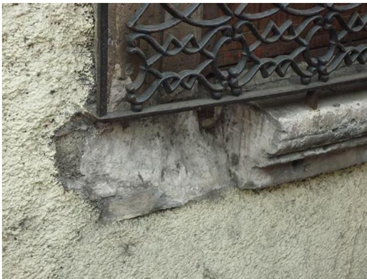
Imagen 105.- Detalle de pérdida de sección de repisones de la fachada principal. Fuente: Arq. E. Gabriela Rodríguez Romero
