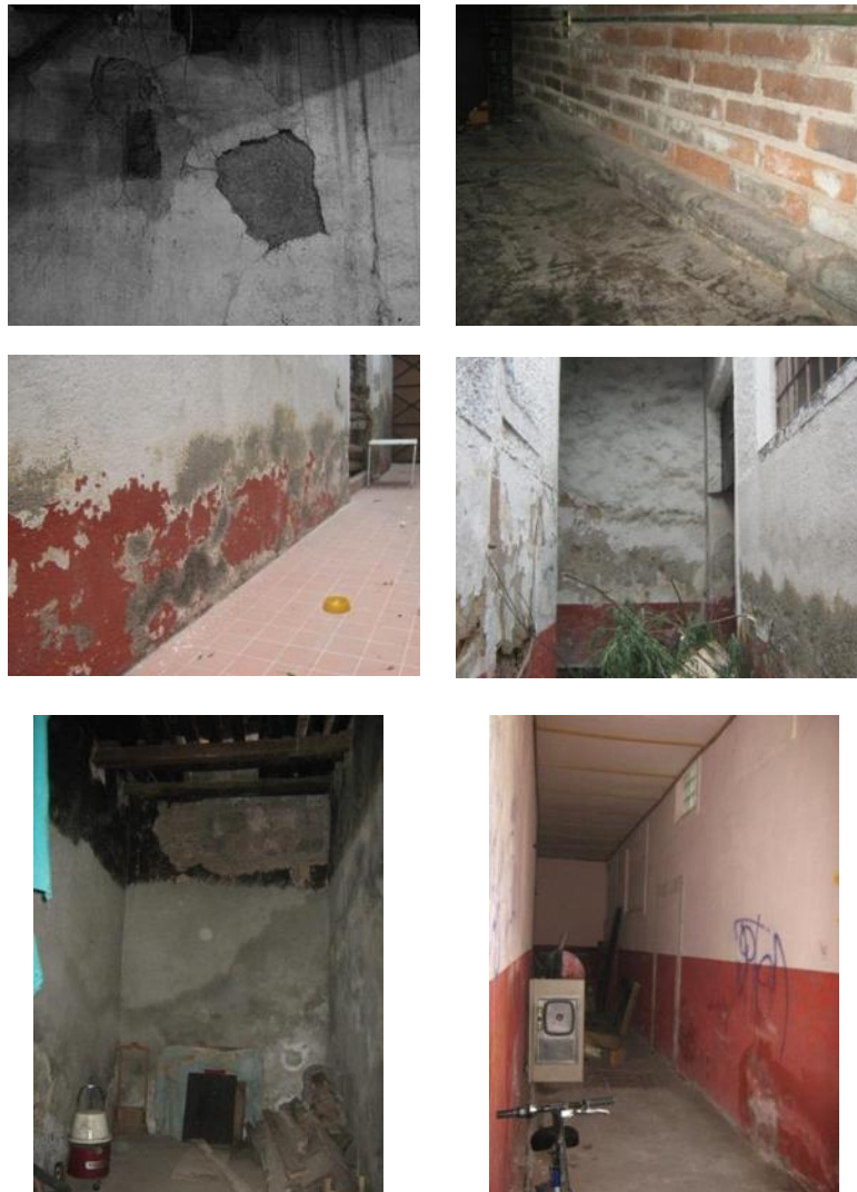
Imágenes 76, 77, 78, 79, 80, 81. Humedad por capilaridad en muros. Fuente: ABG.
