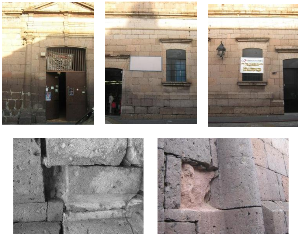
Imágenes 71, 72, 73, 74, 75. Humedad por capilaridad en muros. Fuente: ABG.
