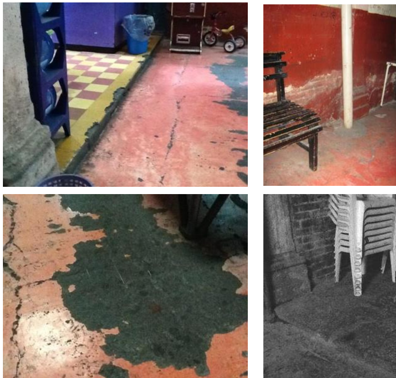
Imágenes 39, 40, 41, 42. Pisos en el patio principal y vestigios de presencia de baldosa de cantería en lo que era el corredor norte del patio. Fuente: ABG.
