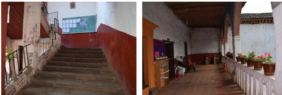
Imagen 45 y 46. Desgaste en pisos y alteraciones en intervenciones mal ejecutadas (cambio de material) Fotos: Perdomo/Tello Marzo 2015
