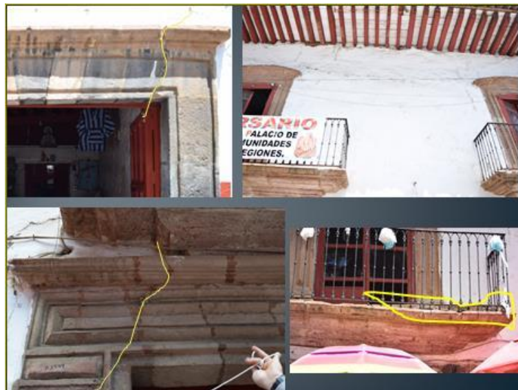
Imagen 19. Fotos de grietas en fachada. Foto: Perdomo/Tello, Marzo 2015
