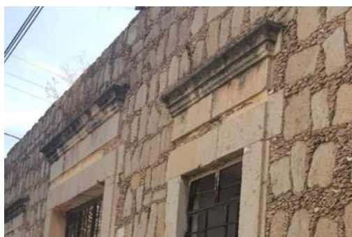
Fachada por la calle Juan Ruíz de Alarcón en donde se aprecian restos de aplanados entre el marco de las ventanas y puerta con la cornisa que remata. Imagen tomada por MECH.
