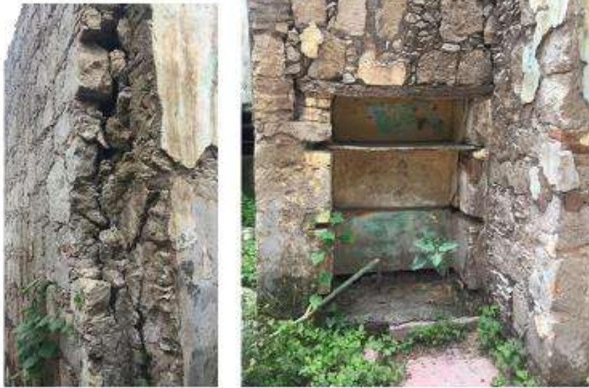
Evidentes grietas en muros
