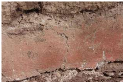
IM-13 Restos de aplanados (muro sur)
